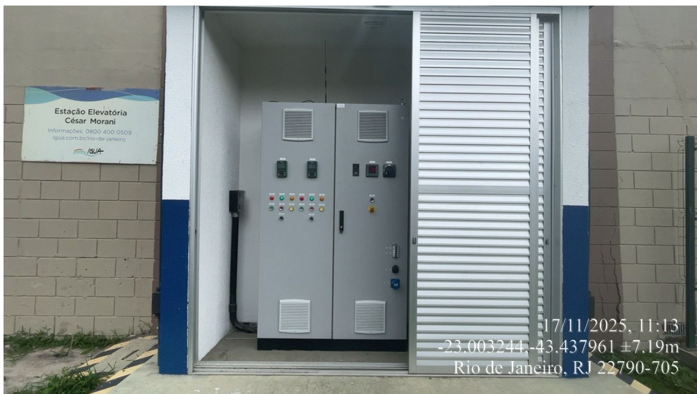
Foto 3 – Paineis elétricos da EEEB
