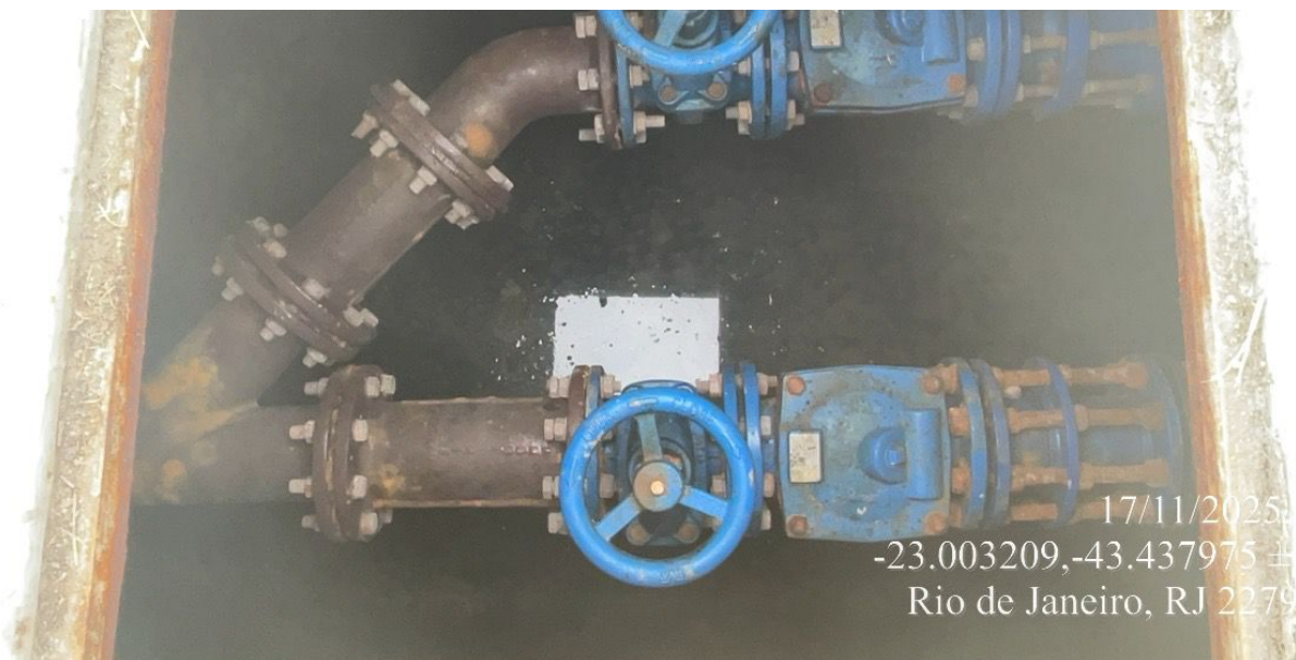
Foto 10 – Tubulações dos conjuntos motobombas providas de válvulas de retenção e fechamento
