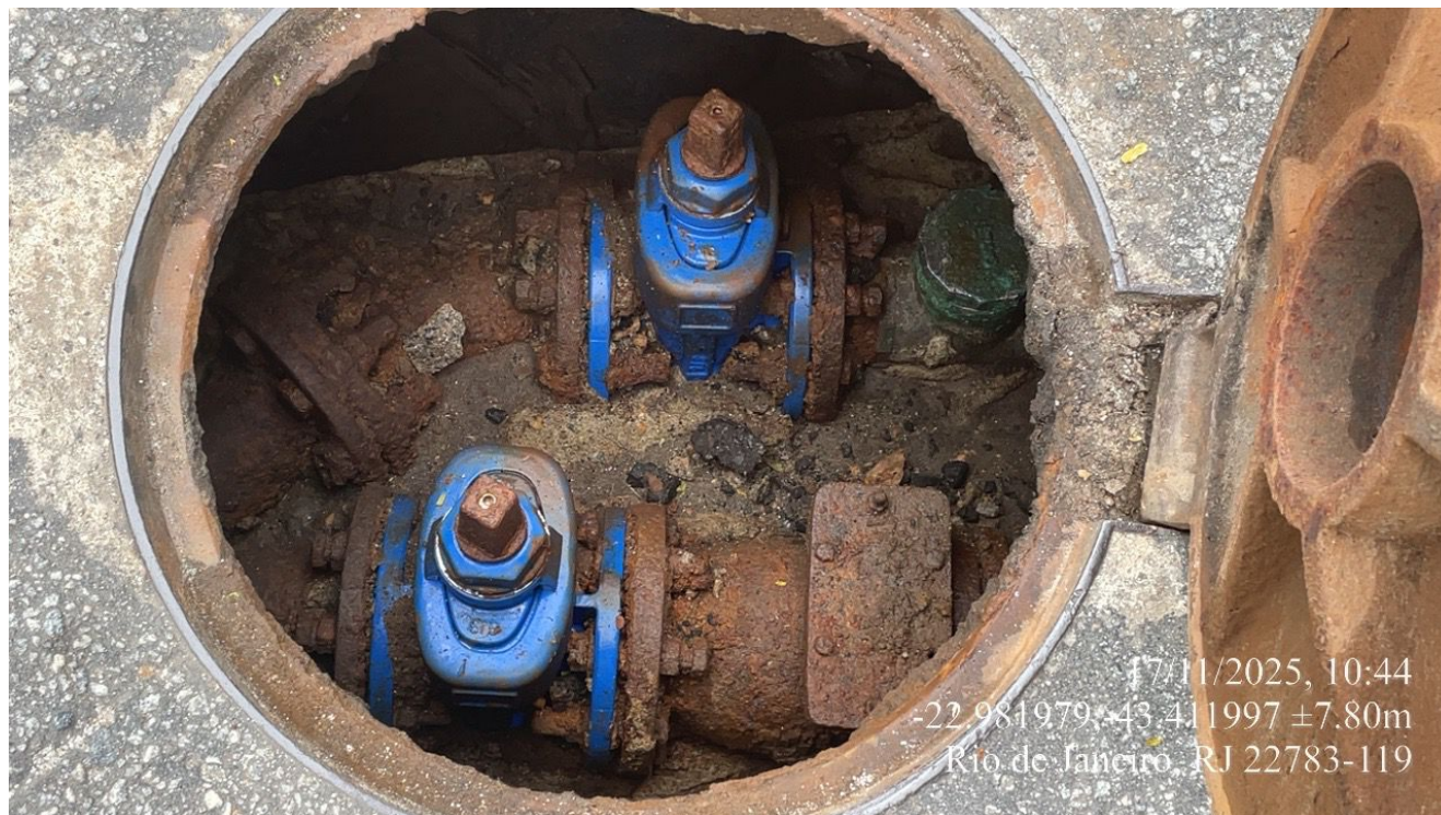
Foto 7 – Tubulações dos conjuntos motobombas providas de válvulas de retenção e fechamento
