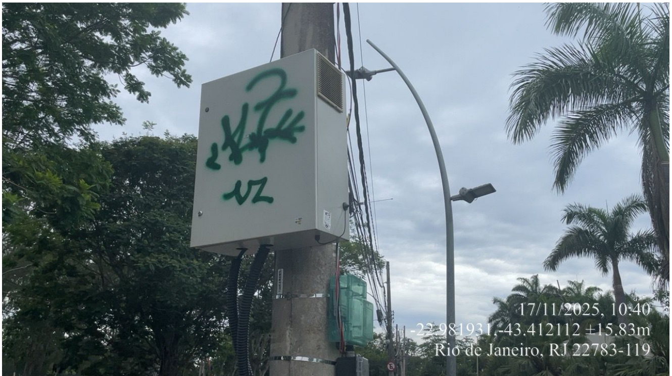
Foto 2 – Painel elétrico da EEEB
