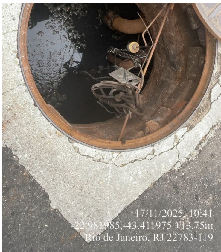
Foto 5 – Poço da bomba
