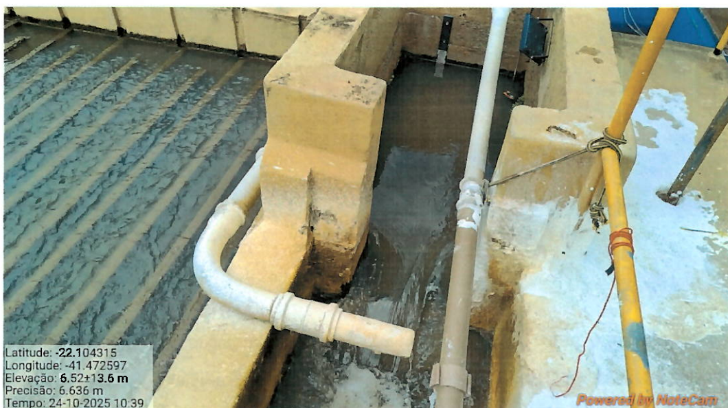
Foto 5: Entrada de água bruta na VETA com aplicação de coagulante sulfato de alumínio.
