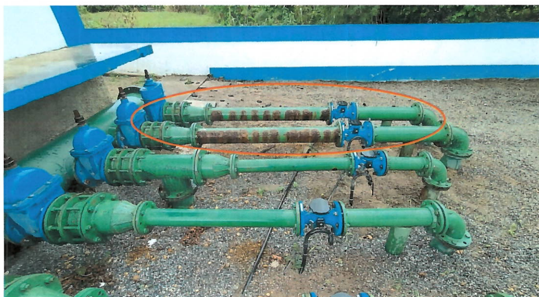
Foto 27: Adutoras DN 150 com sinais de corrosão.
