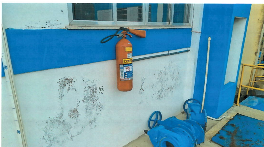
Foto 3: Extintor de incêndio
