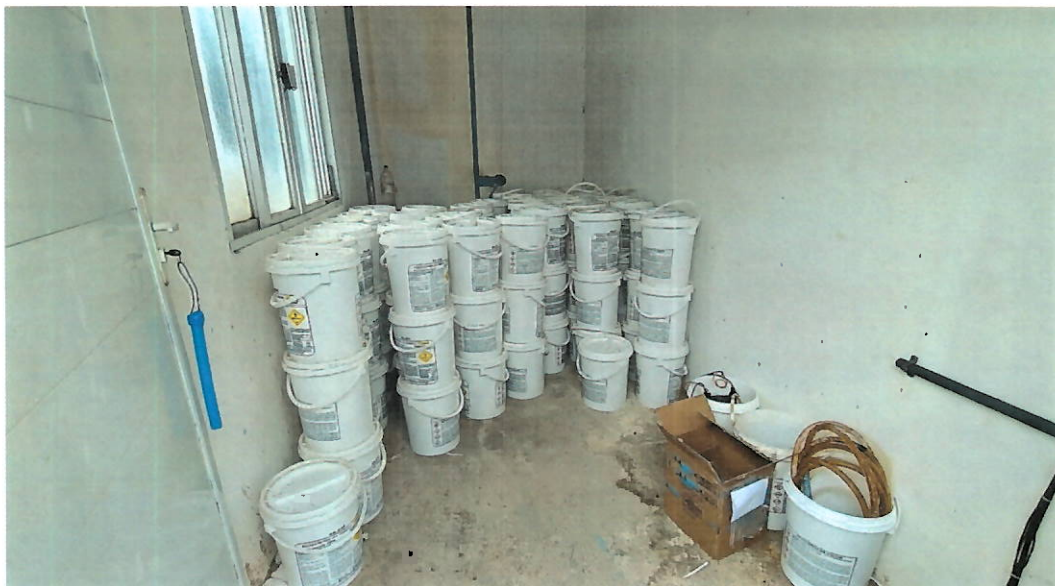
Foto 23: armazenamento de hipoclorito de cálcio.
