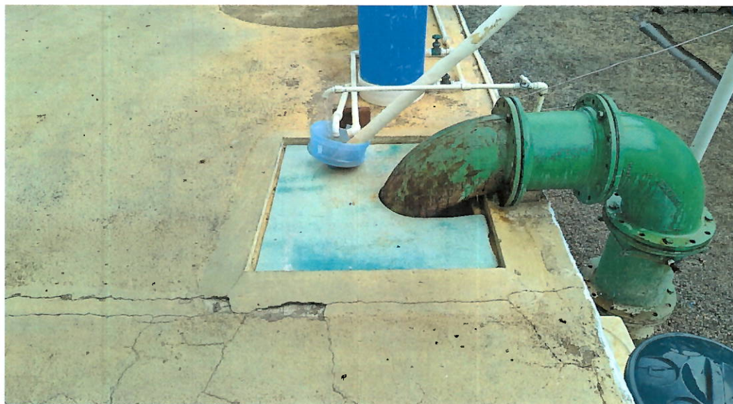
Foto 14: Tampa improvisada sobre tanque de contato .
