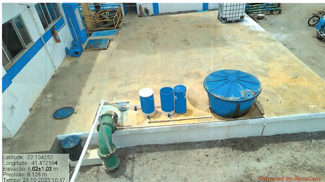
Foto 13: Tanque de contato com sistema de desinfecção.
