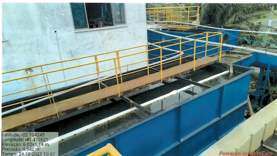
Foto 11: Decantadores da NETA.
