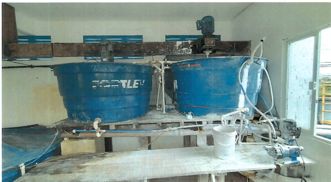
Foto 20: Tanque de armazenamento de água para diluição de cal na forma líquida.
