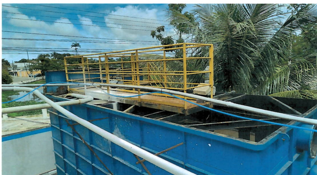
Foto 9: Floculadores da NETA (mecânico)
