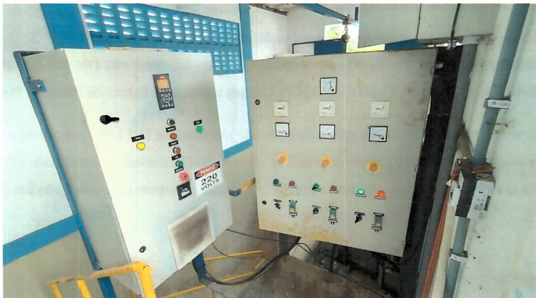
Foto 26: Painéis elétricos das motobombas.
