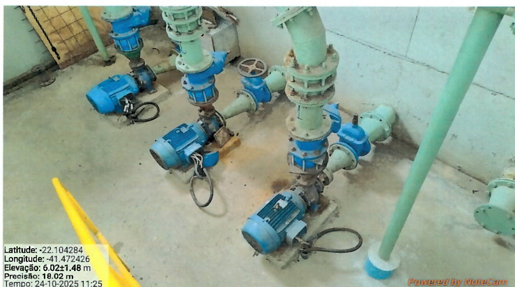
Foto 25: Conjuntos motobombas (potência de 25 cv cada).
