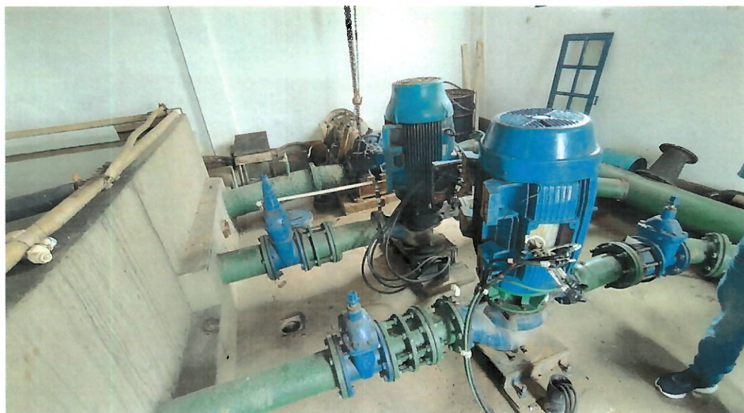
Foto 4: Conjuntos motobombas de 100 cv cada (1 em operação e 2 reservas).
