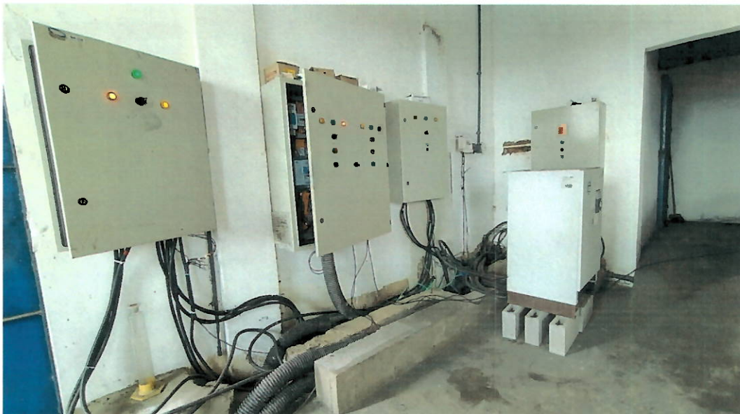
Foto 5: Painéis elétricos dos conjuntos motobombas.
