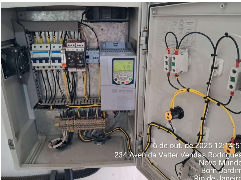
Foto 11 – Painel de automação
