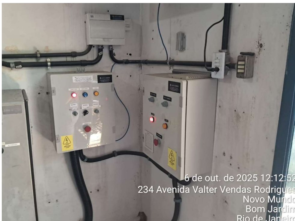
Foto 10 – Paineis de automação
