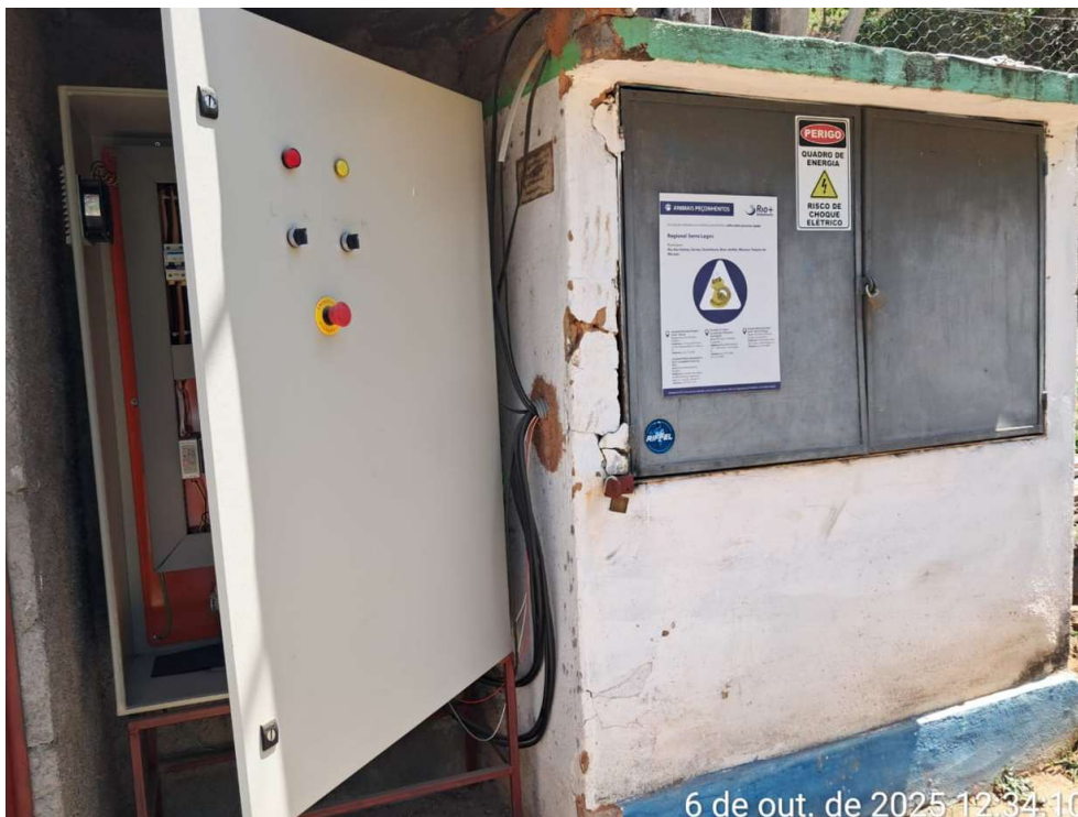
Foto 5 – PAINEL DE AUTOMAÇÃO
