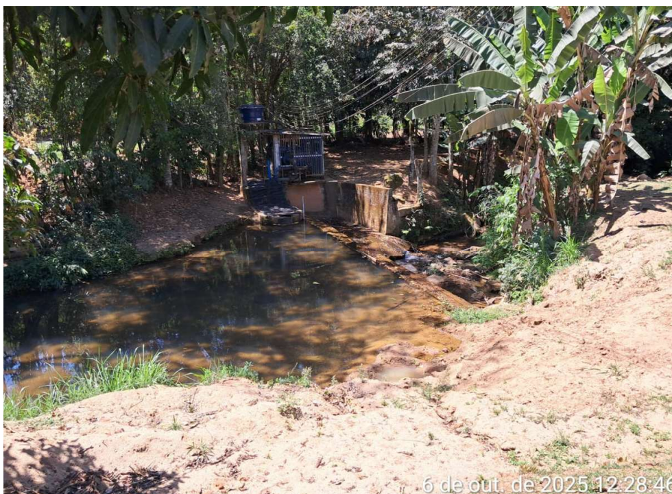
Foto 2 – Barragem de nível
