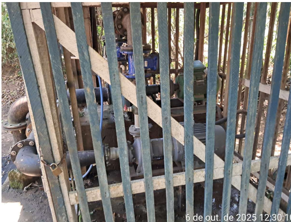
Foto 3 – Conjuntos motobombas instalados na captação
