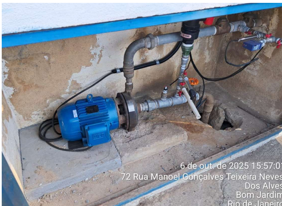
Foto 24 – Conjunto motobomba instalado
