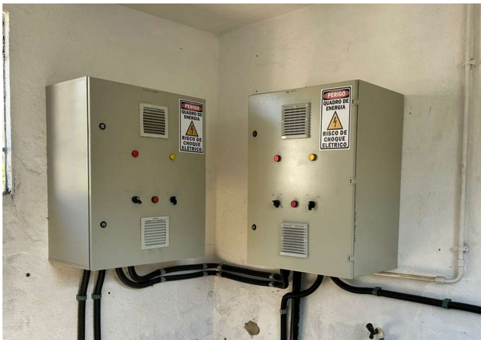
Foto 21 – Paineis de automação
