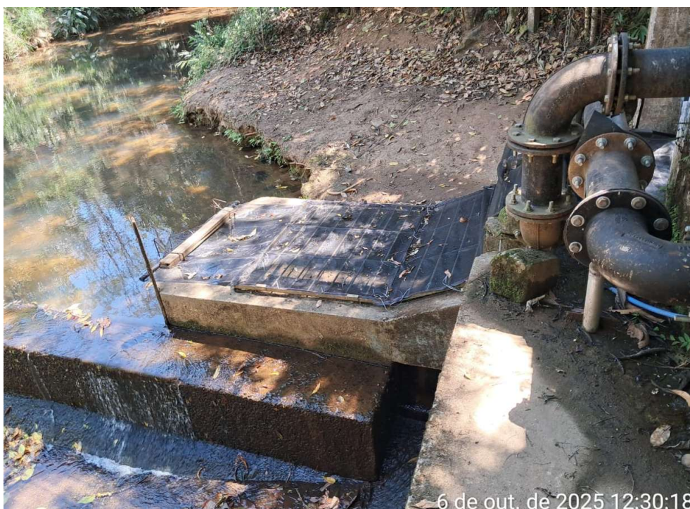
Foto 4 – Poço de bombeamento da água bruta com tela de proteção
