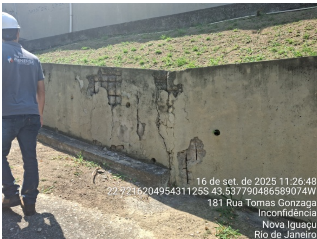
Foto 2: Parede de talude com armadura exposta
