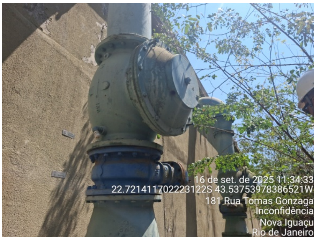
Foto 6: Tubulação de chegada
