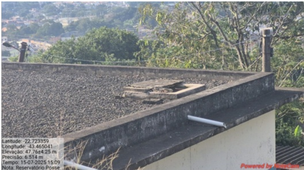
Foto 11: Visita com tampa de concreto quebrada
