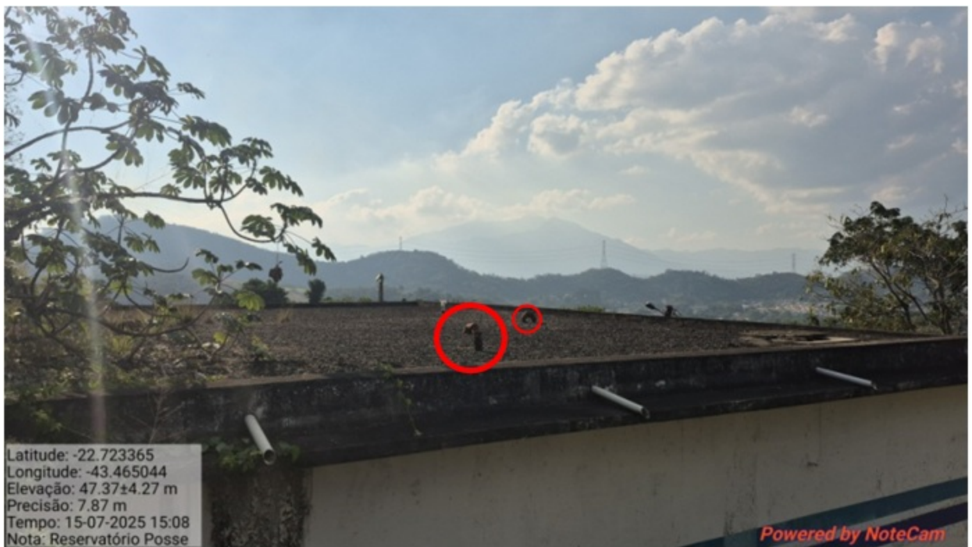
Foto 10: Laje reservatório (Destaque tubulações suspiros oxidadas)
