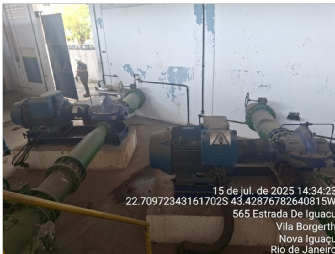
Foto 3 – Barrilete do booster e conjuntos motobombas
