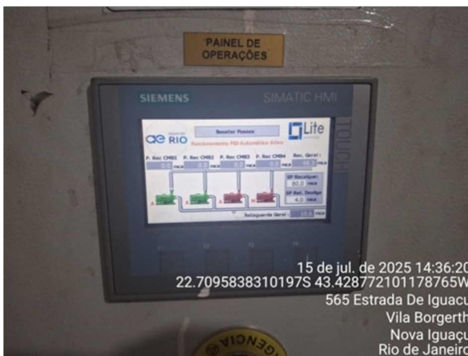
Foto 9 – Visor painel de controle
