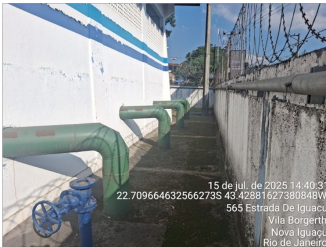
Foto 4 – Saída tubulações de recalque
