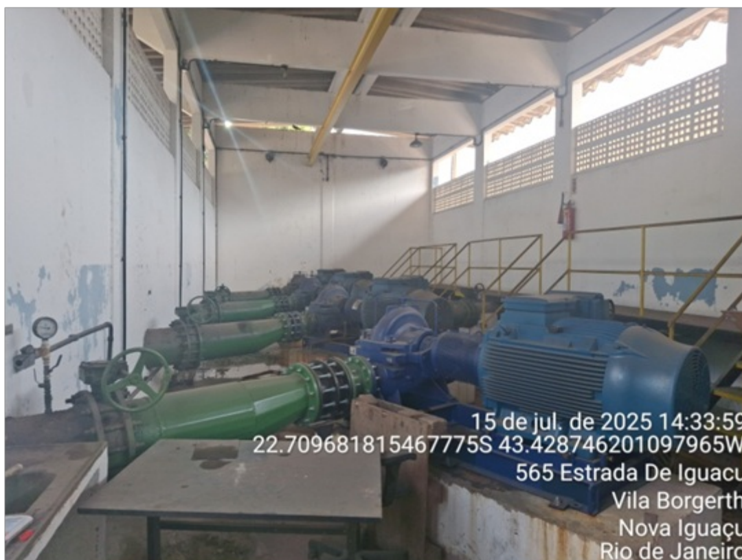
Foto 2 – Barrilete do booster e conjuntos motobombas
