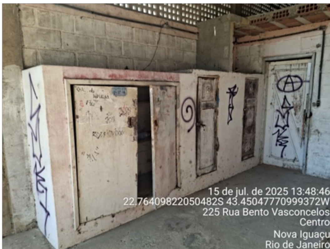
Foto 6 –Abrigo para painéis
