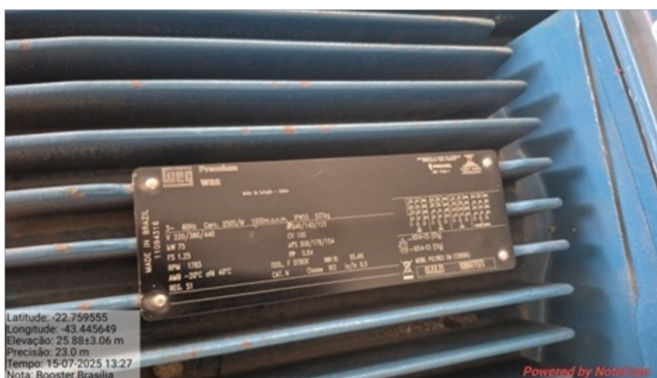
Foto 10 – Placa da bomba
