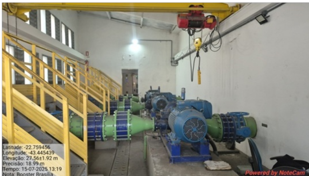
Foto 2 – Barrilete do booster e conjuntos motobombas
