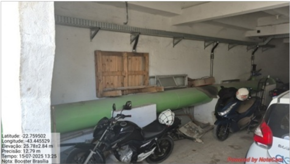
Foto 11 – Objetos em cima da tubulação
