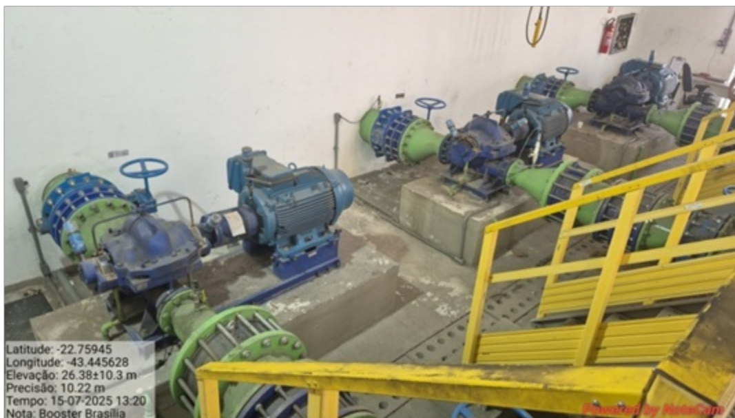
Foto 3 – Barrilete do booster e conjuntos motobombas
