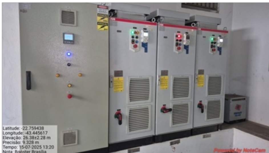
Foto 5 – Painéis de controle e automação
