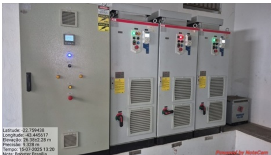
Foto 6 – Inversores de frequência
