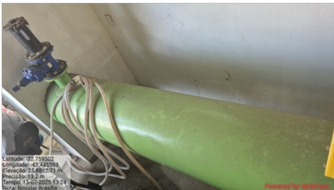
Foto 4 – Saída tubulações de recalque
