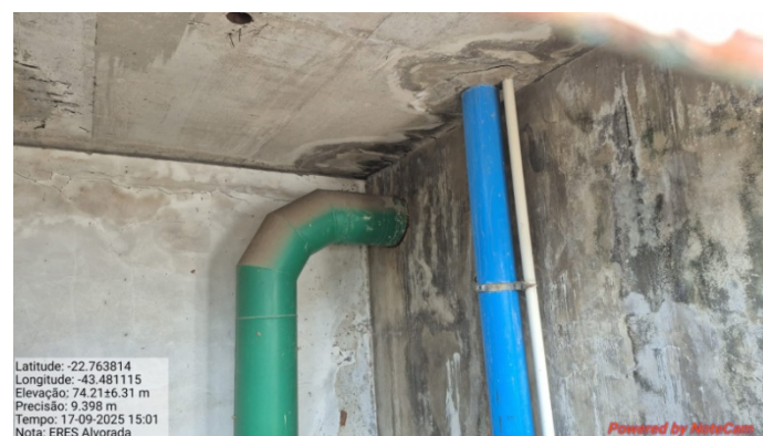
Foto 6 – Barrilete e válvulas
