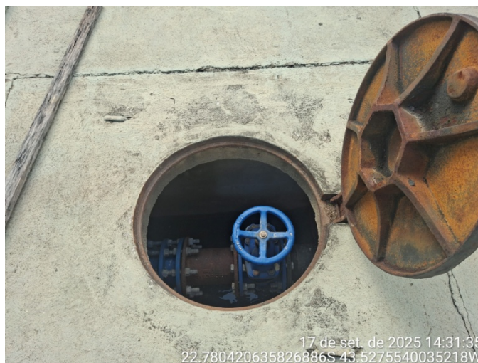
Foto 6 – Válvula da distribuição
