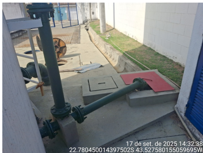
Foto 3 – Tubulação de chegada
