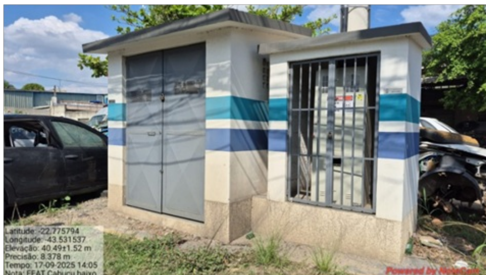
Foto 1 – Abrigo dos painéis de comando, telemetria e elétrica
