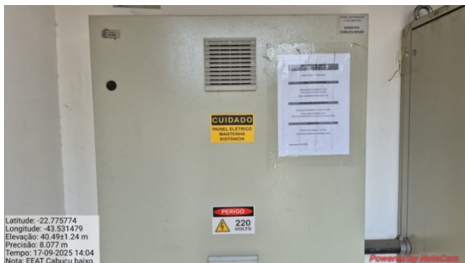
Foto 3 – Pannel de automação e telemetria
