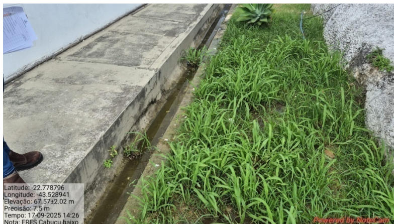
Foto 10 – Vazamento de ramal
