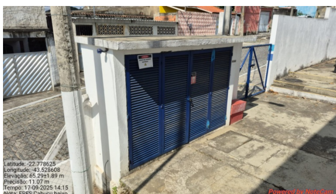
Foto 6 – Abrigo para painéis
