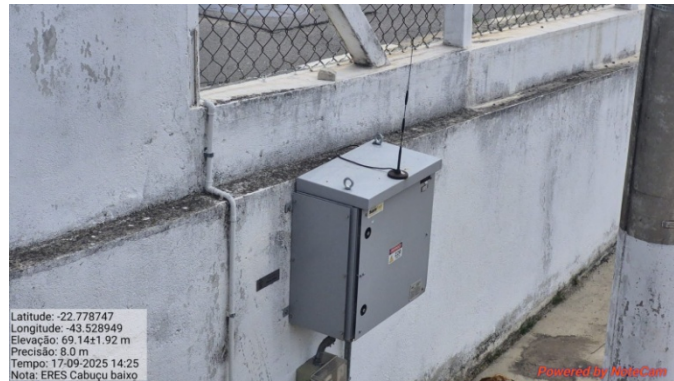
Foto 8 – Pannel de telemetria
