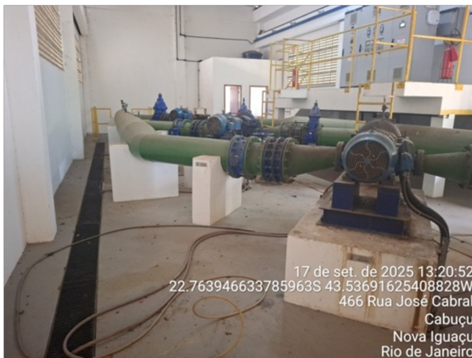
Foto 3 – Barrilete do booster e conjuntos motobombas
