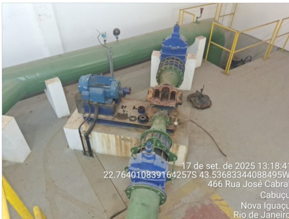
Foto 5 – Conjunto motobomba em manutenção
