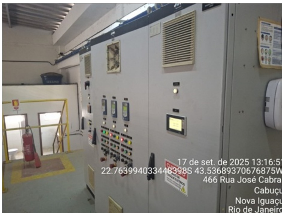
Foto 6 – Painéis de controle e automação
