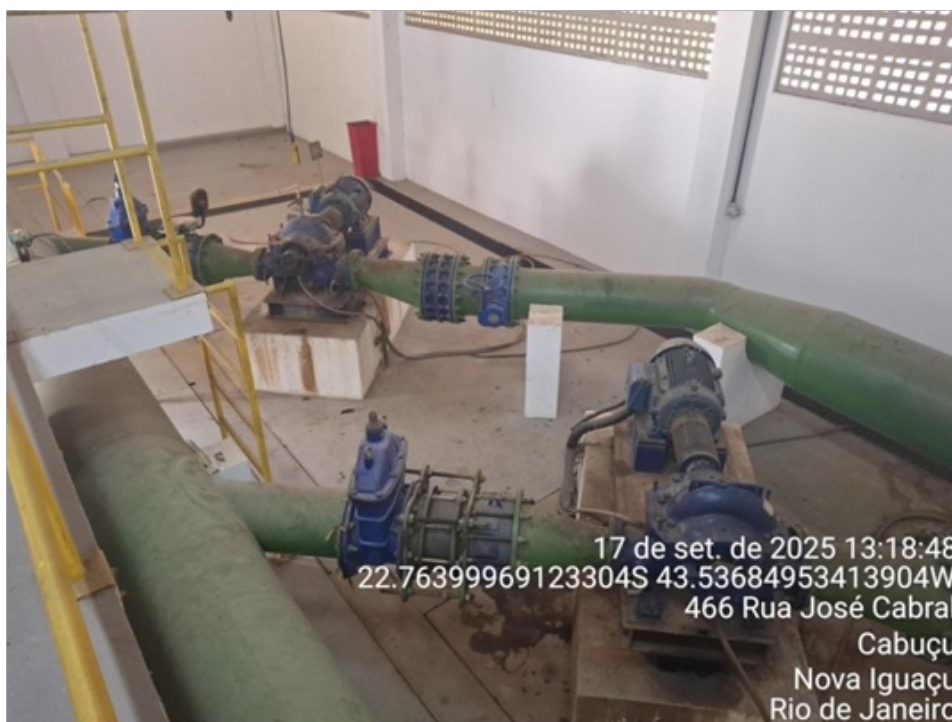
Foto 4 – Barrilete do booster e conjuntos motobombas
