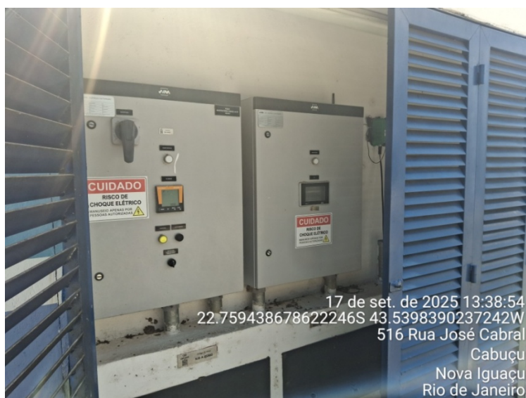
Foto 7 – Painéis de comando
