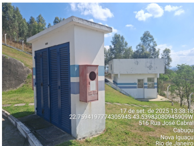
Foto 6 –Abrigo para painéis e edificação operacional
