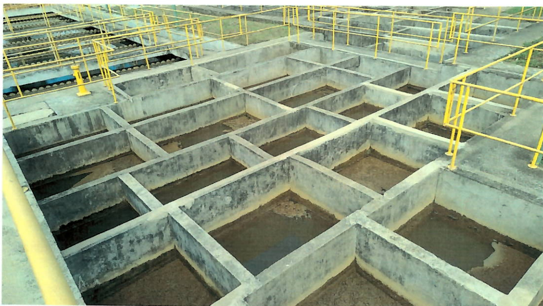
Foto 11: Módulos de floculação da NETA (nota-se reparo realizado nas estruturas de concreto em atendimento a solicitação feita em vistoria anterior).
