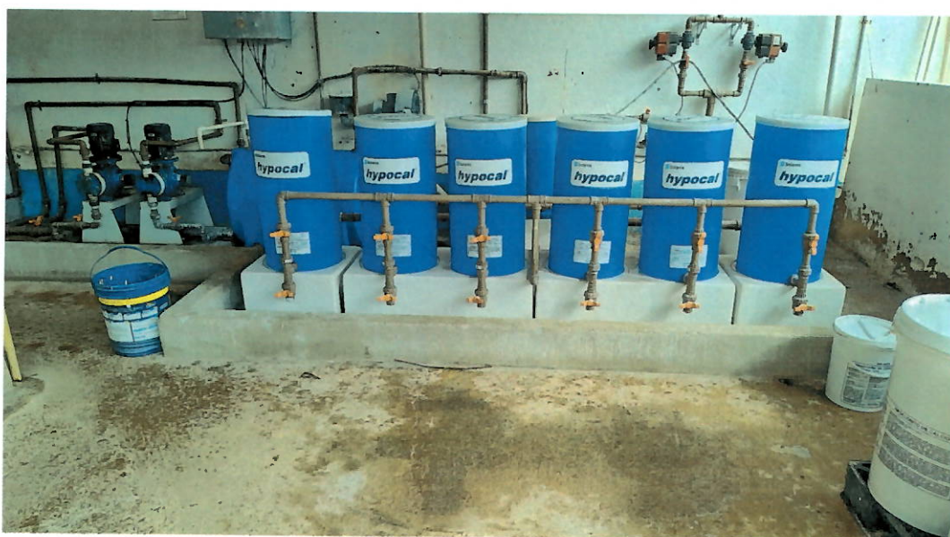
Foto 25: sistema de cloração sobre bacia de contenção.
