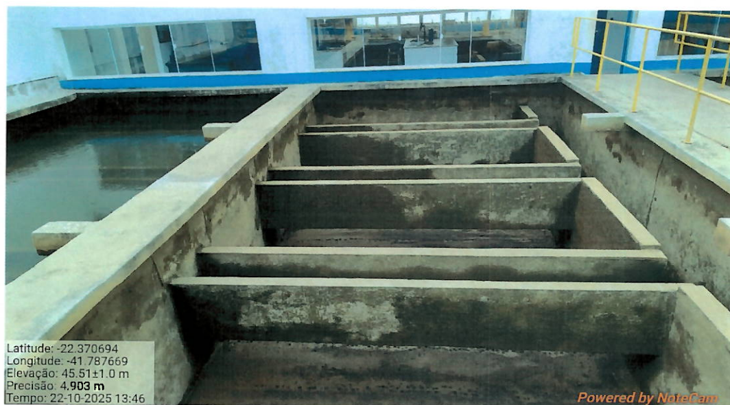
Foto 18: Filtro 2 fora de operação para manutenção.
