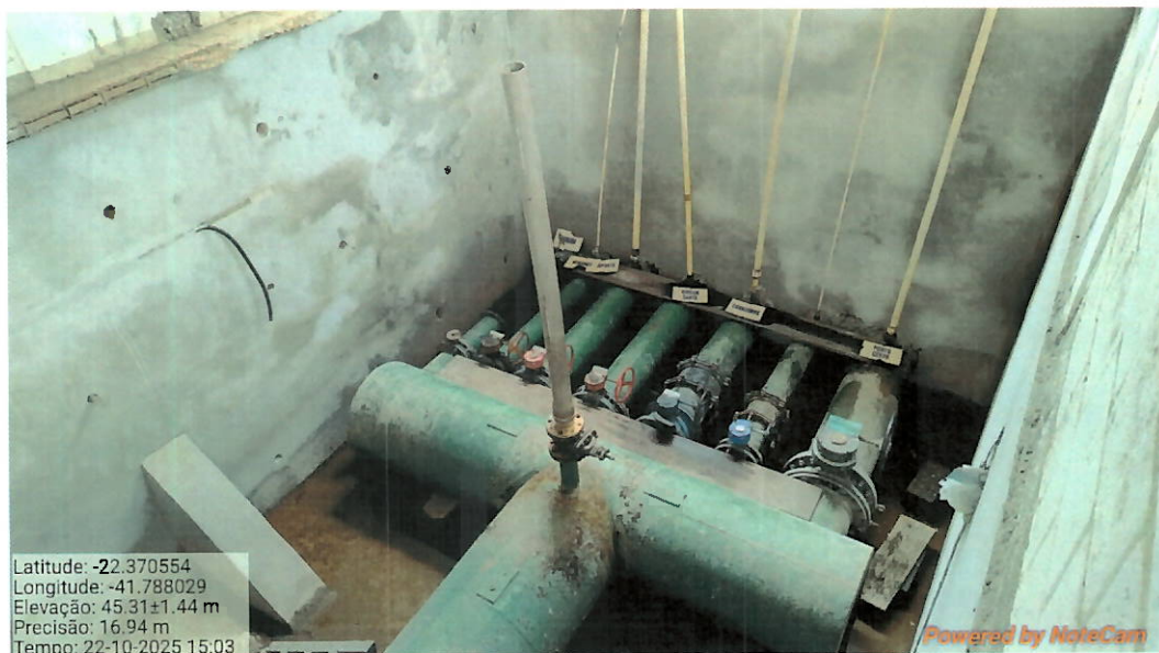
Foto 29: Barilhete de distribuição.
