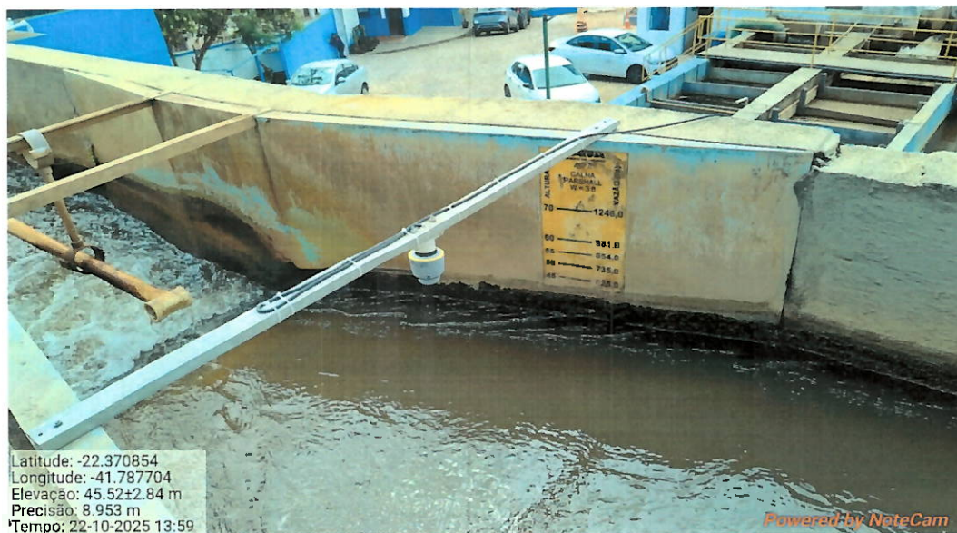
Foto 7: Entrada de água bruta na NETA com ponto de aplicação de coagulante sulfato de alumínio (nota-se a instalação de medidor de vazão automático)
