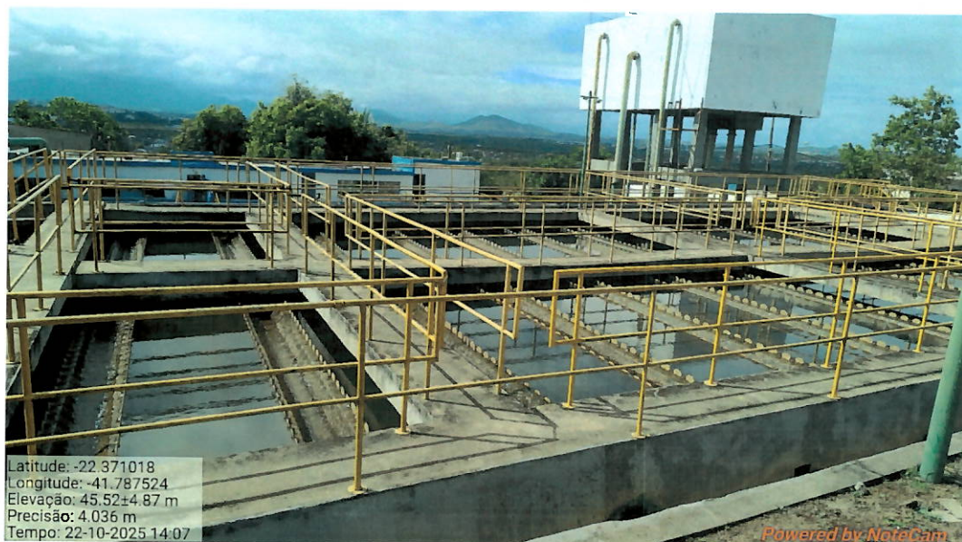
Foto 14: Decantadores da NETA.
