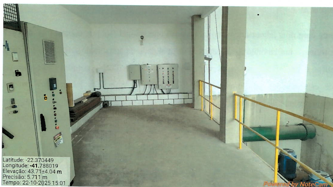
Foto 28: Painéis elétricos dos grupos motobombas.
