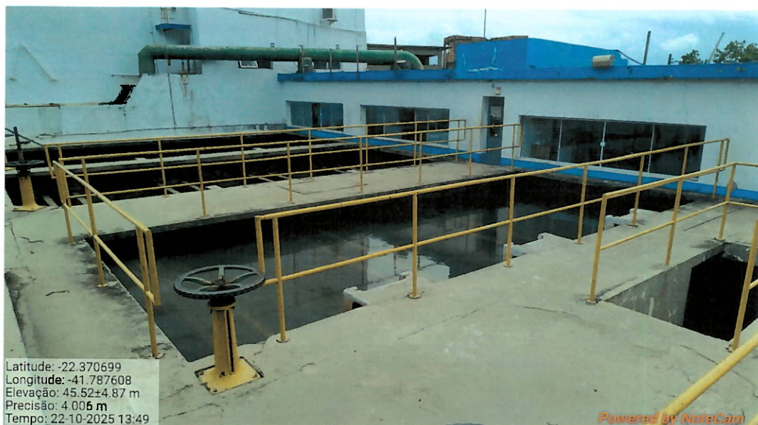
Foto 17: filtros da ETA.
