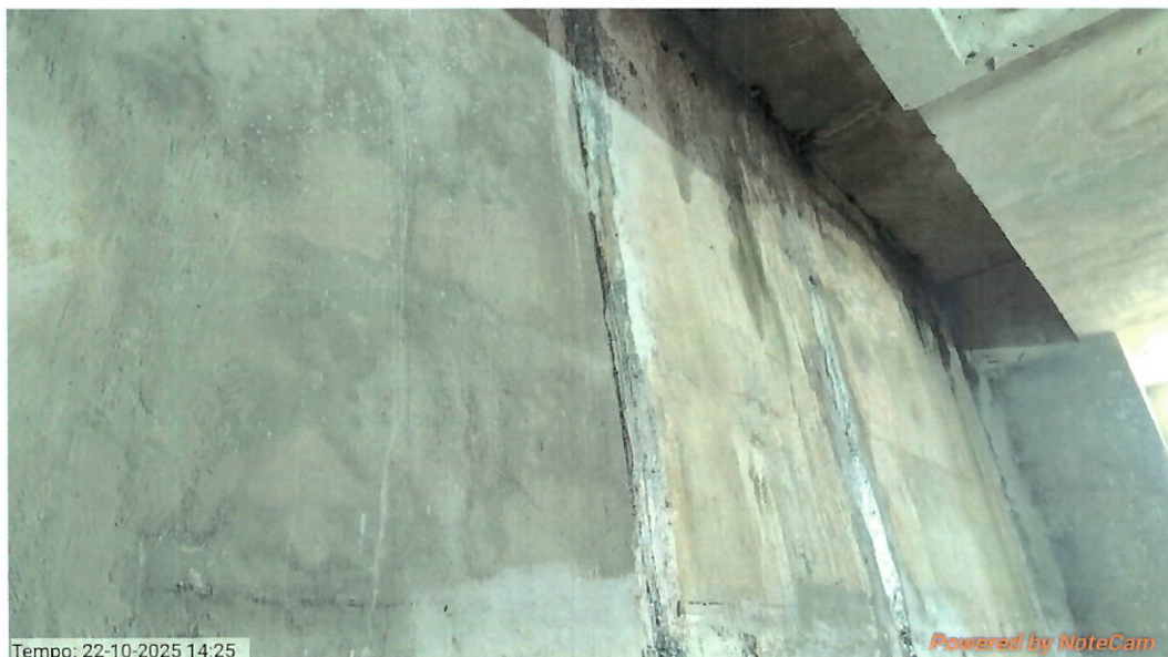
Foto 16: Paredes dos decantadores da NETA (nota-se que a realização de reforma e aparecimento de novos pontos de infiltração)
