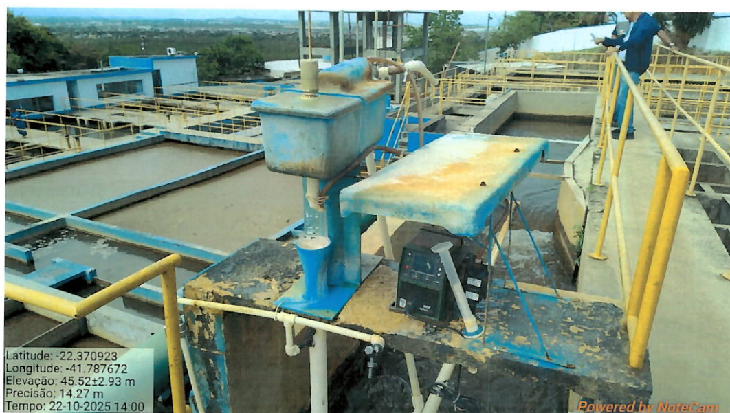
Foto 8: Bomba dosadora de sulfato de alumínio da NETA.
