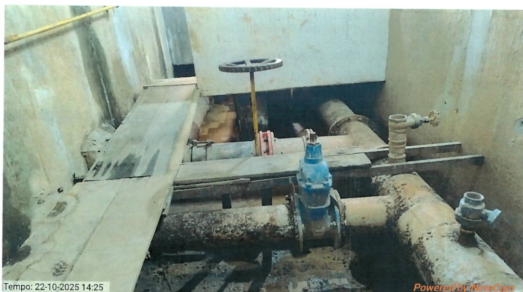
Foto 15: Barrilete de descarga dos decantadores da NETA.
