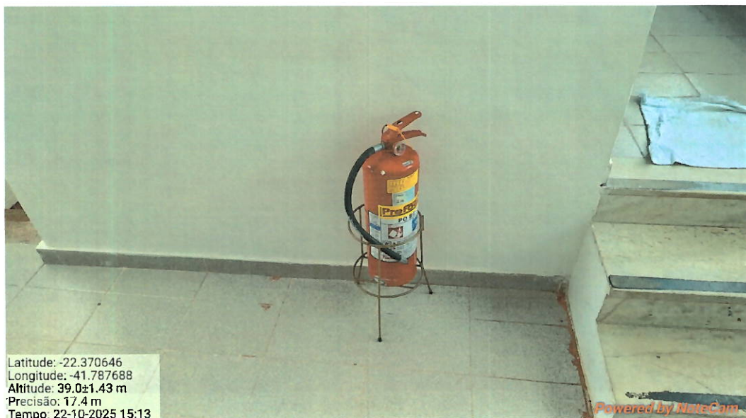
Foto 3: Extintor de incêndio.
