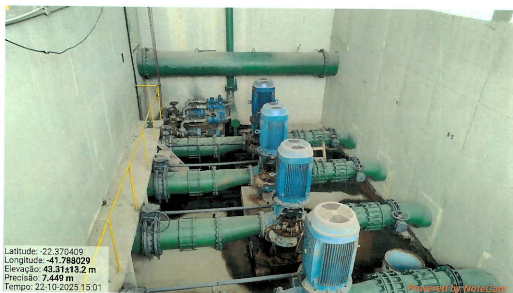
Foto 27: Grupos motobombas da EEAT.
