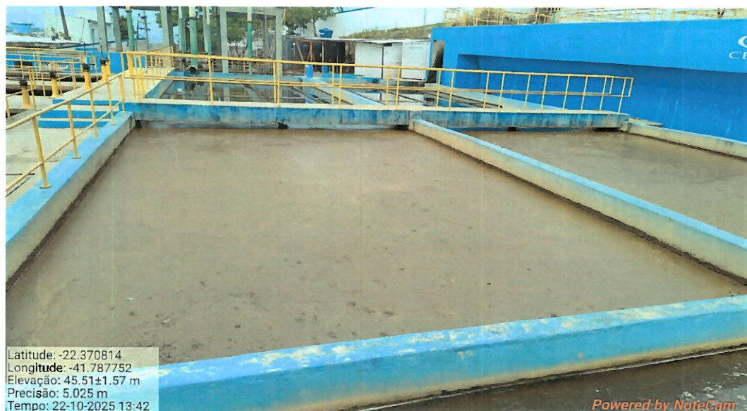
Foto 13: Decantadores da VETA (nota-se a quantidade elevada de lodo formado).
