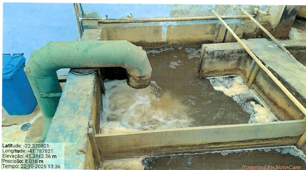
Foto 5: Entrada de água bruta na VETA.
