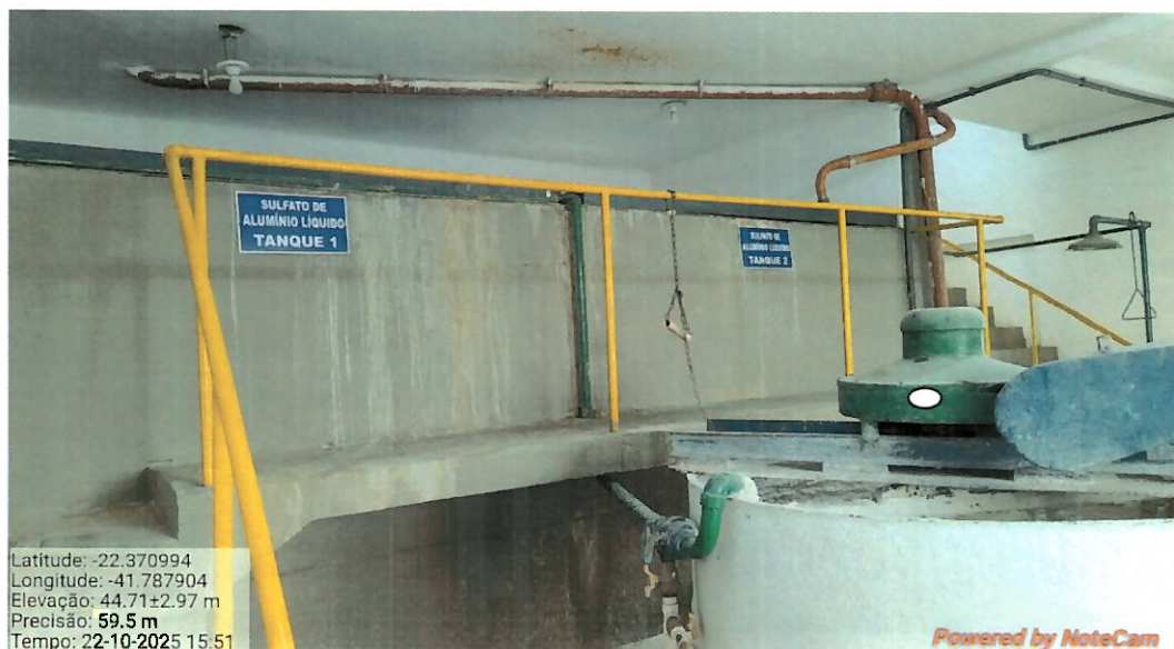
Foto 40: tanques de armazenamento sulfato de alumínio.
