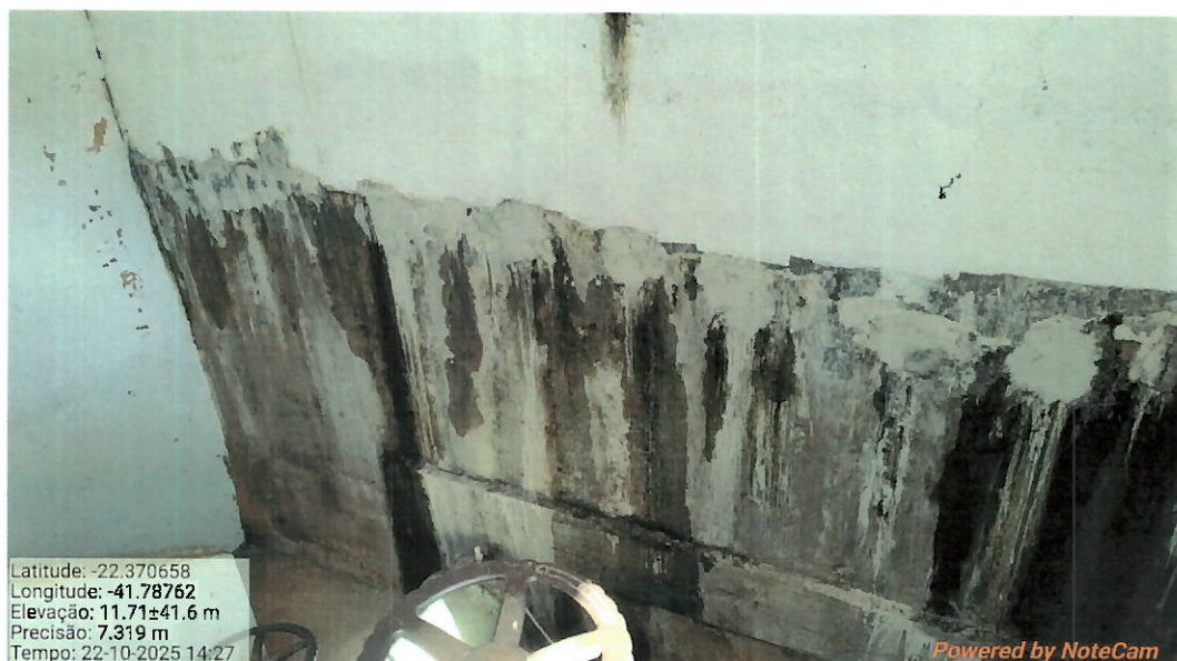
Foto 19: Paredes da casa de válvulas do filtro 6 (nota-se que a realização de reforma e aparecimento de novos pontos de infiltração)
