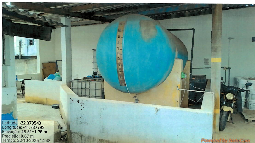
Foto 41: tanques de armazenamento ácido fluossilico.
