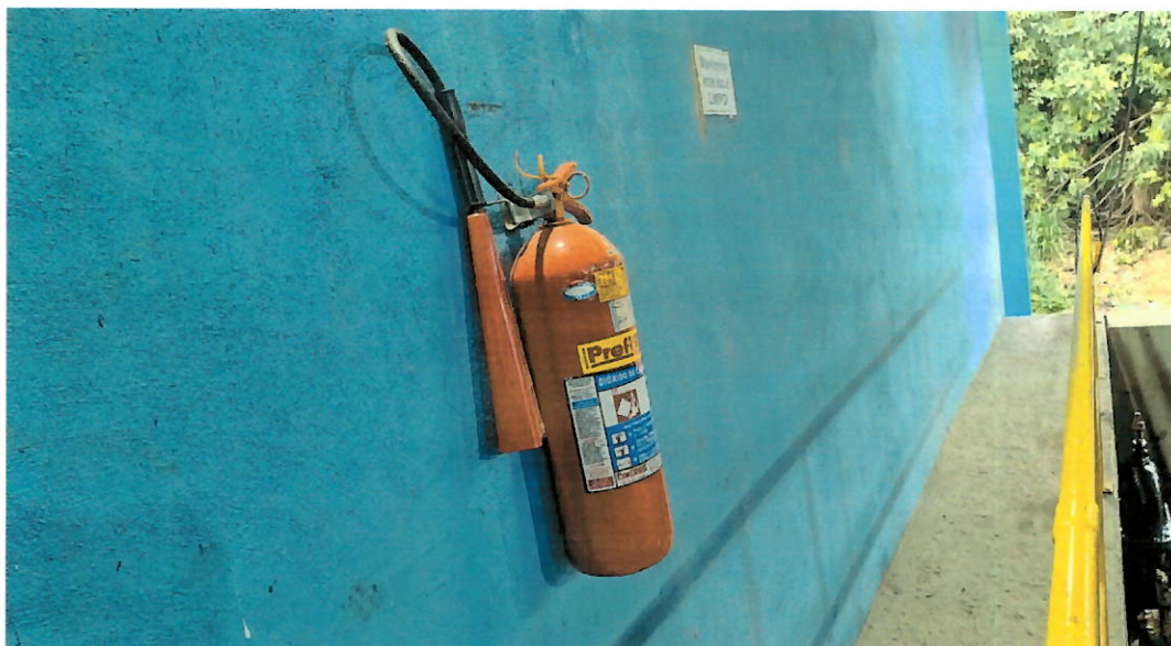
Foto 3: Extintor de incêndio.
