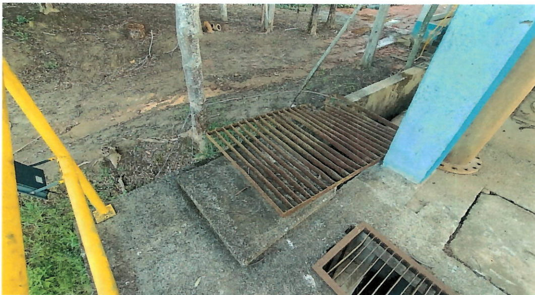
Foto 6: Trecho sem guarda-corpo.
