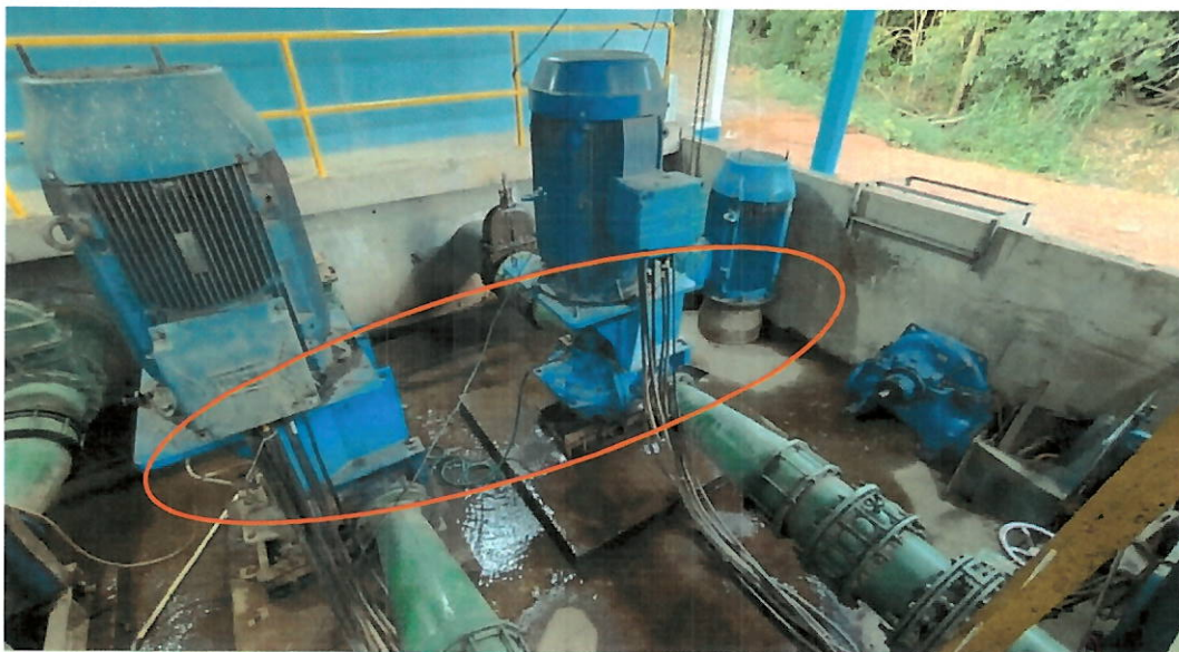
Foto 11: Conjuntos motobombas com vazamento na gaxeta.
