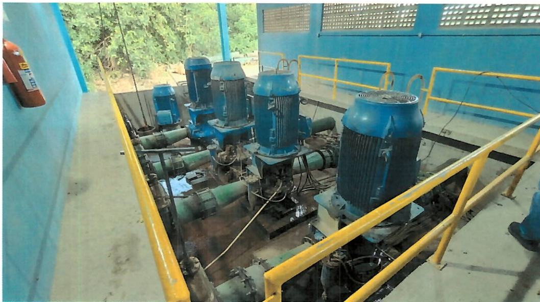
Foto 10: Conjuntos motobombas do Alto Recalque.
