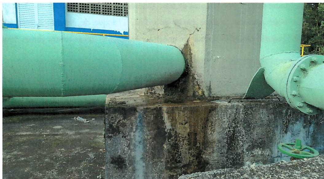
Foto 19: Vazamento de água no TAU.
