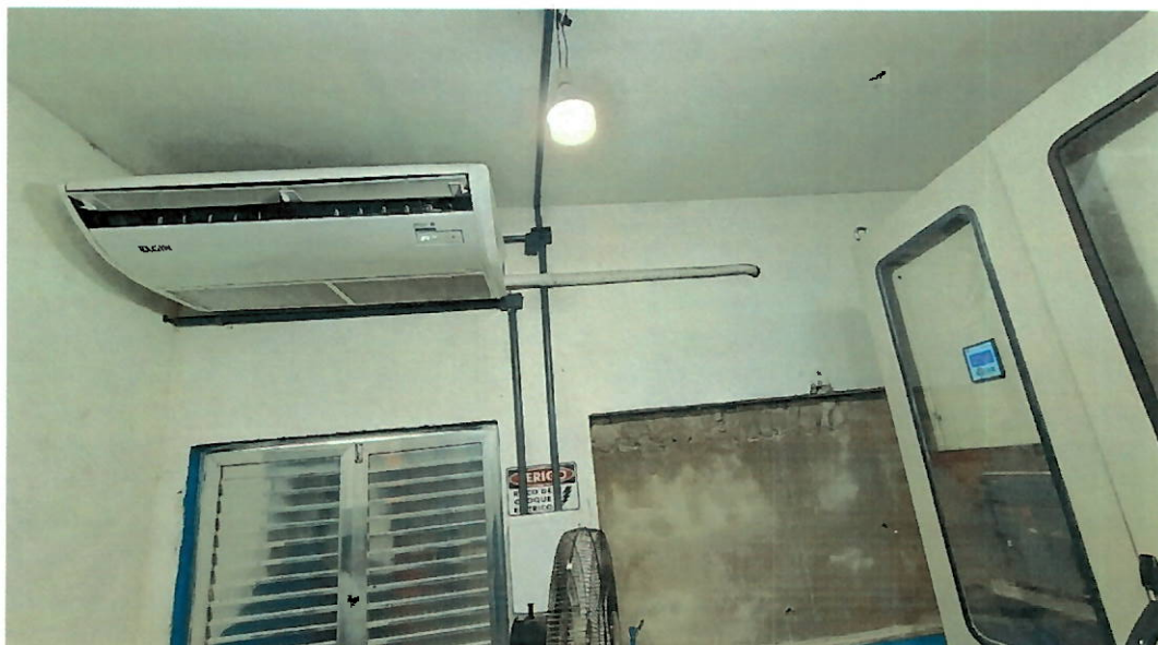
Foto 16: Aparelho de ar-condicionado instalado no local (nota-se que houve vedação completa da janela localizada no lado direito).
