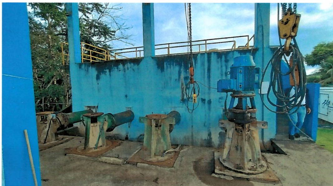
Foto 5: Conjunto motobomba de 50 cv (reserva quente).
