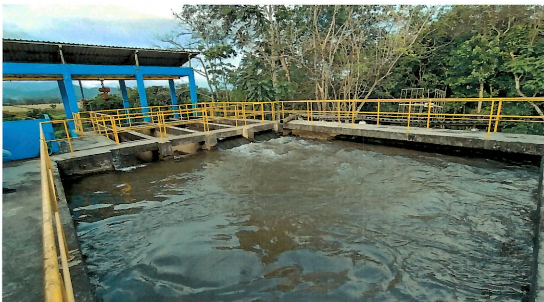
Foto 9: Poço de sucção do Alto Recalque.
