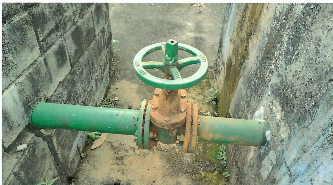
Foto 20: Registro reparado (ausência de vazamento).
