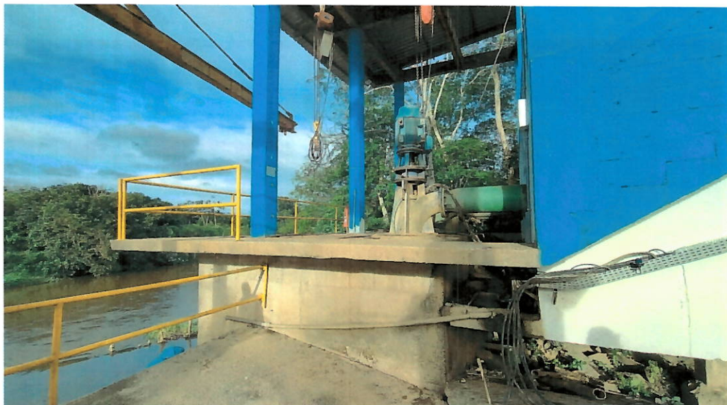
Foto 7: Trecho sem guarda-corpo.
