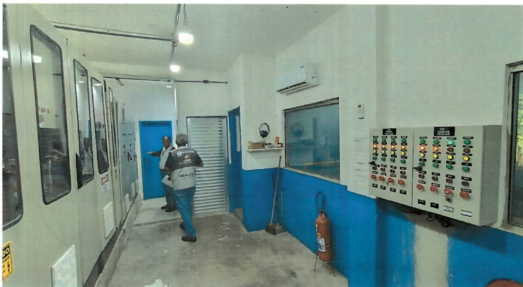
Foto 15: Sala dos quadros elétricos das bombas.
