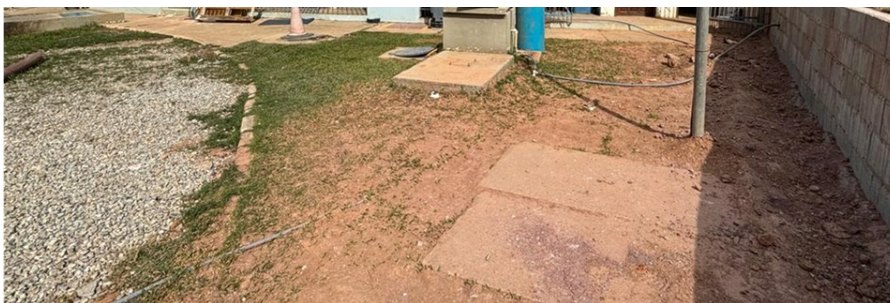
Foto 14 – Abrigos de equipamentos
