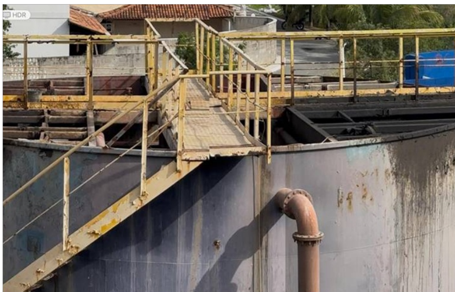
Foto 5 – Vista aproximada do tanque dos tratamentos secundário e terciário
