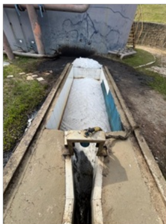
Foto 8 – Calha Parshall na saída. Efluente lançado com espuma.
