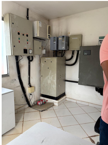
Foto 10 – Sala do operador
