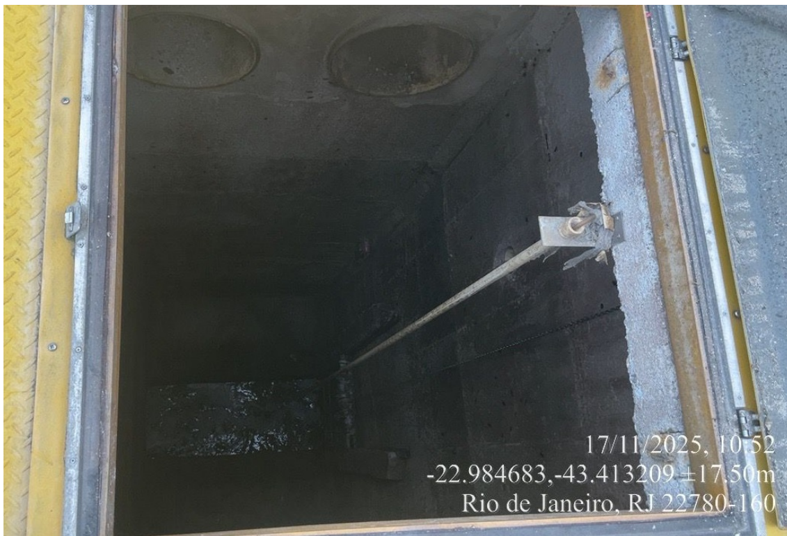
Foto 6 – Poço de chegada do esgoto com extravasor
