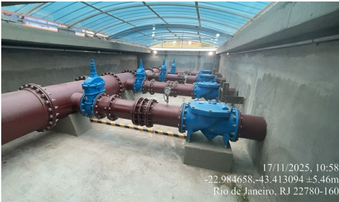
Foto 10 – Tubulações dos conjuntos motobombas providas de válvulas de retenção e fechamento
