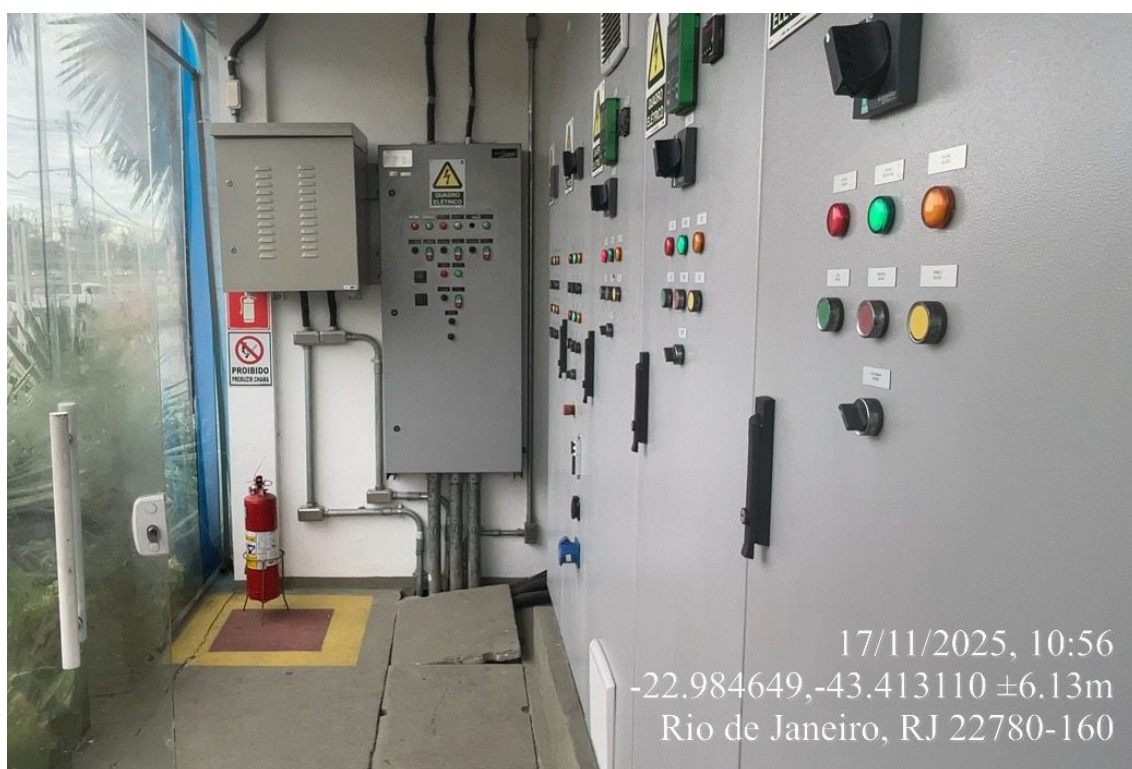
Foto 3 – Painel elétrico da EEEB
