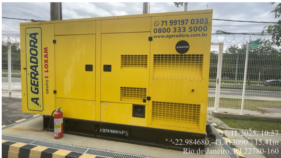
Foto 4 – Gerador instalado na EEEB
