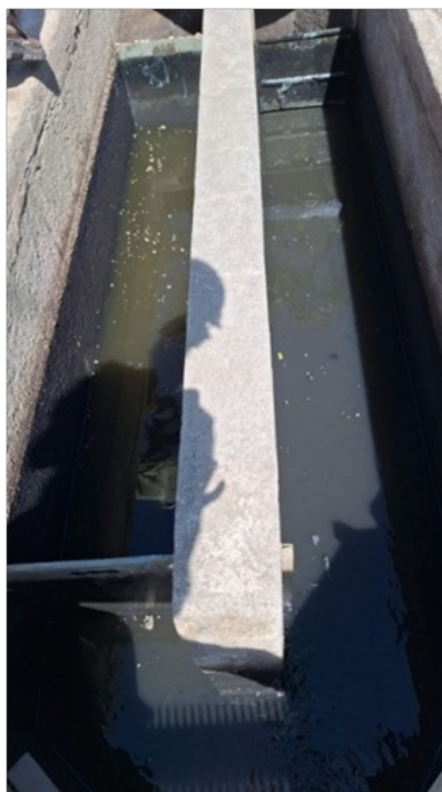
Foto 7 - Desarenador com By-pass, ou seja, com duas câmaras. Durante a operação de limpeza do outro canal as comportas são fechadas para remoção do material sedimentado (principalmente inorgânico) .
