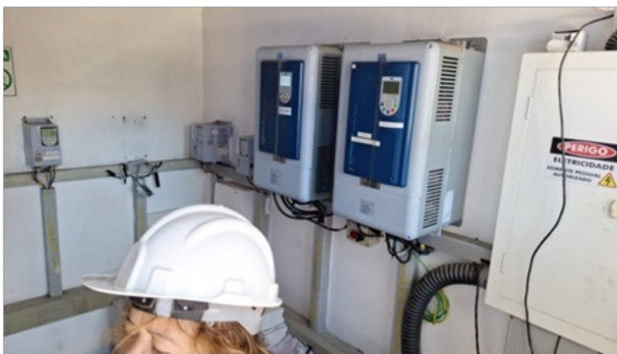
Foto 3 – Inversores de frequência e quadro elétrico dos sopradores.
