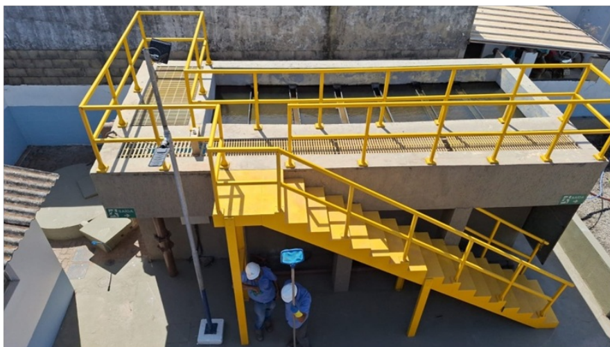
Foto 14 – Efluente tratado vai para o decantador, que não recircula o lodo para o reator. O lodo do decantador vai para tanque junto ao lodo do anóxico para ser recalcado para o bag.
