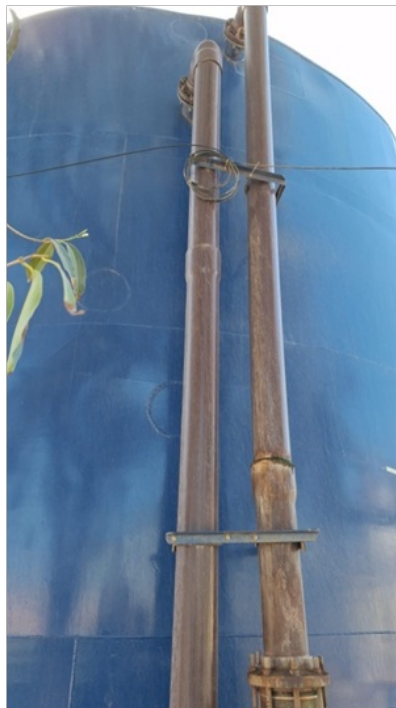
Foto 13 – Tubulação da direita entrada do esgoto bruto, e da esquerda saída para decantador.
