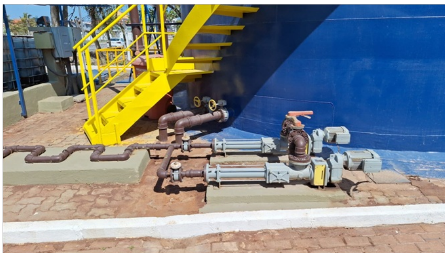
Fotos 16 – Elevatória de lodo que recalca para o bag, onde seu recalque não recebe adição de polímero.
