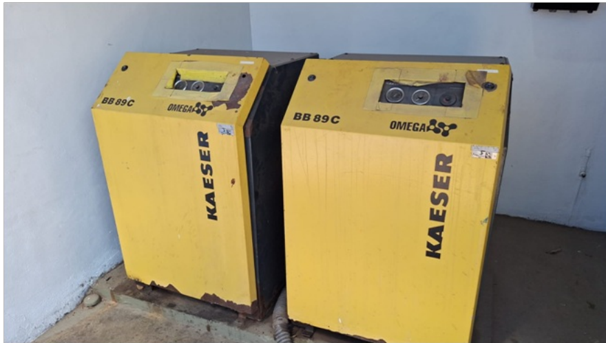
Foto 12 – Sopradores de ar para os difusores.
