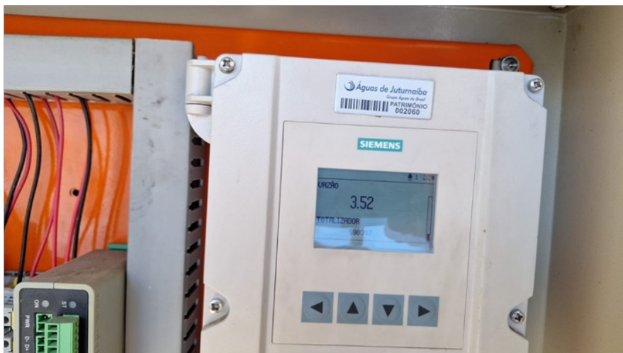
Foto 18 - Medidor de vazão eletrônico ( 3,52 l/s ). A diferença em relação a vazão de entrada é o lodo gerado com o tratamento.
