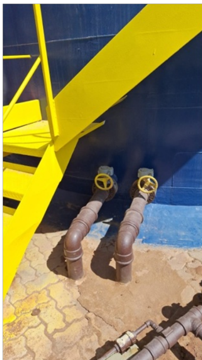
Foto 15 – Tubulações de descarga do lodo do tanque anóxico.
