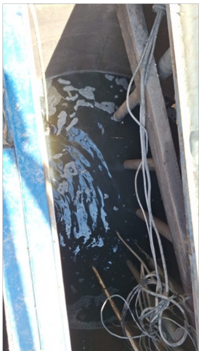
Foto 9 – Poço da EEB , com uma única bomba submersível em operação.
