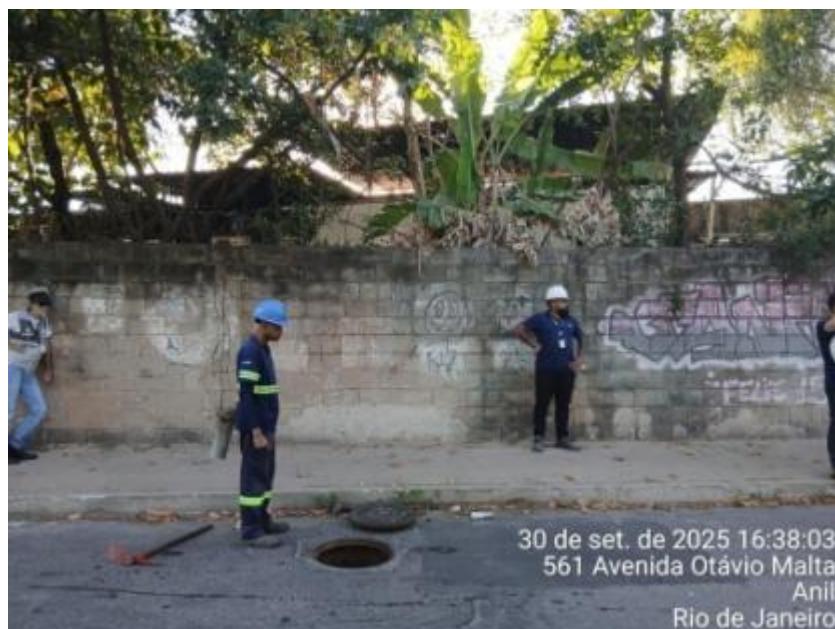
Foto 9 – Último PV da Avenida Canal do Anil antes do sifão
