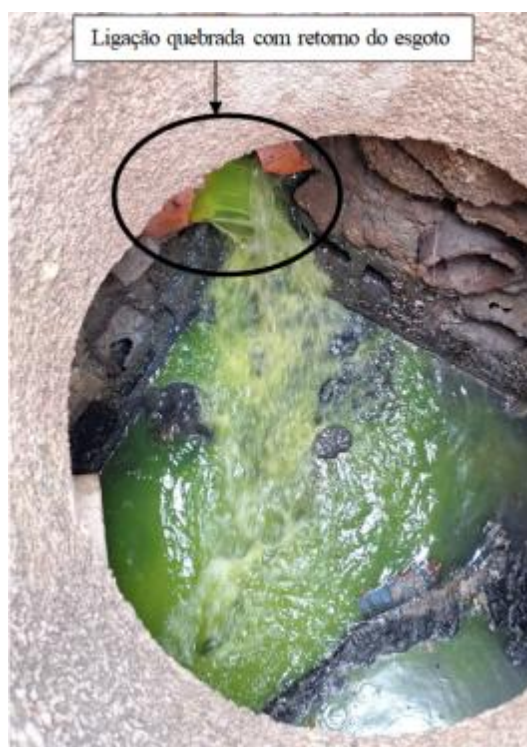
Foto 19 – Ligação de esgoto quebrada na caixa de areia
