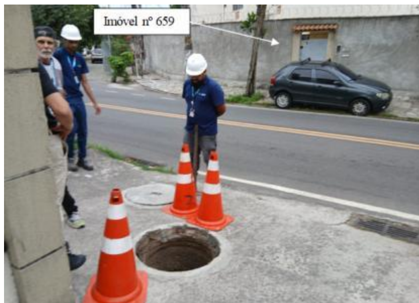
Foto 18 – Caixa de areia na Estrada Caribú, onde está a ligação de esgoto quebrada
