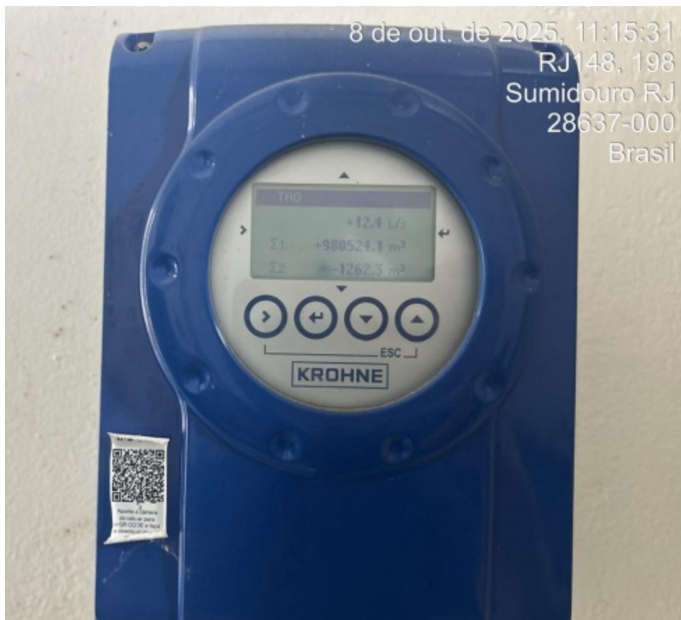
Foto 17 – Medidor de saída da água tratada
