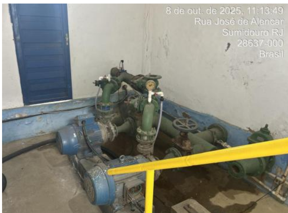
Foto 14 – Conjuntos motobombas da elevatória de água tratada
