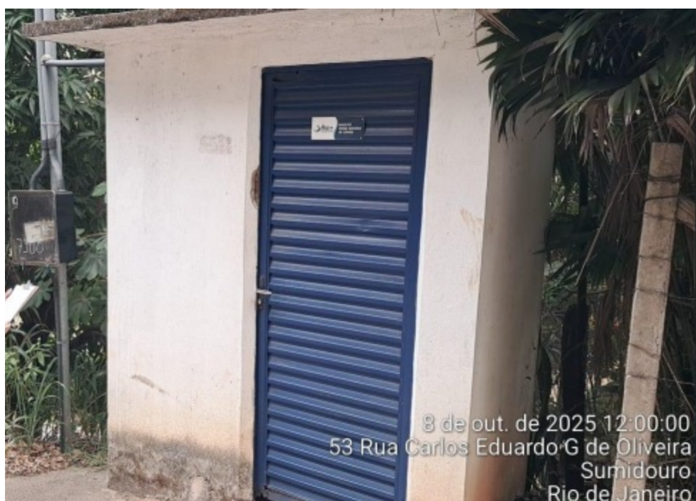
Foto 24 – EEAT Nossa Senhora de Lourdes
