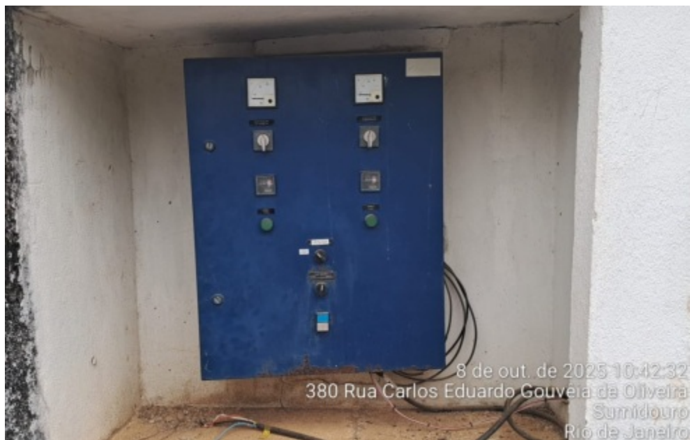
Foto 3 – Pannel de automação sem sinalização de risco
