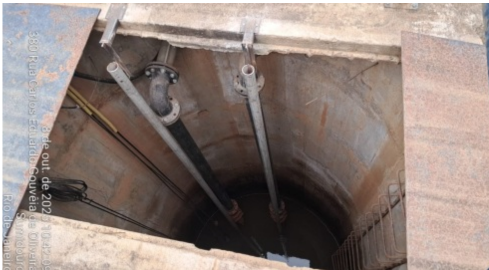
Foto 4 – Caixa de armazenamento com cobertura
