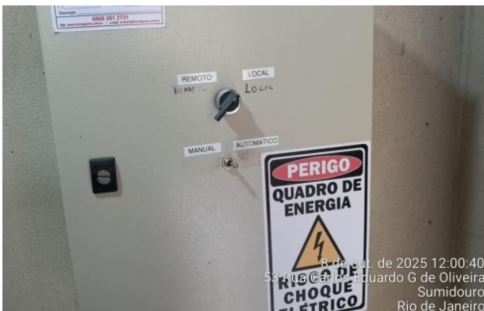
Foto 26 – Painel de automação com sinalização de risco
