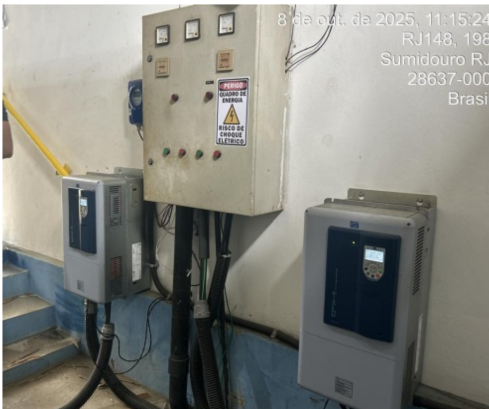
Foto 16 – Painele de automação das bombas e inversores de frequência
