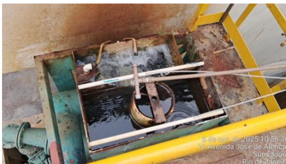
Foto 7 – Chegada da água bruta apresentando muita corrosão
