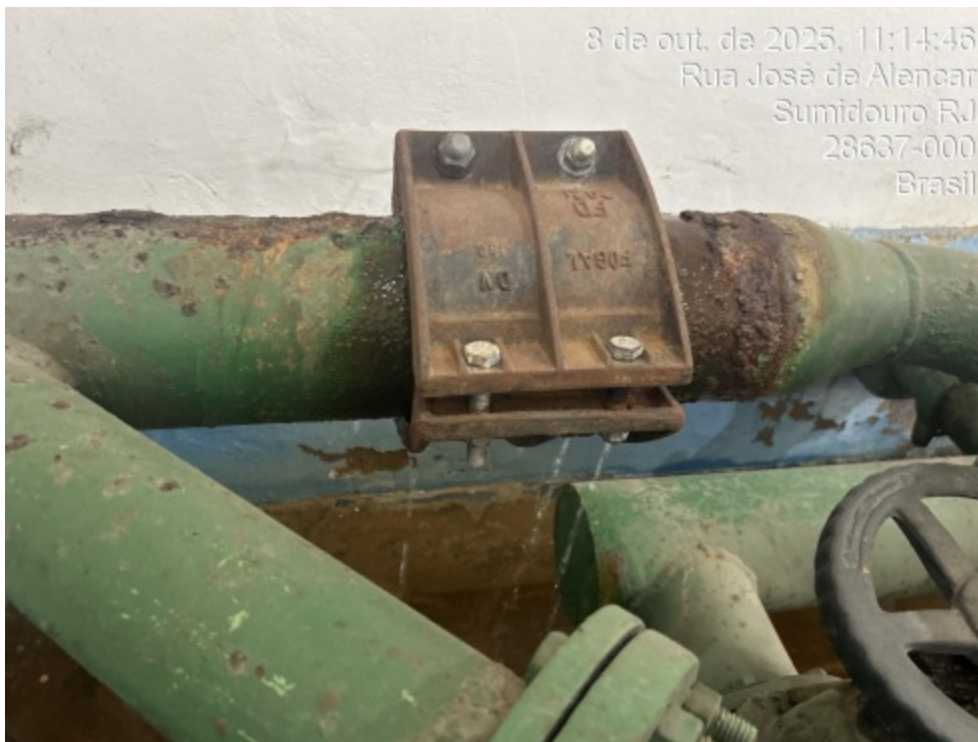
Foto 15 – Pontos de vazamento na tubulação
