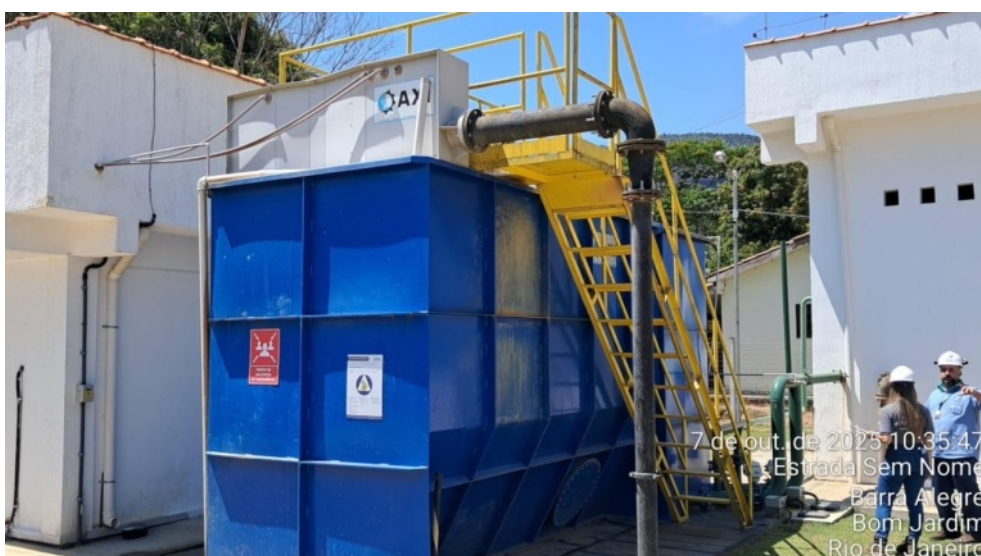
Foto 7 – Chegada da água bruta
