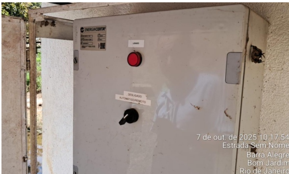
Foto 3 – Pannel de automação sem sinalização de risco
