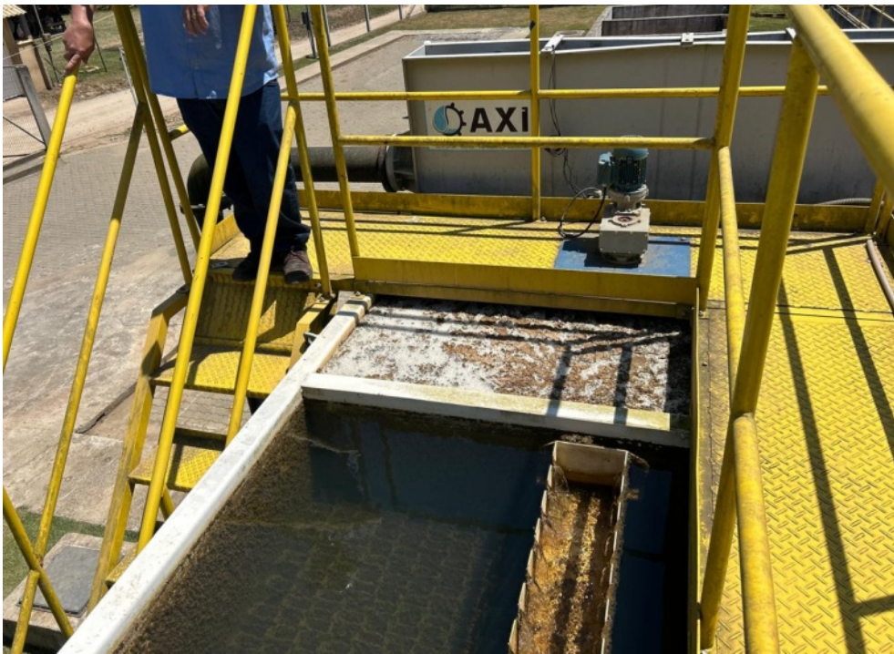
Foto 9 – Floculador e decantador
