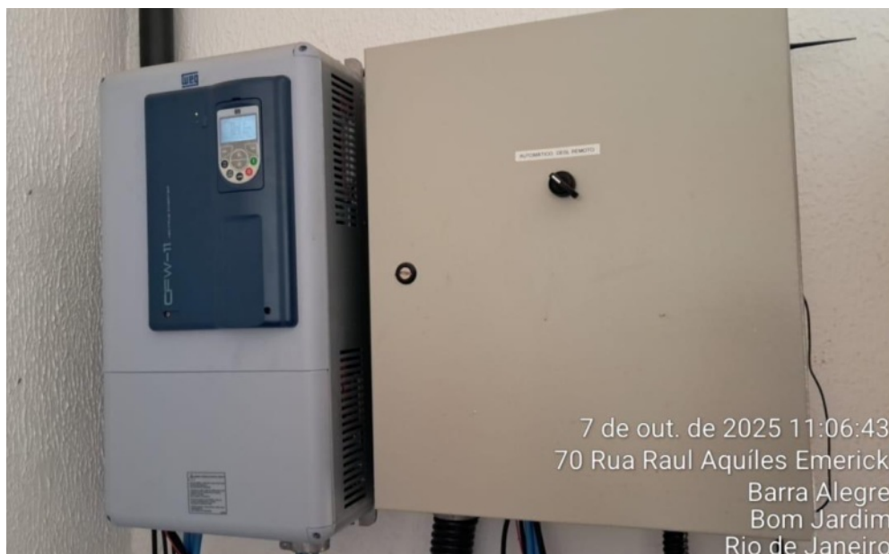
Foto 25 – Pannel de automação sem sinalização de risco
