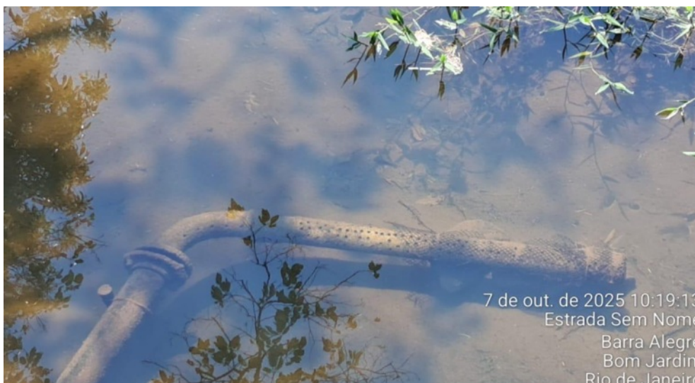
Foto 5 – Tubulação de captação com crivo
