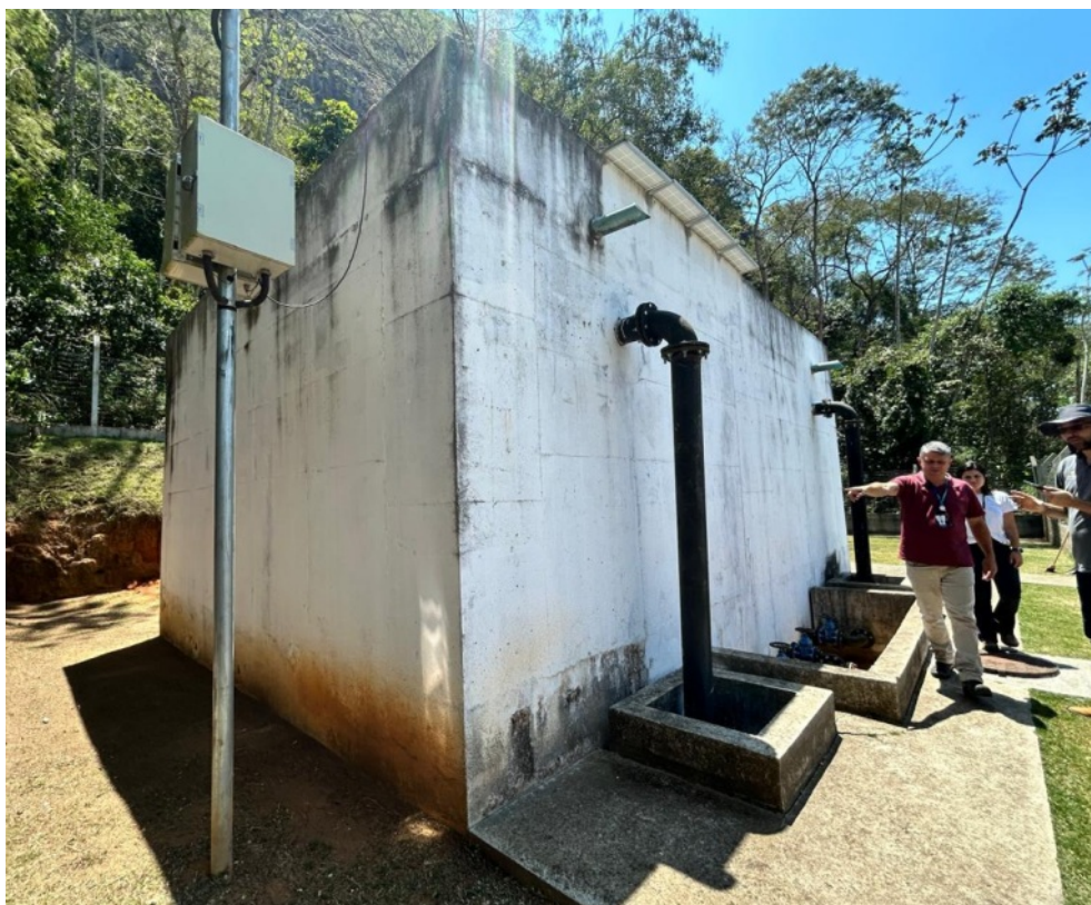
Foto 27 – Tubulações de chegada e distribuição
