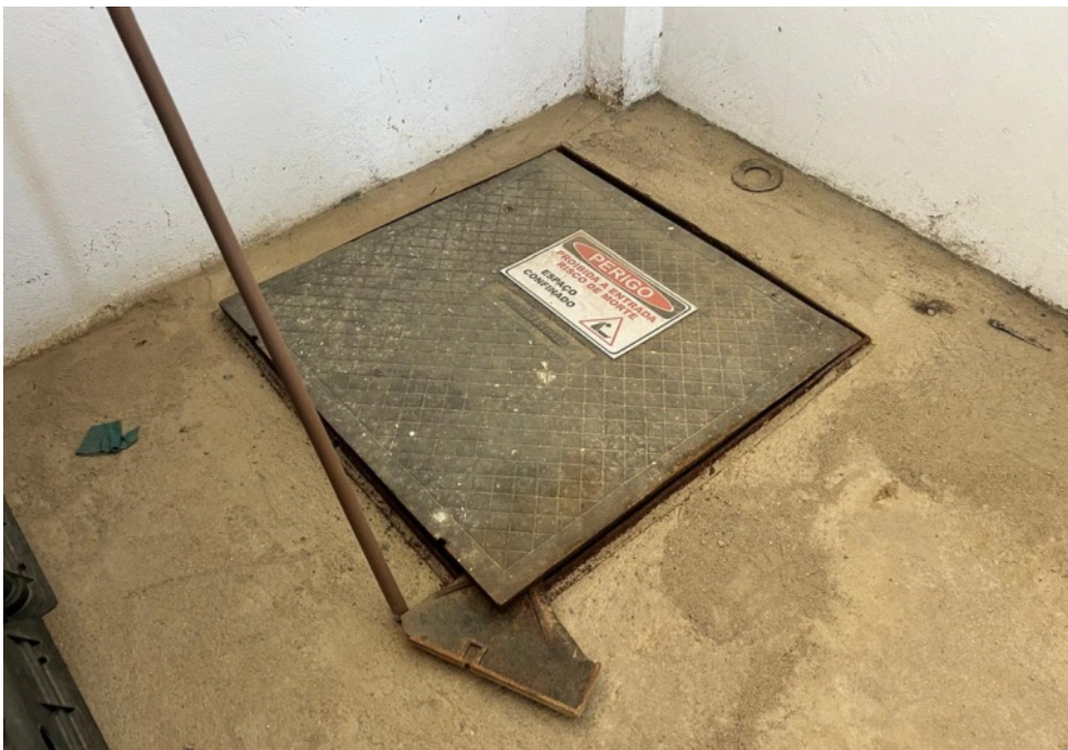
Foto 16 – Tampa de acesso ao reservatório entreaberta
