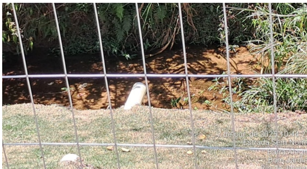
Foto 22 – Saída do efluente
