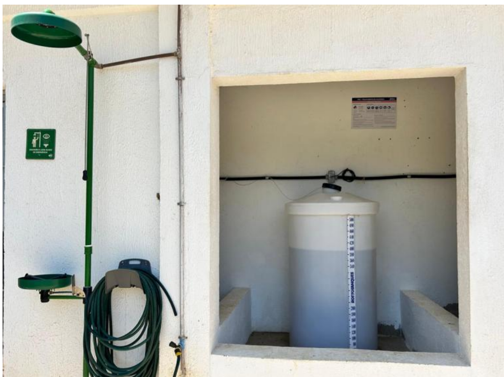
Foto 11 – Tanques de armazenamento de produtos químicos
