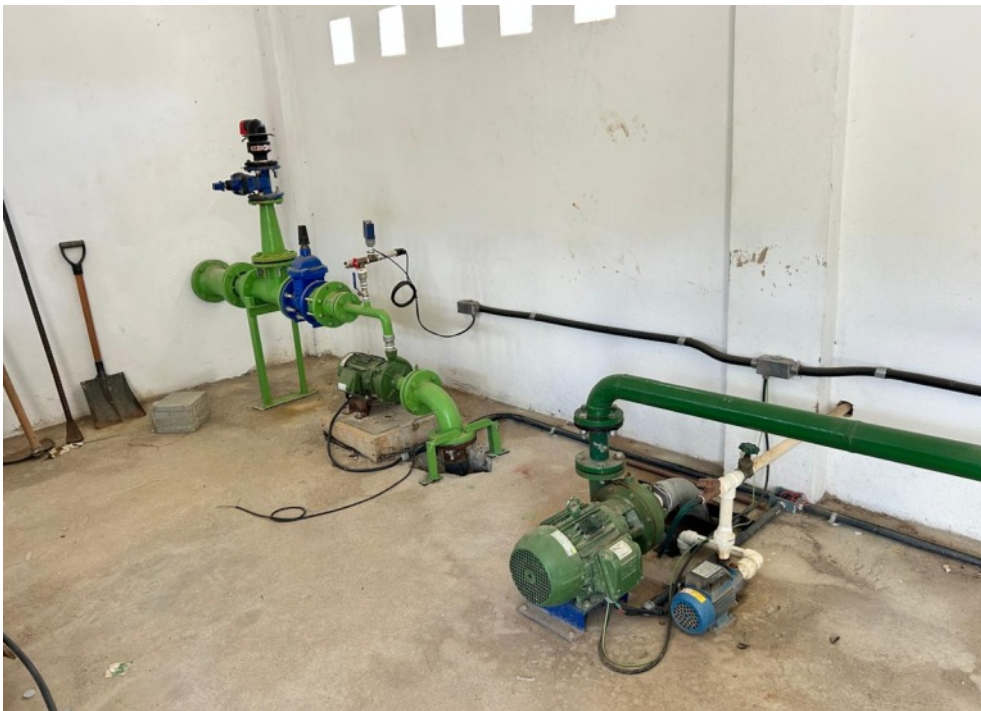
Foto 15 – Conjunto motobomba da elevatória de água tratada
