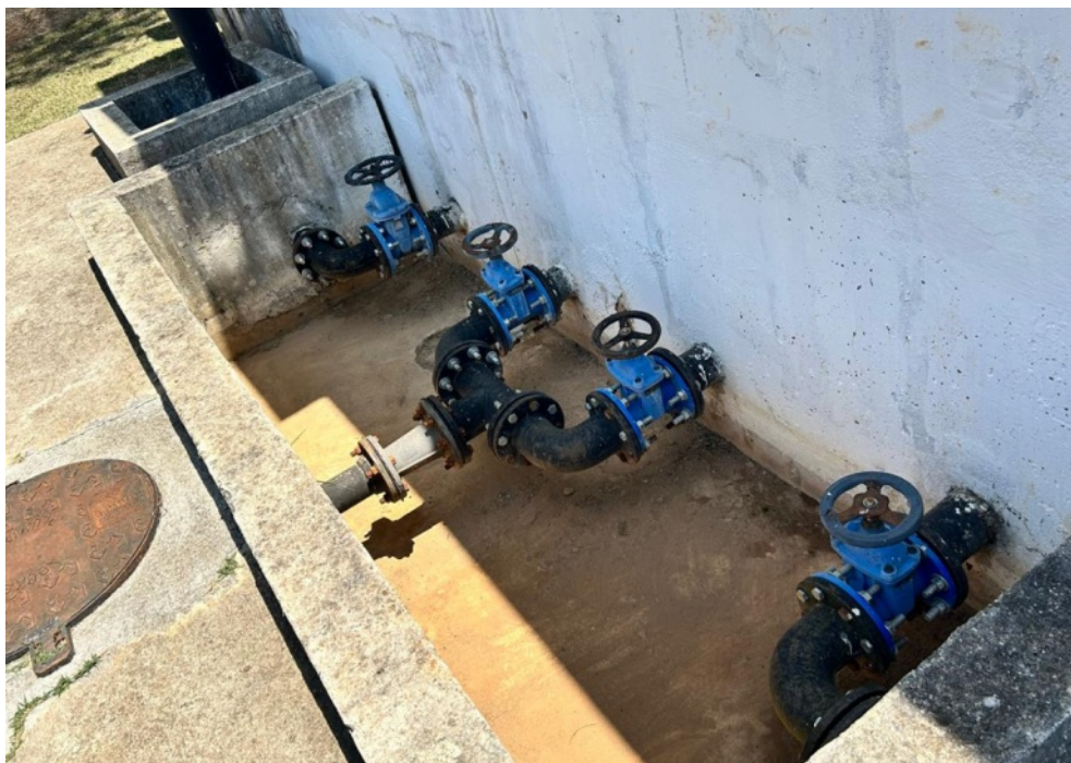
Foto 29 – Registros das tubulações
