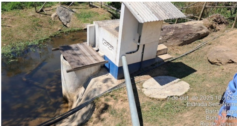
Foto 2 – Caixa de armazenamento e elevatória de água bruta.
