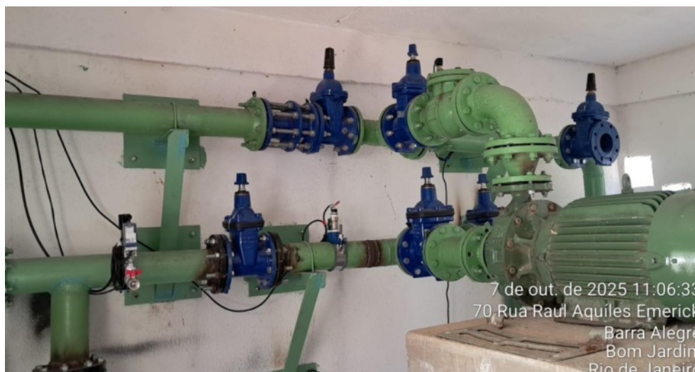
Foto 24 – Conjunto motobomba instalado
