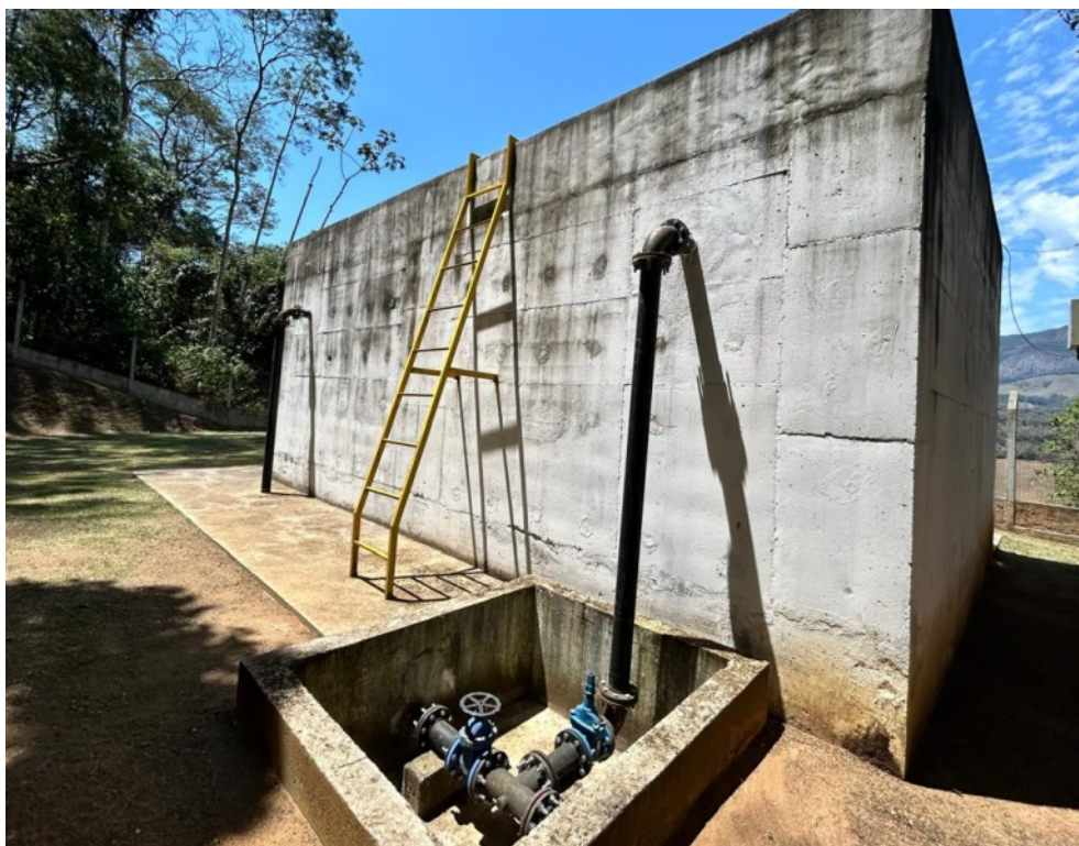
Foto 28 – Escada de acesso sem corrimão
