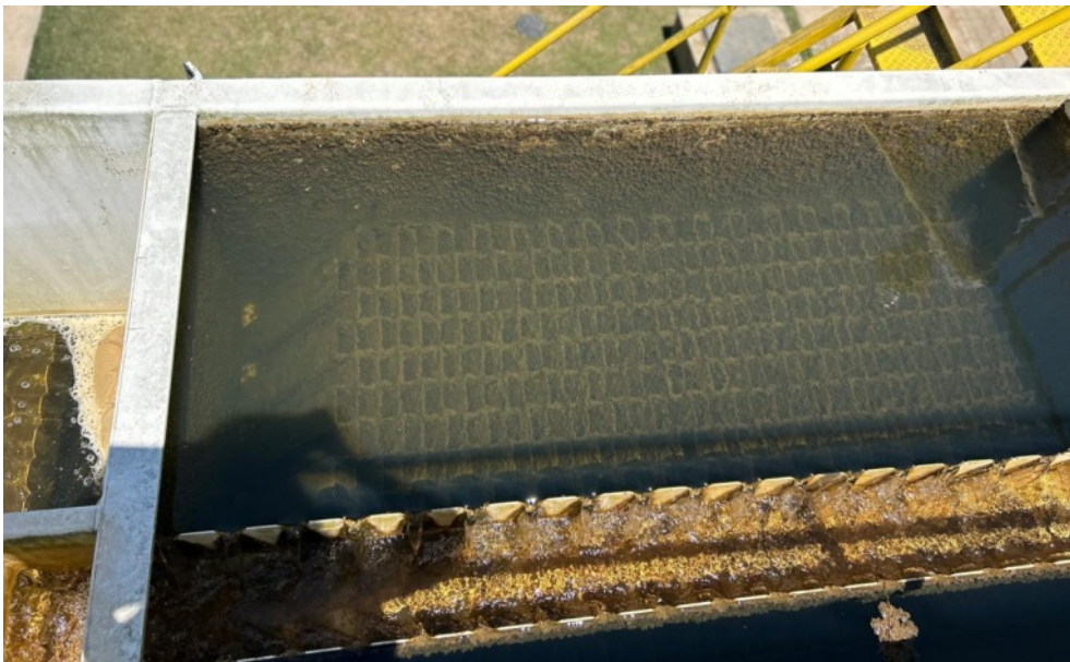
Foto 10 – Decantadores apresentando elevada sujidade
