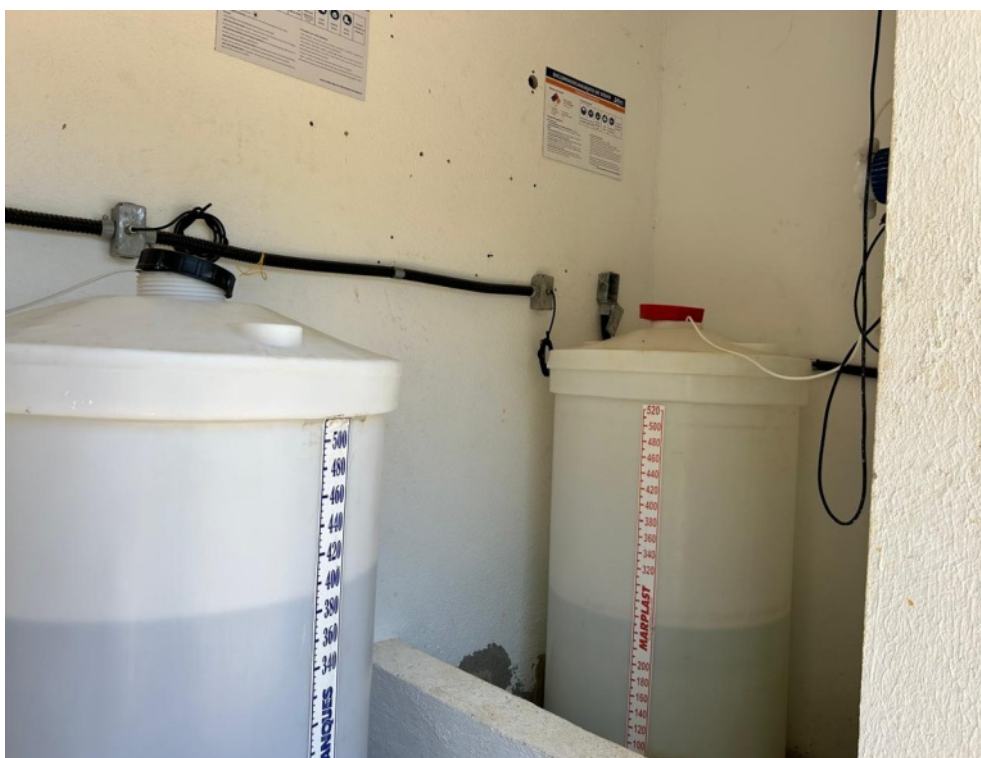
Foto 12 – Tanques de armazenamento de produtos químicos
