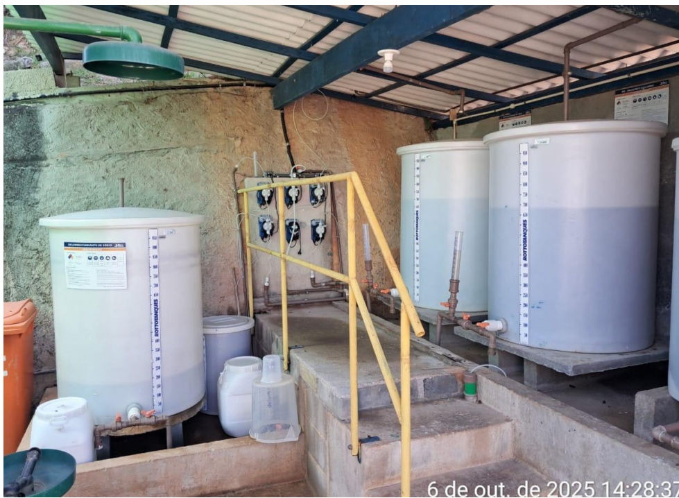
Foto 6 – Tanques de armazenamento de produtos químicos
