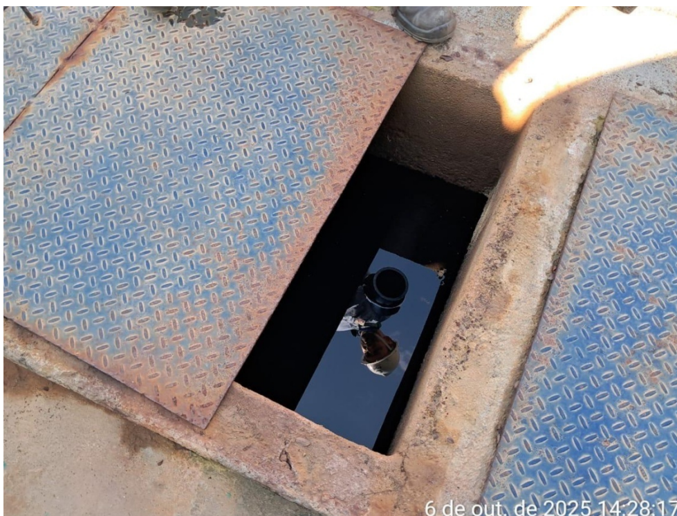
Foto 8 – Janela de acesso ao reservatório enterrado
