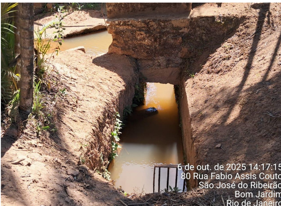
Foto 2 – Tubulação de captação com gradeamento
