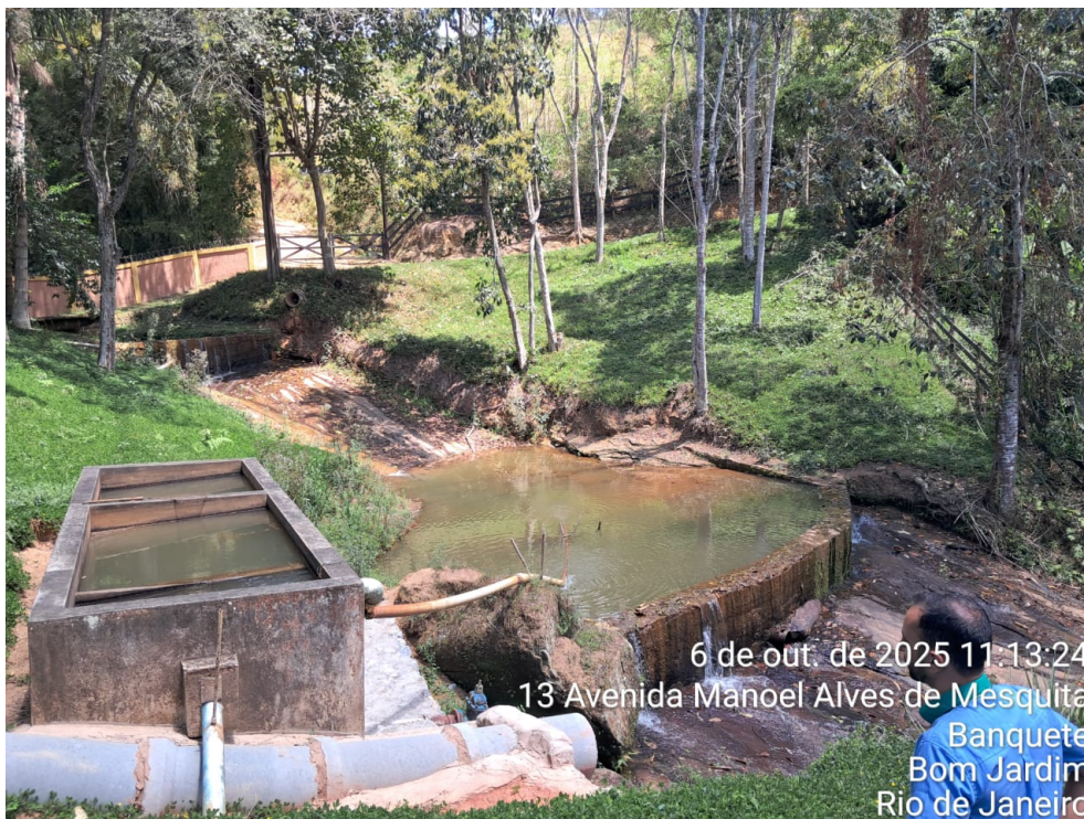
Foto 6 – Tanque de desarenação
