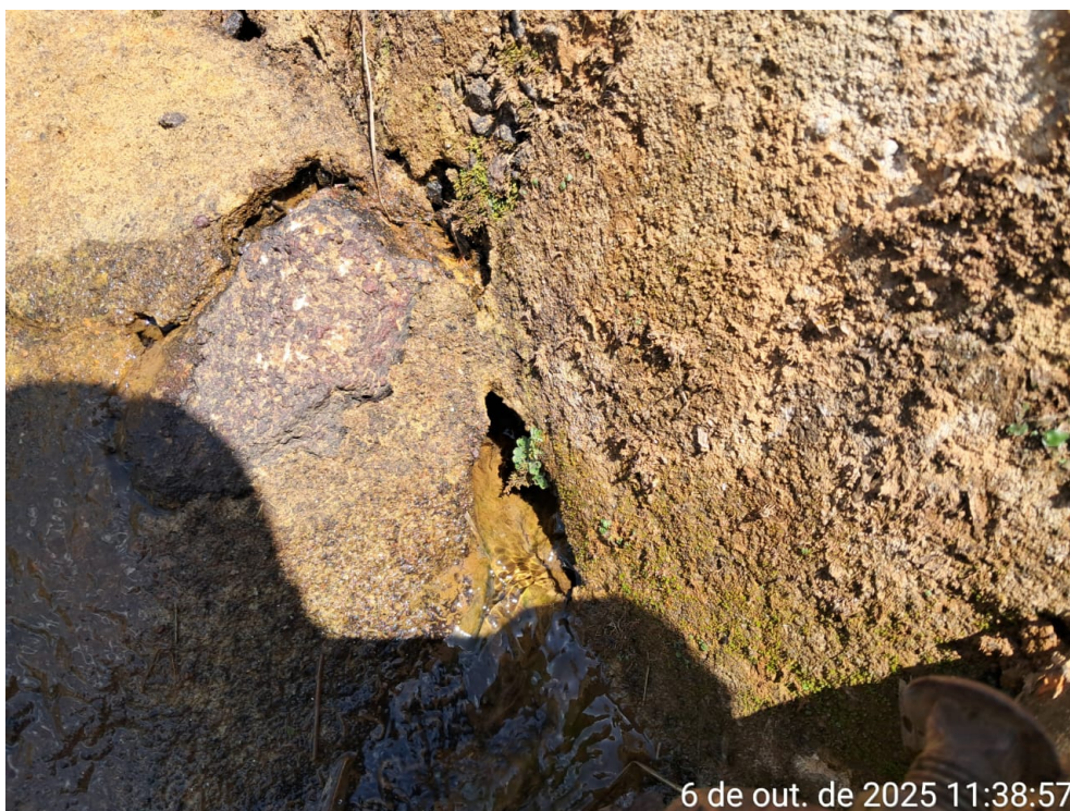
Foto 2 – Vazamento na base da barragem
