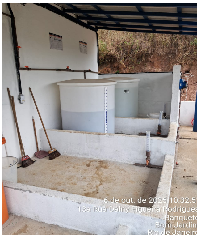
Foto 10 – Tanques de armazenamento de produtos químicos
