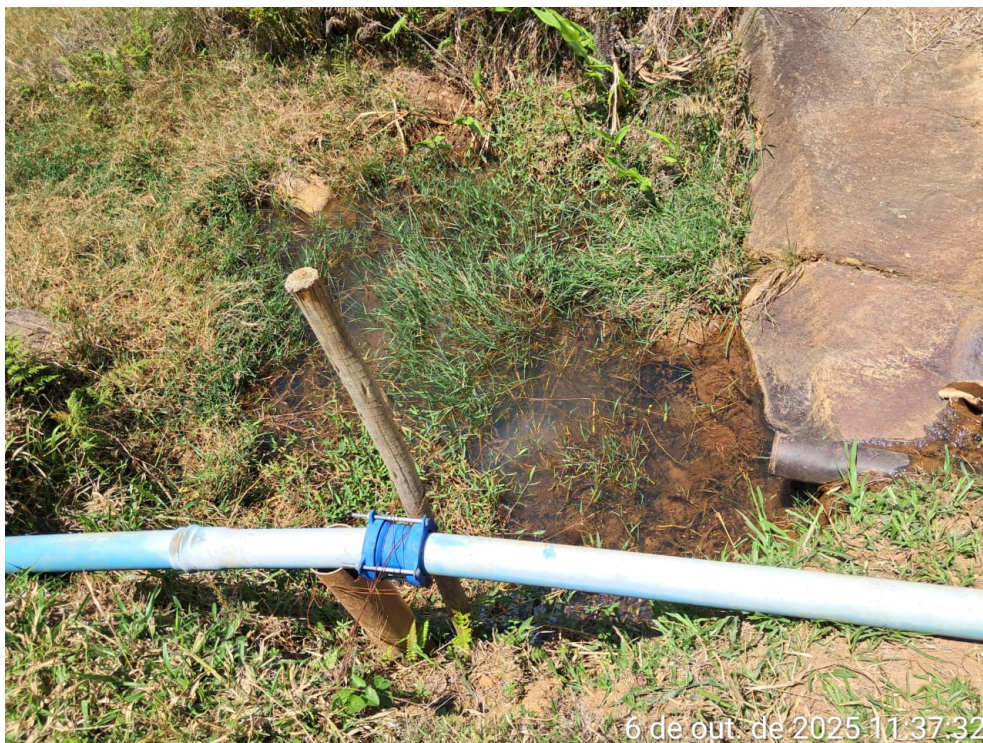
Foto 4 – Descarga de fundo
