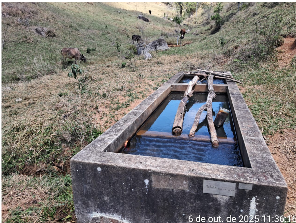
Foto 3 – Tanque de desarenação sem proteção adequada contra o acesso de animais
