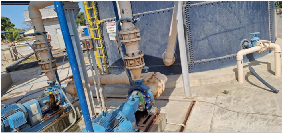
Foto 13 – Recirculação do efluente do reator, passando pela parte anóxica.
