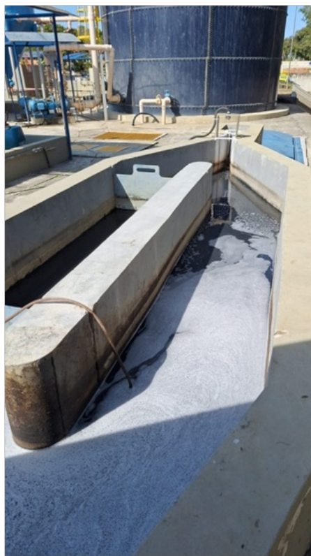
Foto 6 -Desarenador com By-pass , onde podemos ver dosagem de PAC para otimizar a sedimentação de sólidos em suspensão como em um decantador primário. Durante a operação de limpeza do outro canal as comportas são fechadas para remoção do material sedimentado (orgânico e inorgânico) .
