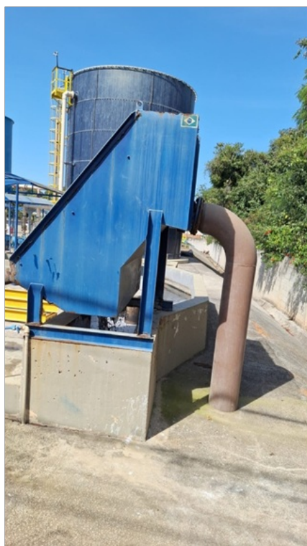
Foto 4 – Chegada do esgoto bruto oriundo das EEE's.
