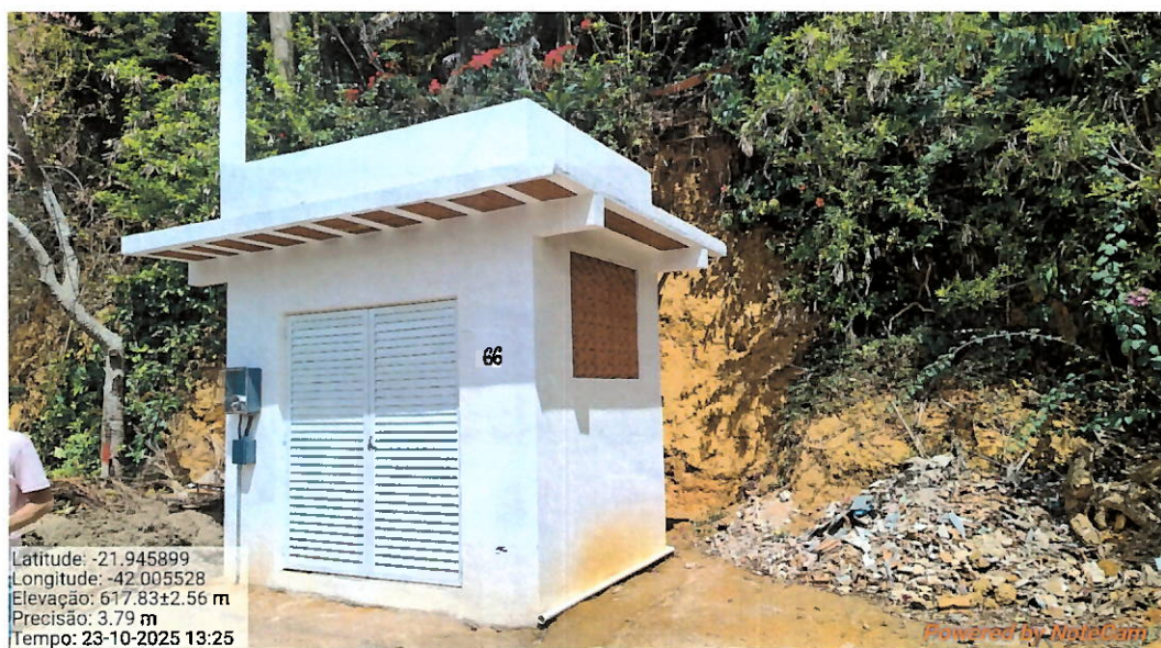
Foto 4: Abrigo do booster.
