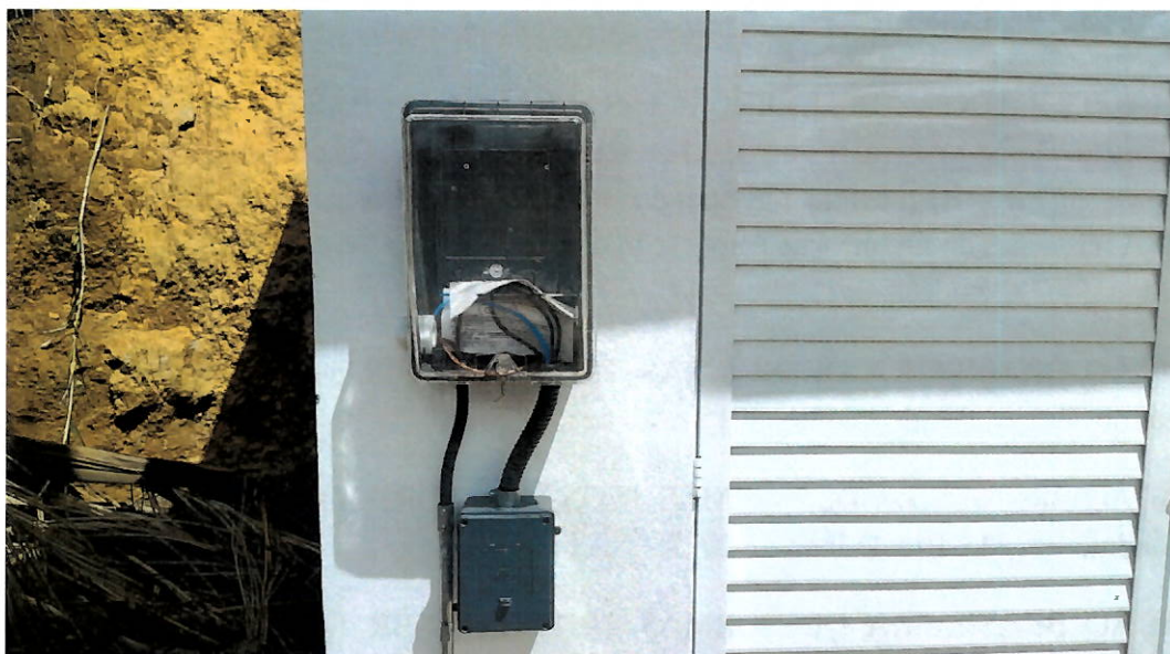
Foto 5: Ausência de ligação elétrica.
