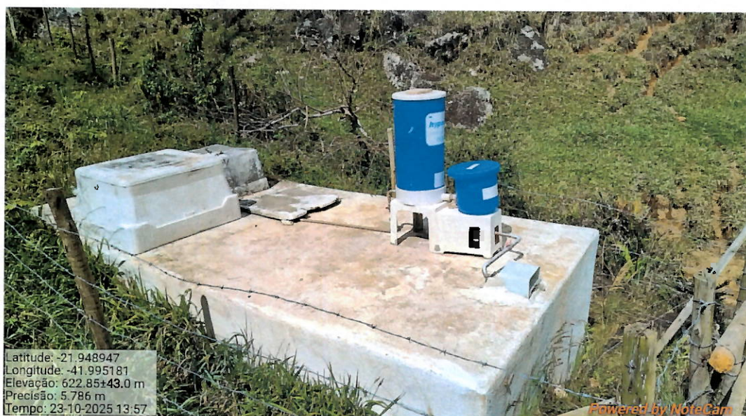
Foto 3: UT Dubois (tanque de cloração).
