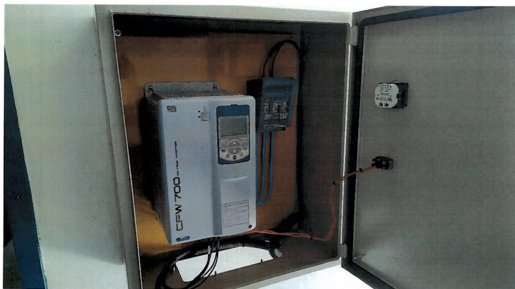
Foto 11: Pannel elétrico da bomba do agitador desligado.
