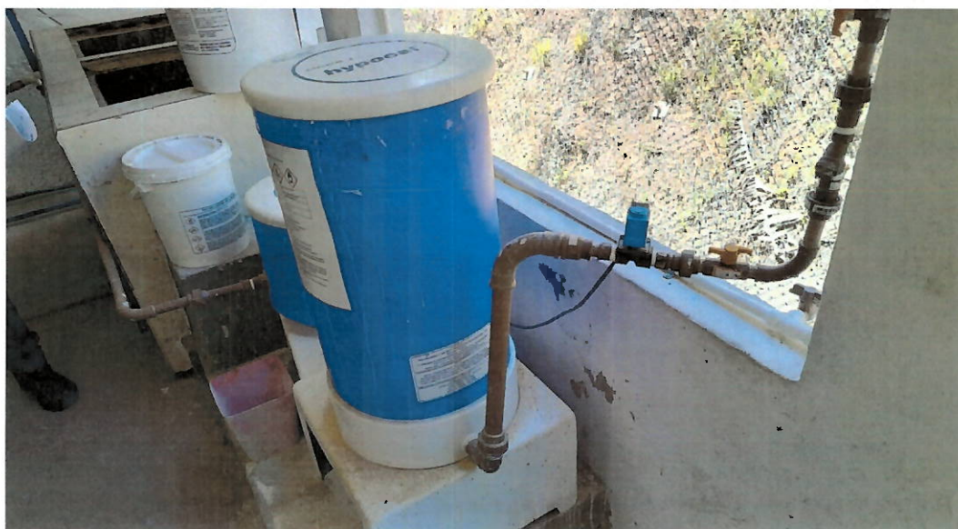
Foto 14: Sistema de cloração com hipoclorito de cálcio.
