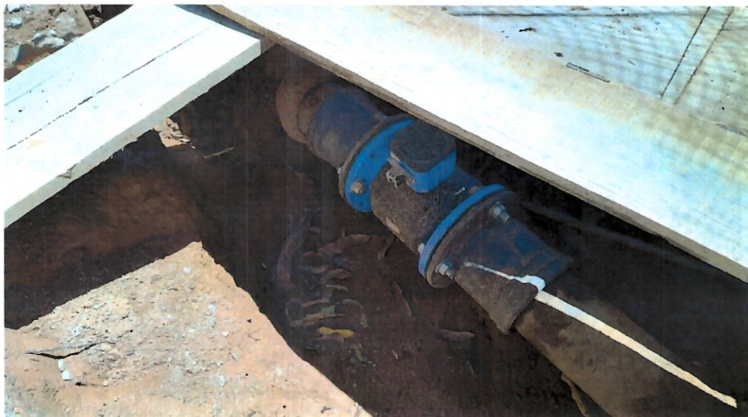
Foto 6: Macromedidor instalado na saída da ETA.
