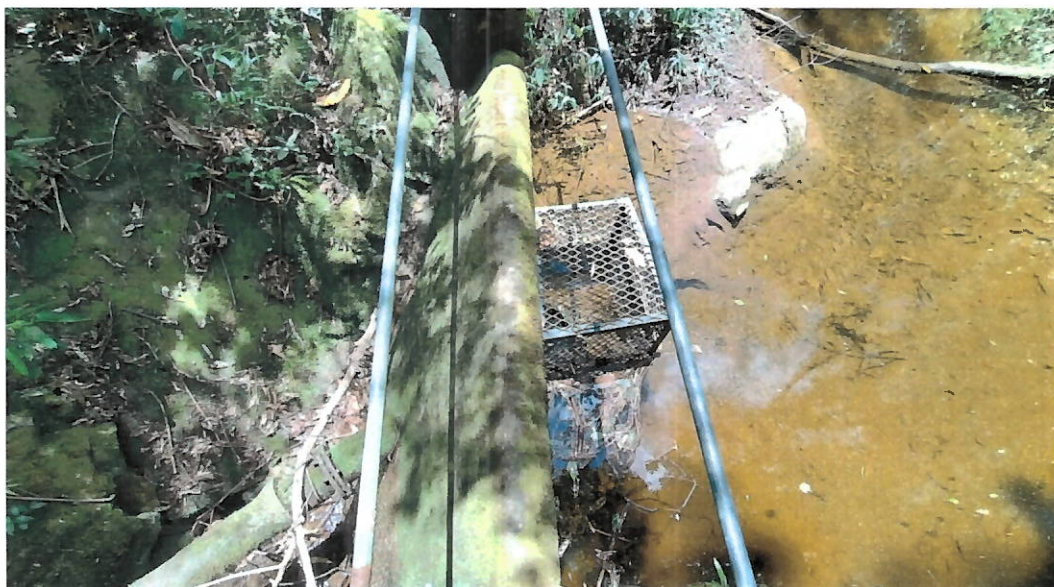
Foto 3: Ponto de captação – corrímão instalado.
