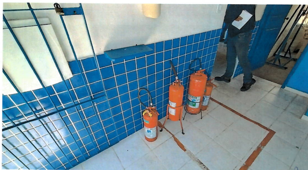
Foto 5: Extintores de incêndio
