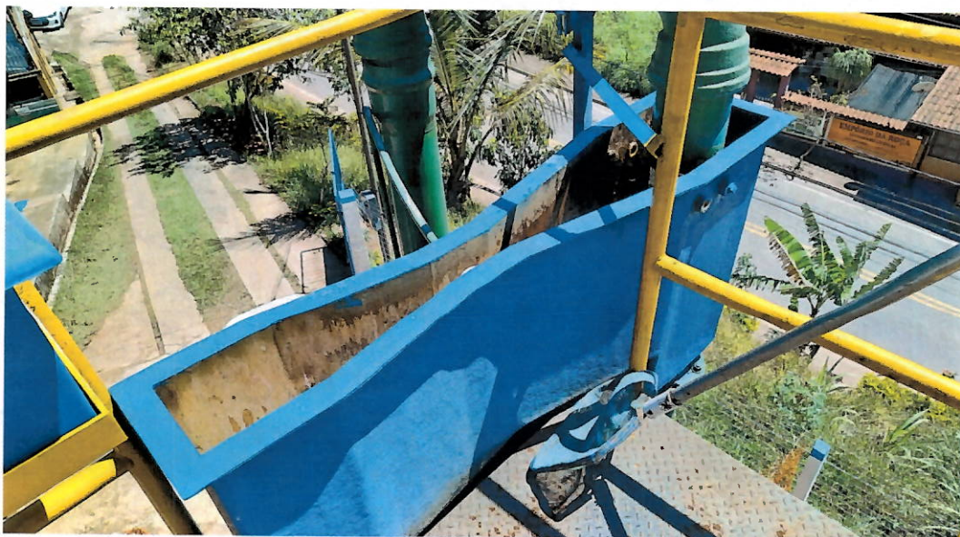
Foto 8: Entrada de água bruta na ETA.
