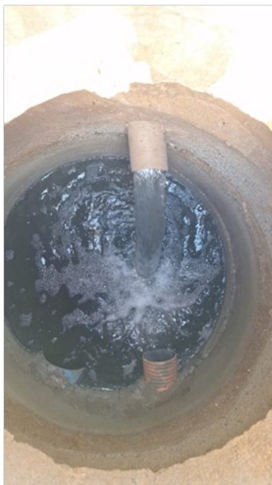
Foto 6 – PV de chegada do recalque da EEE Cinco de Julho.
