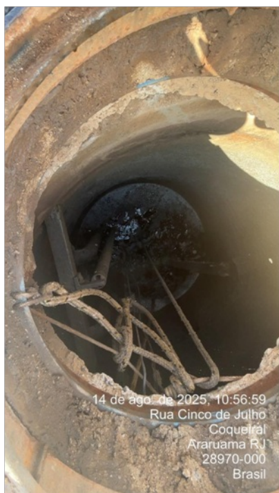
Foto 3 – Vista interna do poço da EEE Coqueiral com uma bomba.
