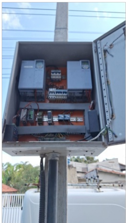
Foto 4 – Vista interna do quadro elétrico da EEE com dois inversores de frequência.
