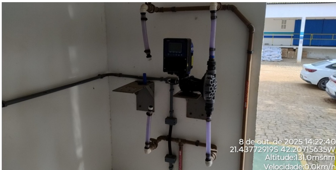
Foto 18: Dosador do Hipoclorito de sódio.
