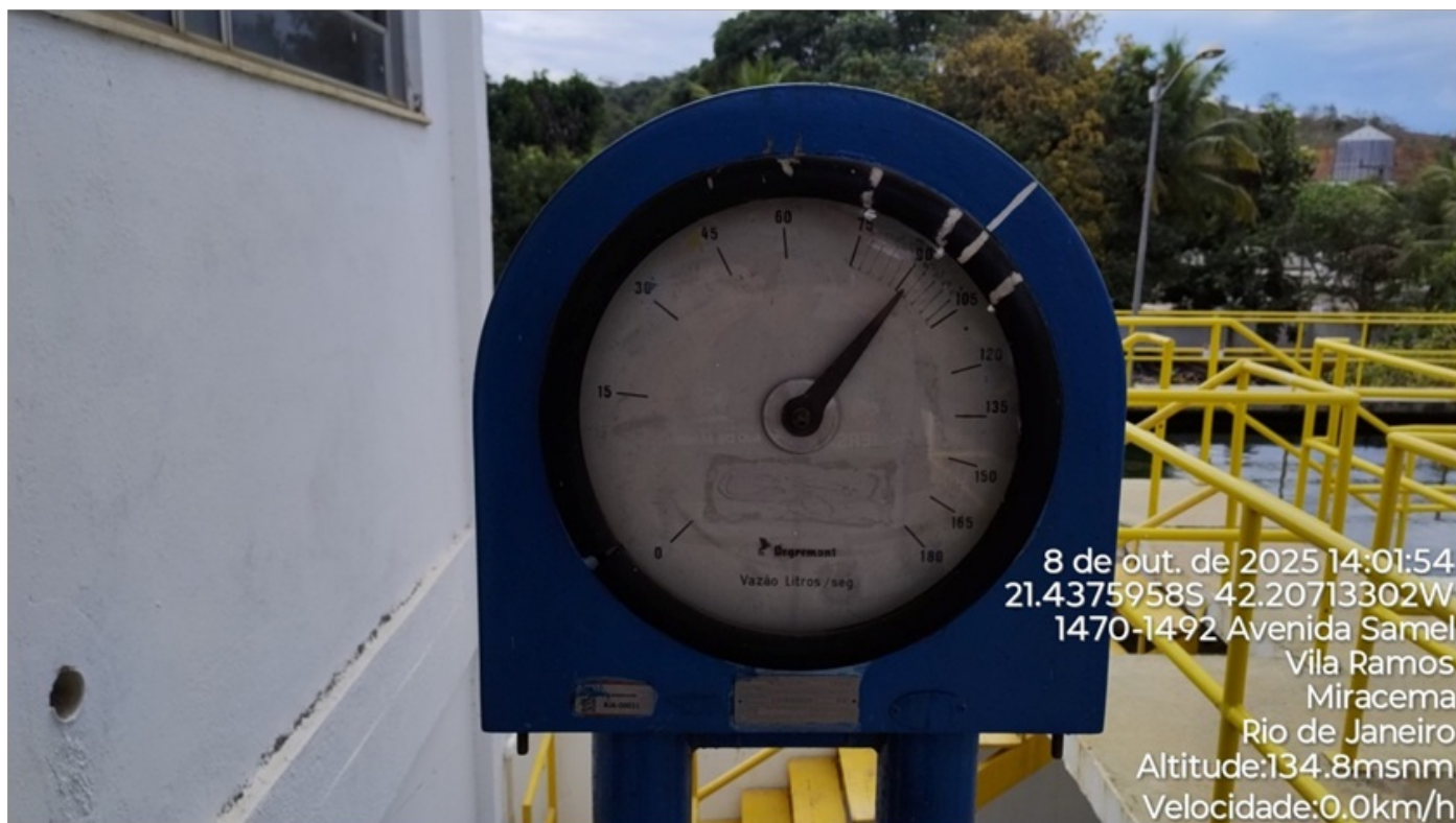
Foto 05: Medidor de vazão de água bruta (90 L/s).
