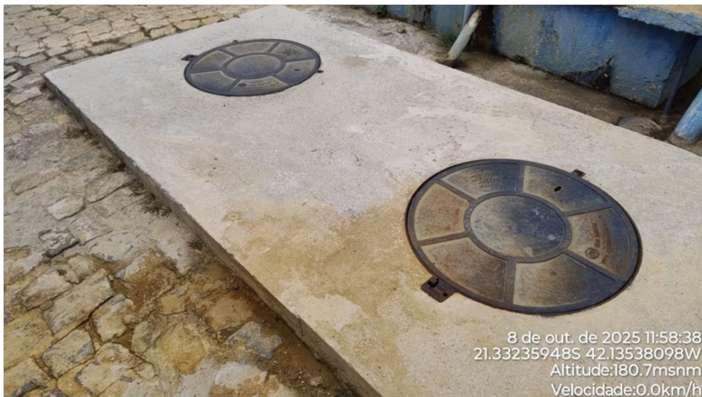
Foto 20: Macromedidor de água tratada.
