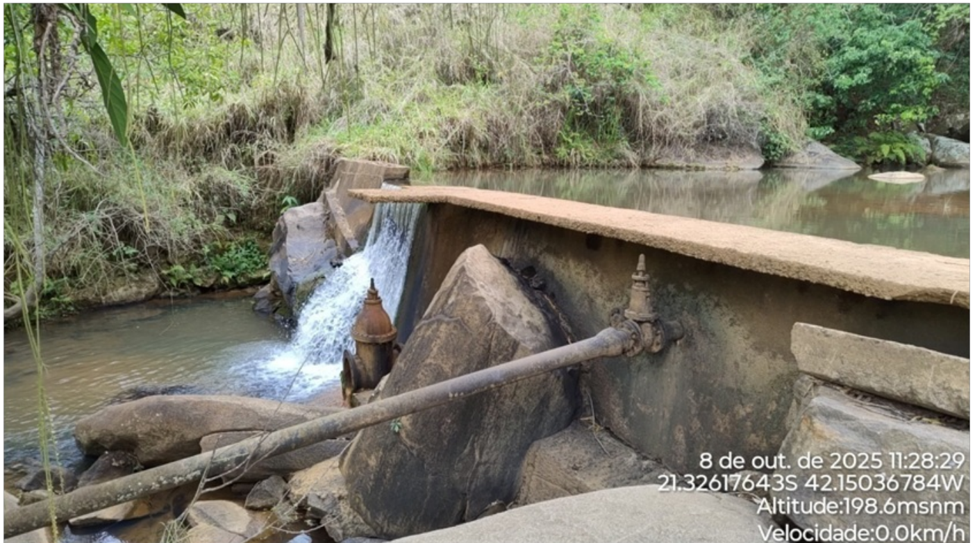
Foto 01: Barragem de captação no Ribeirão Santo Antônio.
