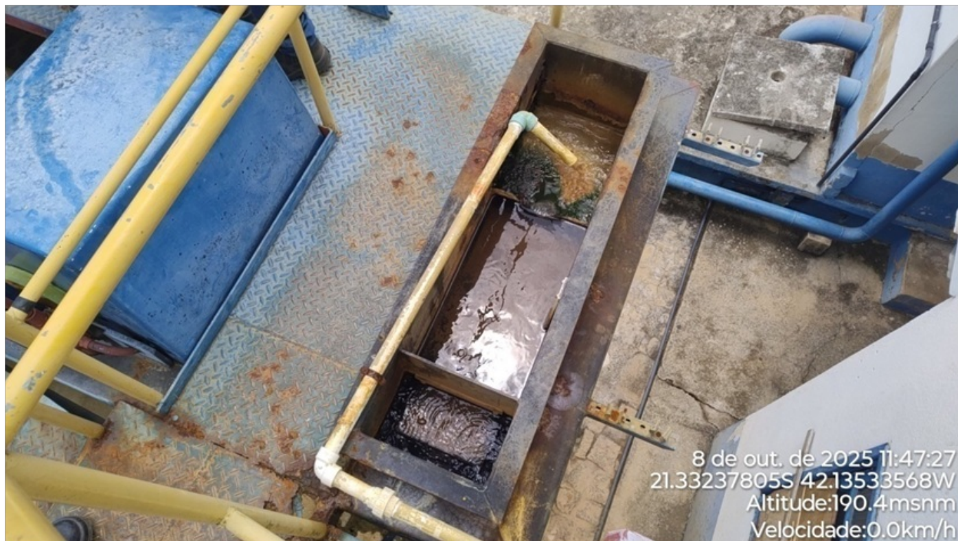
Foto 06: Calha Parshall e aplicação do agente coagulante.
