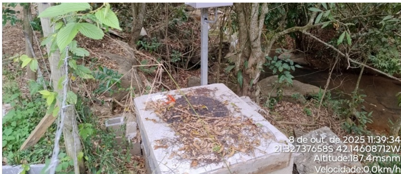
Foto 03: Macromedidor da captação no Ribeirão Santo Antônio.
