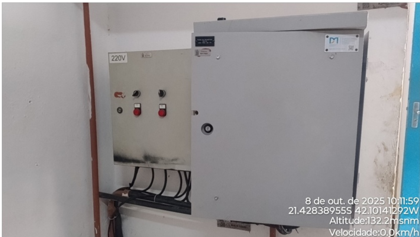
Foto 05: Painel de comando e telemetria.
