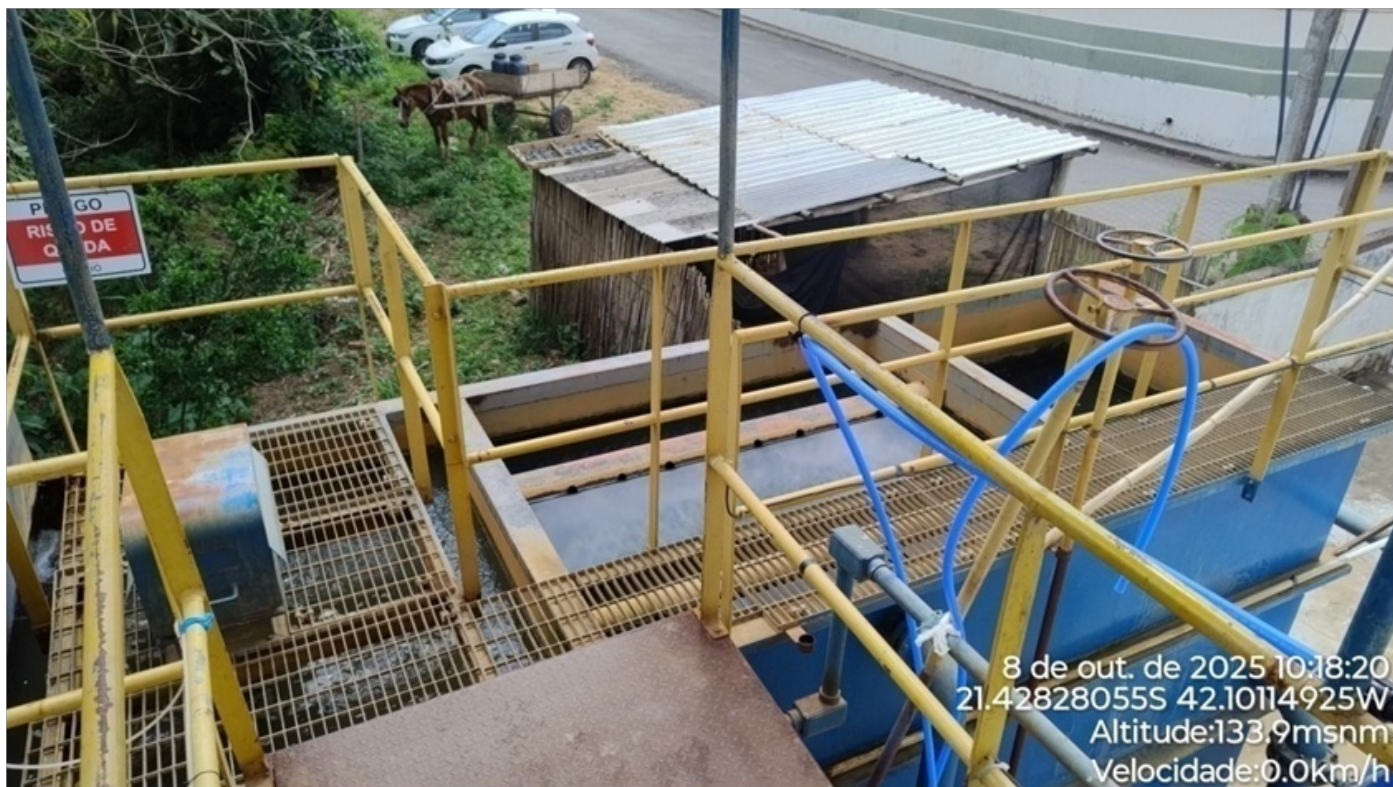
Foto 06: Módulo de tratamento.
