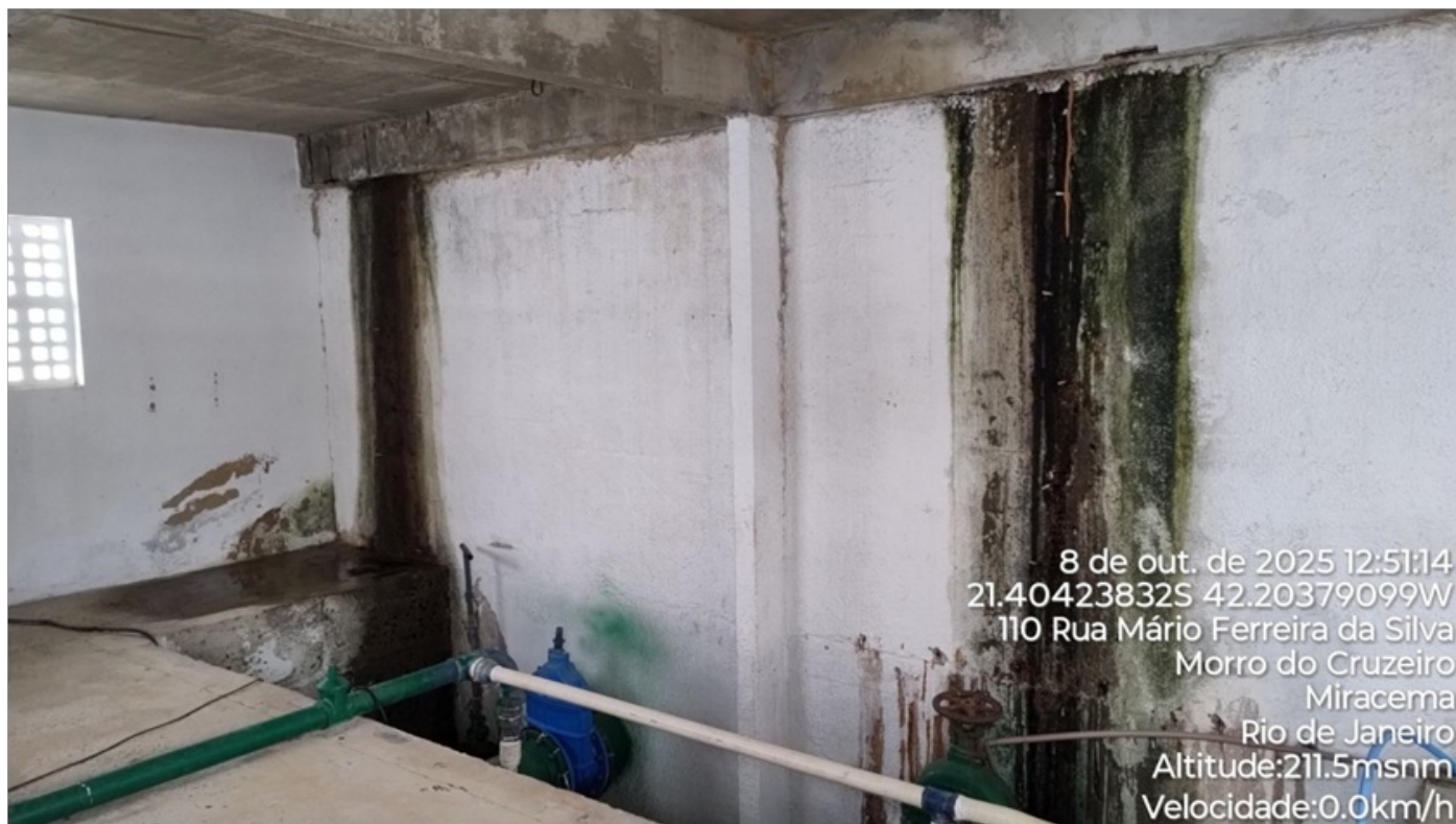
Foto 08: Infiltração na parede do reservatório.
