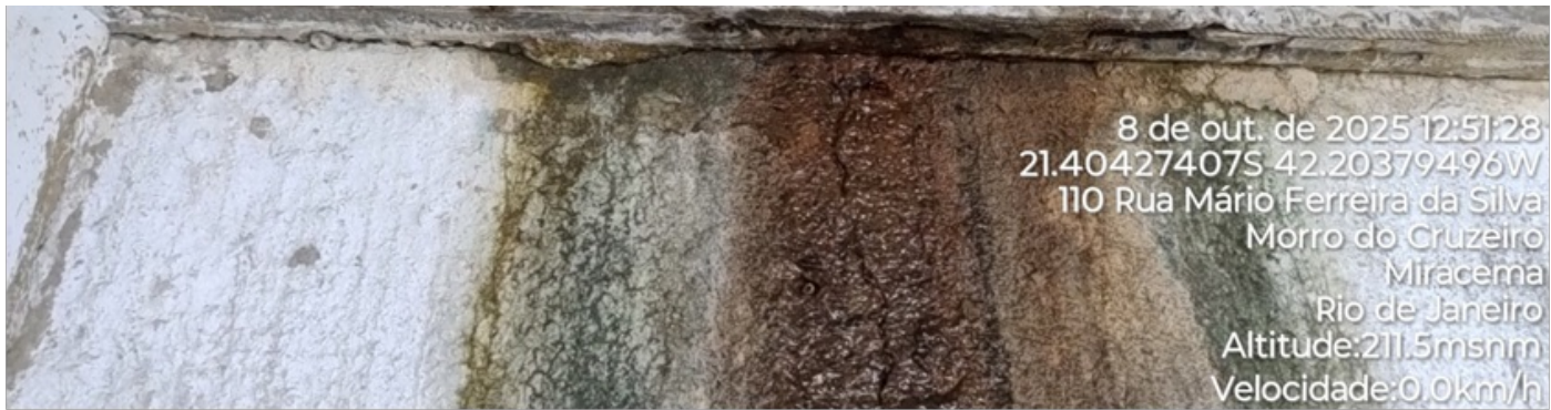
Foto 09: Infiltração na estrutura e armadura da viga exposta.
