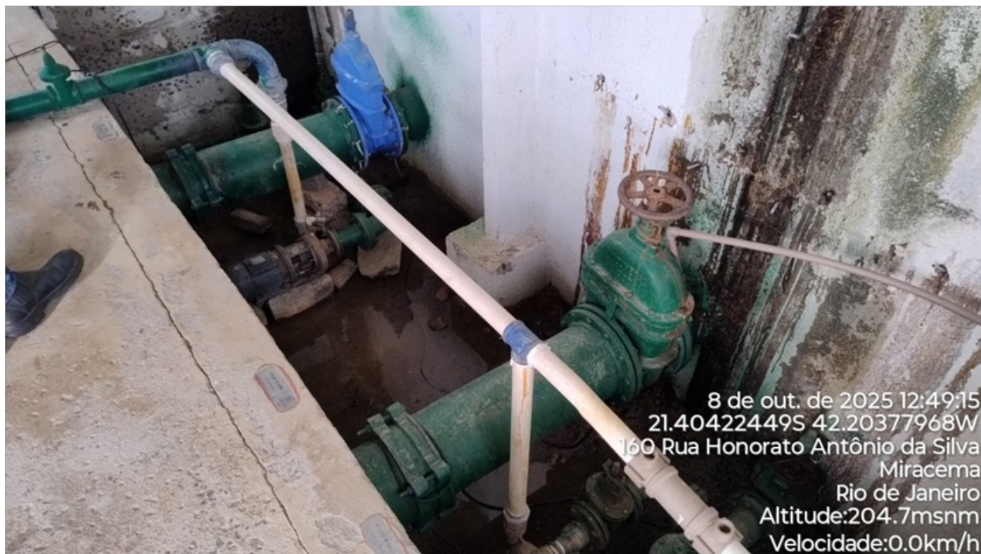
Foto 06: Válvulas de controle e recalque.
