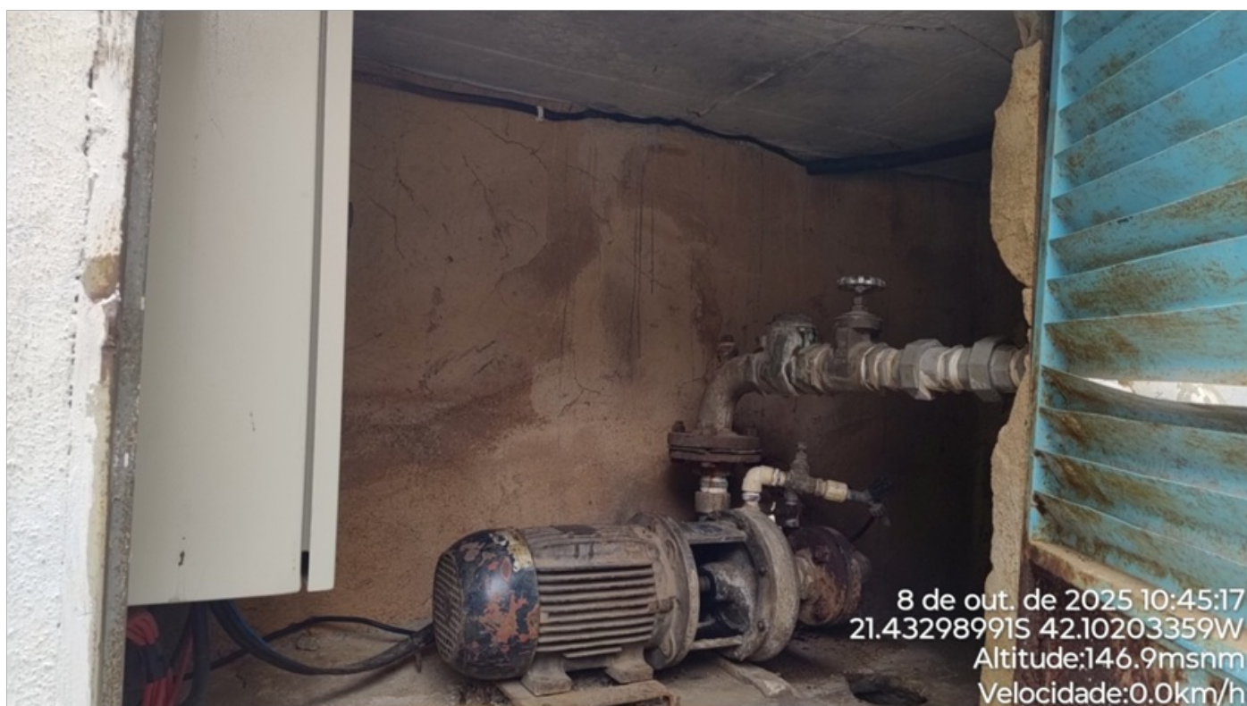
Foto 04 – Painel de comando e bomba da EEAT.
