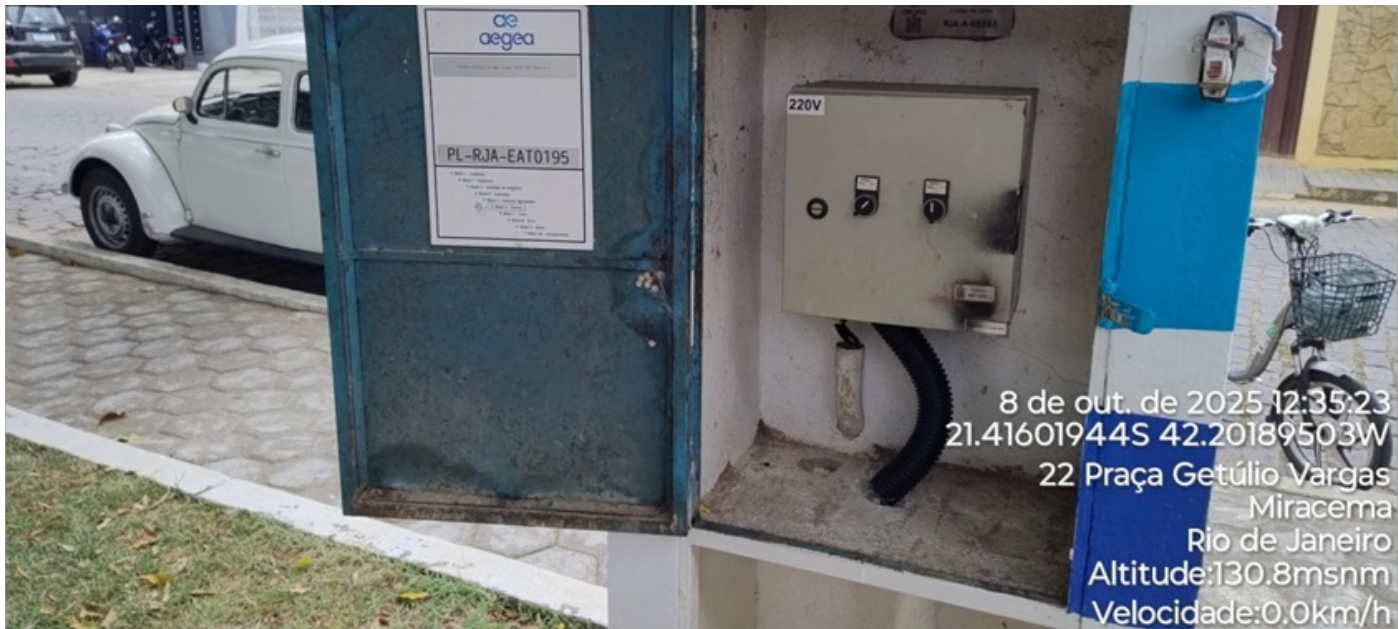
Foto 04 – Painel de comando da EEAT.
