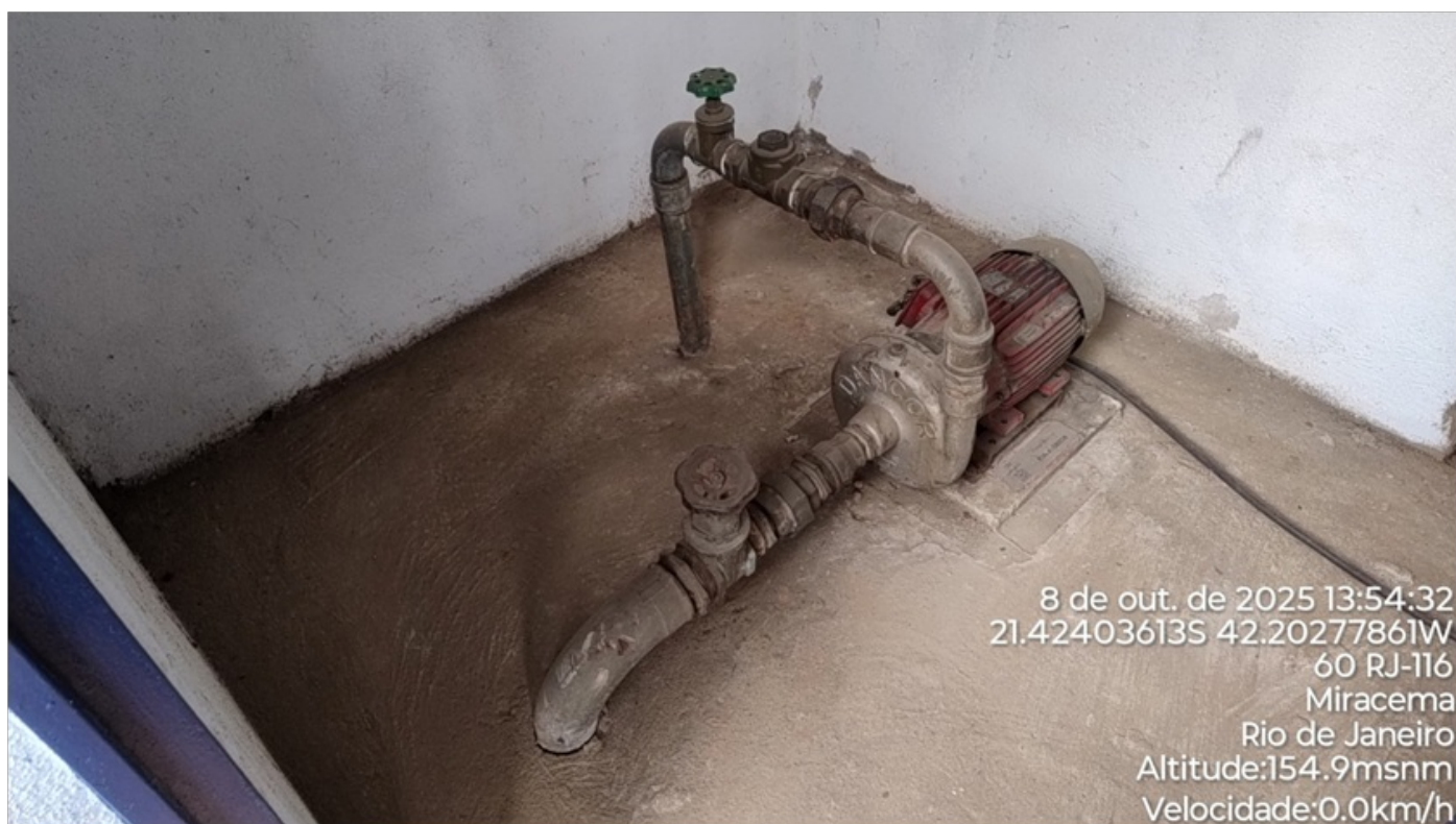
Foto 04 – Bomba da EEAT.
