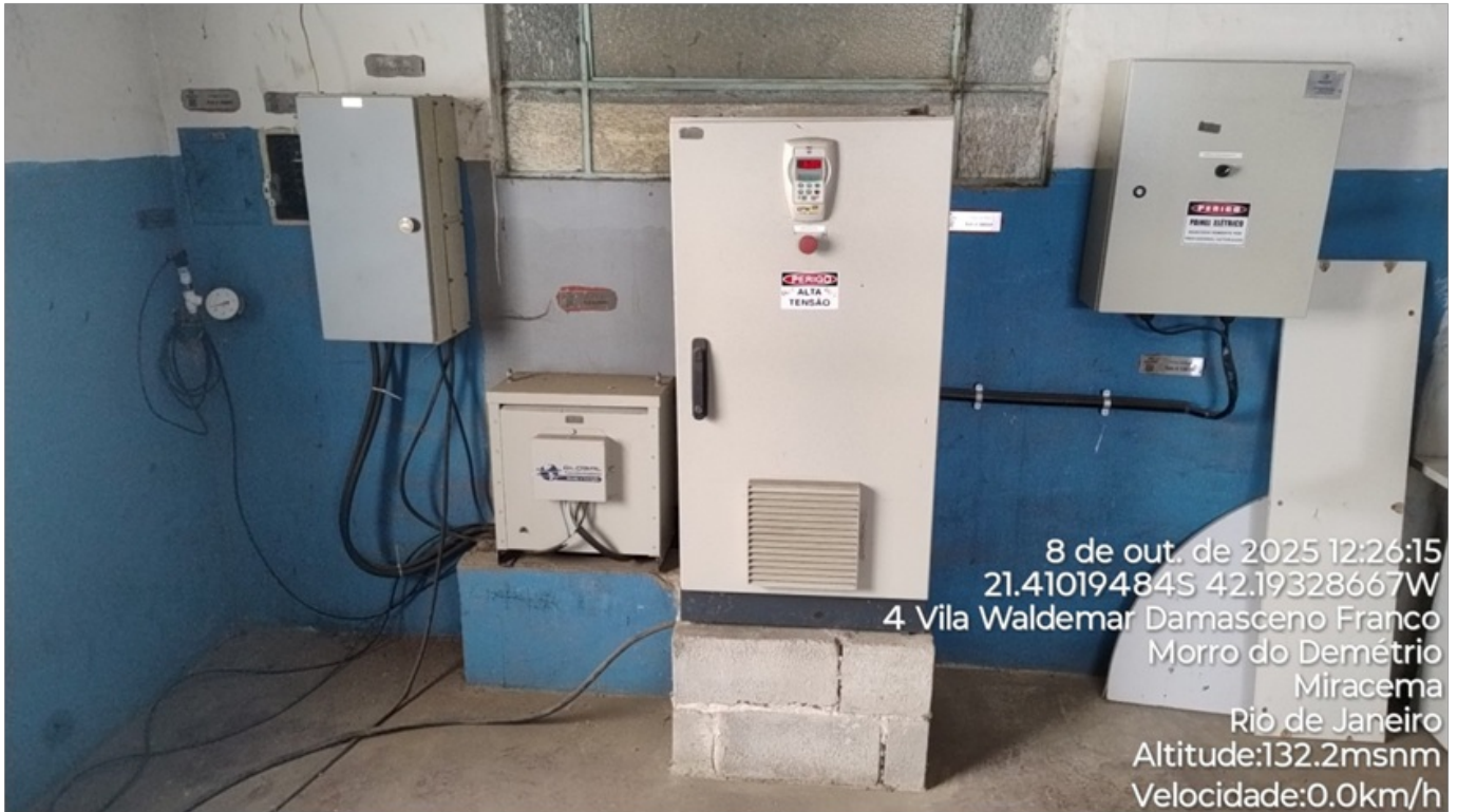
Foto 04 – Painel de comando da EEAT.
