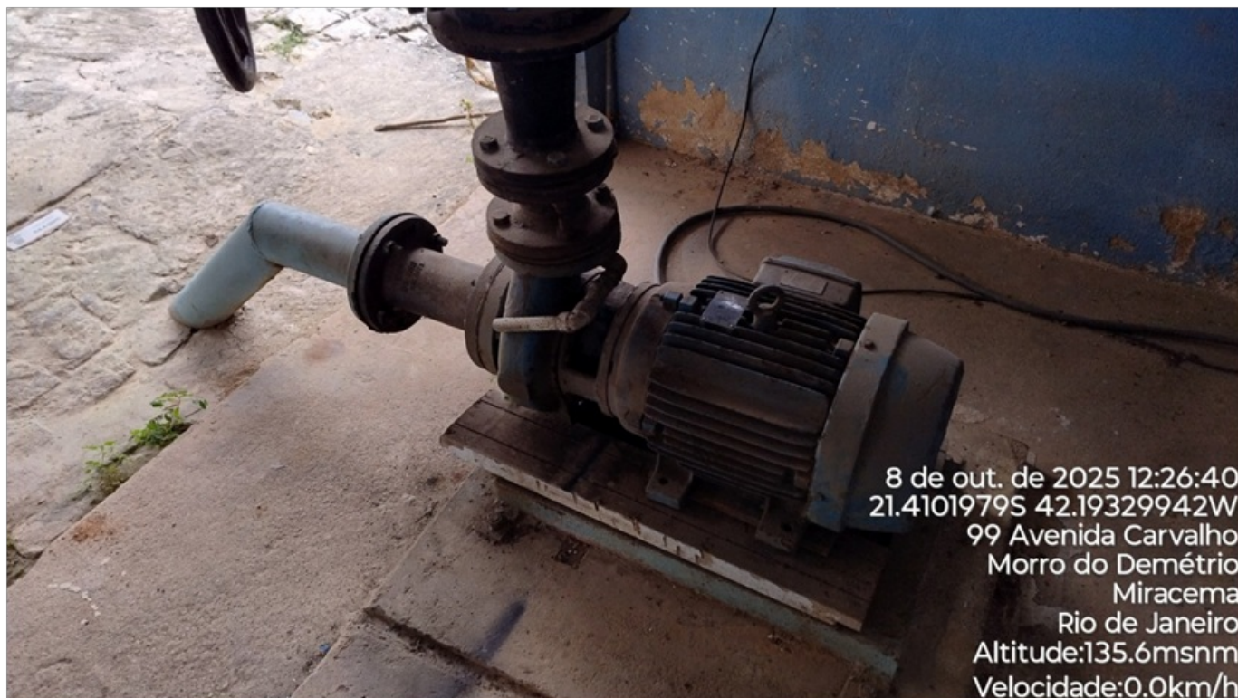
Foto 02 – Conjunto motobomba da EEAT.
