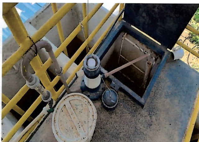
Foto 10: Sistema de cloração com hipoclorito de cálcio.
