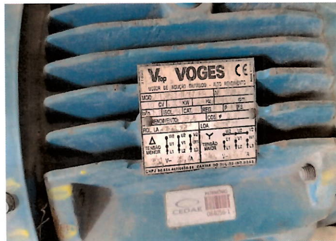
Foto 15: Especificações do conjunto motobomba.
