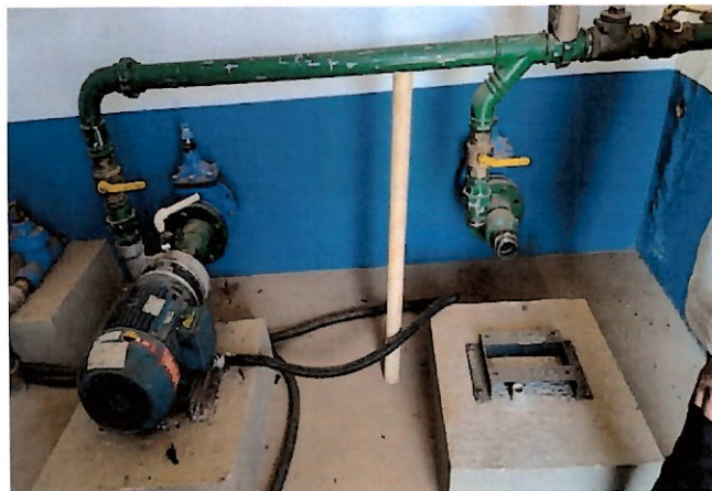
Foto 13: Conjuntos MB com capacidade de 10 CV.
