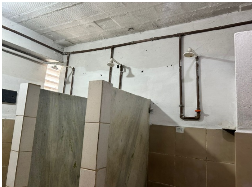
Foto 6. Chuveiro do vestiário.
