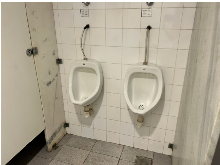
Foto 3. Mictórios do banheiro masculino dos andares de jazigos.
