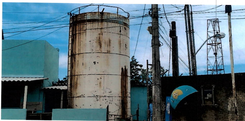
Foto 26: Reservatório com marcas de corrosão.
