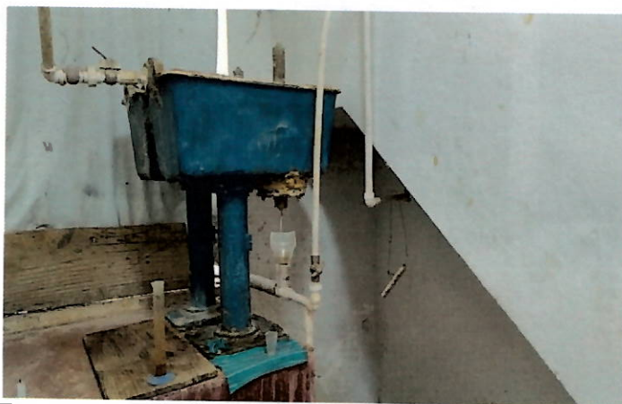
Foto 20: Ponto de dosagem de sulfato de alumínio.
