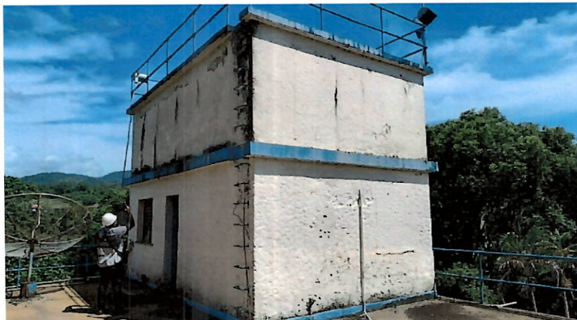
Foto 13: Reservatório de Lavagem dos filtros.
