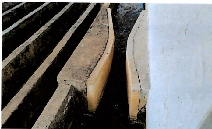
Foto 7: Entrada de água bruta.
