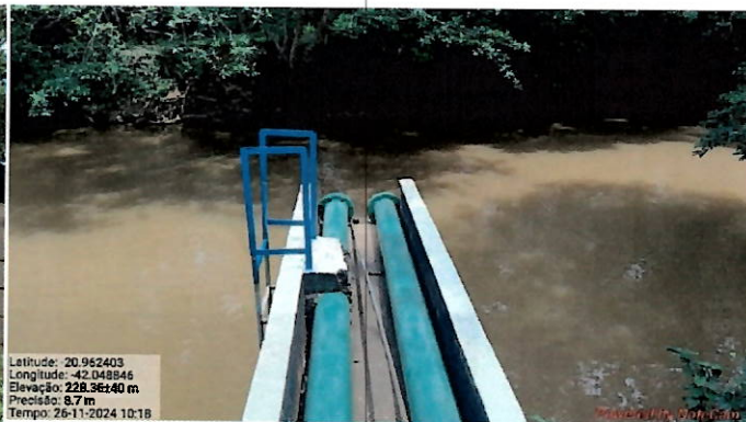
Foto 2: Captação de água bruta no Rio Carangola. Adutora de DN 200.
