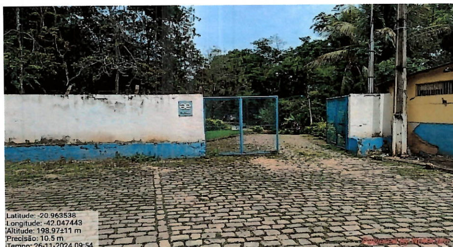
Foto 6: Entrada ETA. Nota-se a ausência da placa de identificação da ETA.
