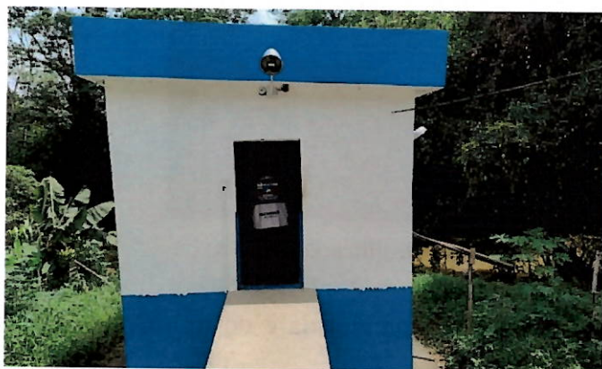
Foto 3: Estação Elevatória de Água Bruta.
