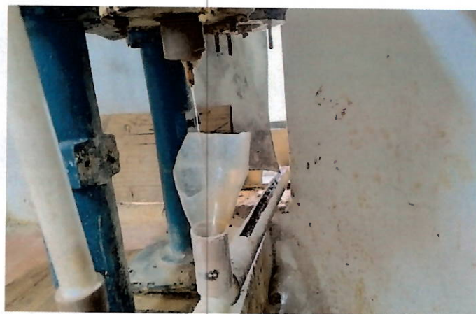
Foto 21: Funil improvisado na dosagem de sulfato de alumínio.
