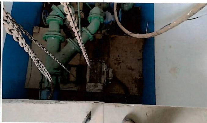
Foto 4: Bomba da Estação elevatória. Capacidade de 100 CV.
