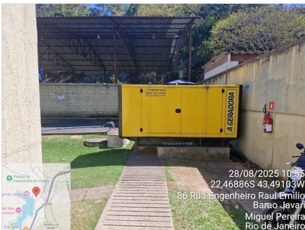
Foto 18 – Gerador de energia
