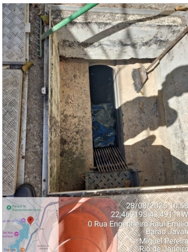
Foto 4 – Gradeamento na chegada do esgoto bruto
