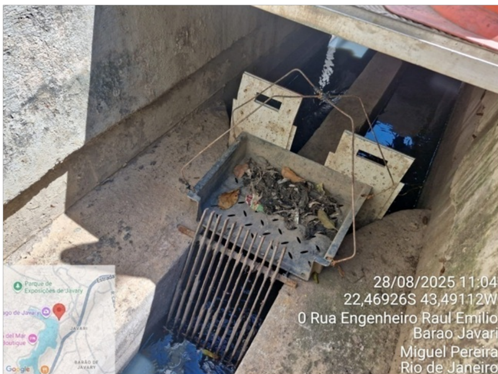
Foto 5 – Gradeamento na chegada do esgoto bruto
