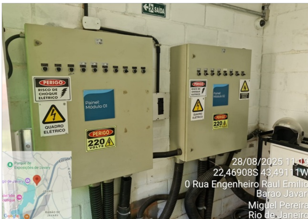
Foto 23 – Painéis elétricos de controle dos dois módulos
