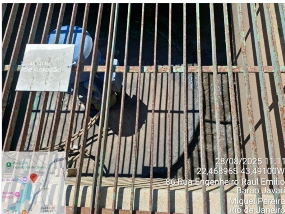
Foto 14 – Tanque de aeração com grade enferrujada
