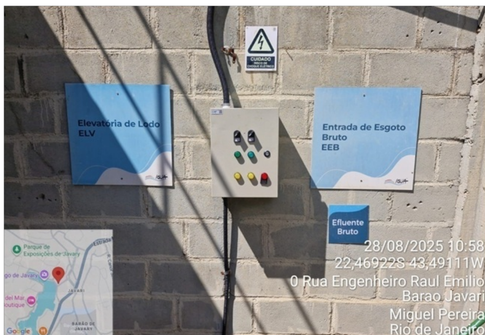
Foto 9 – Painel elétrico das motobombas
