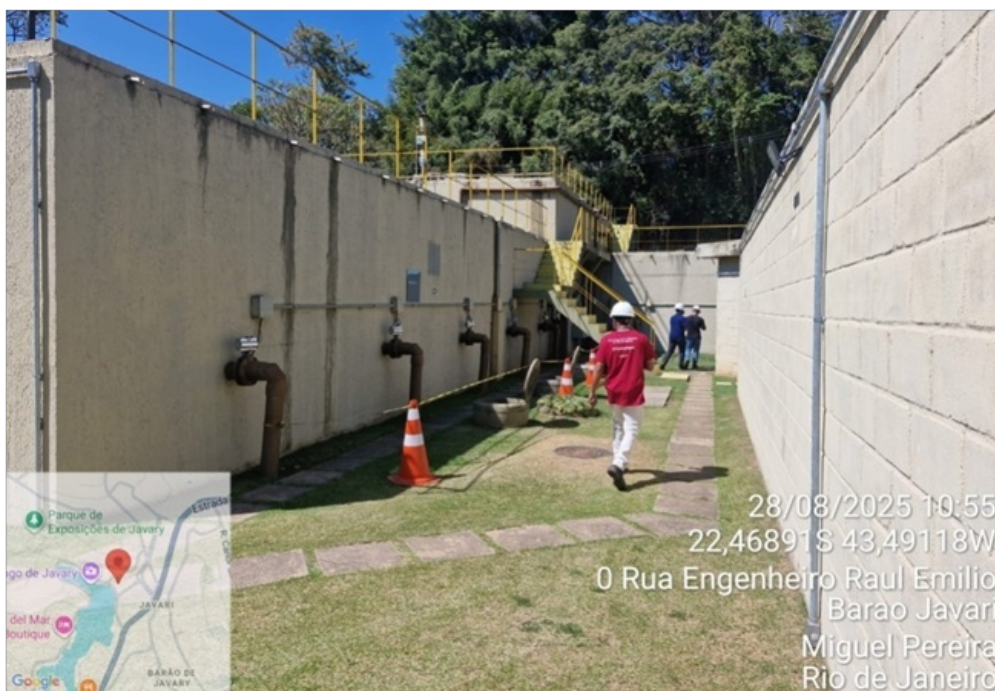
Foto 3 – Vista lateral direita da ETE
