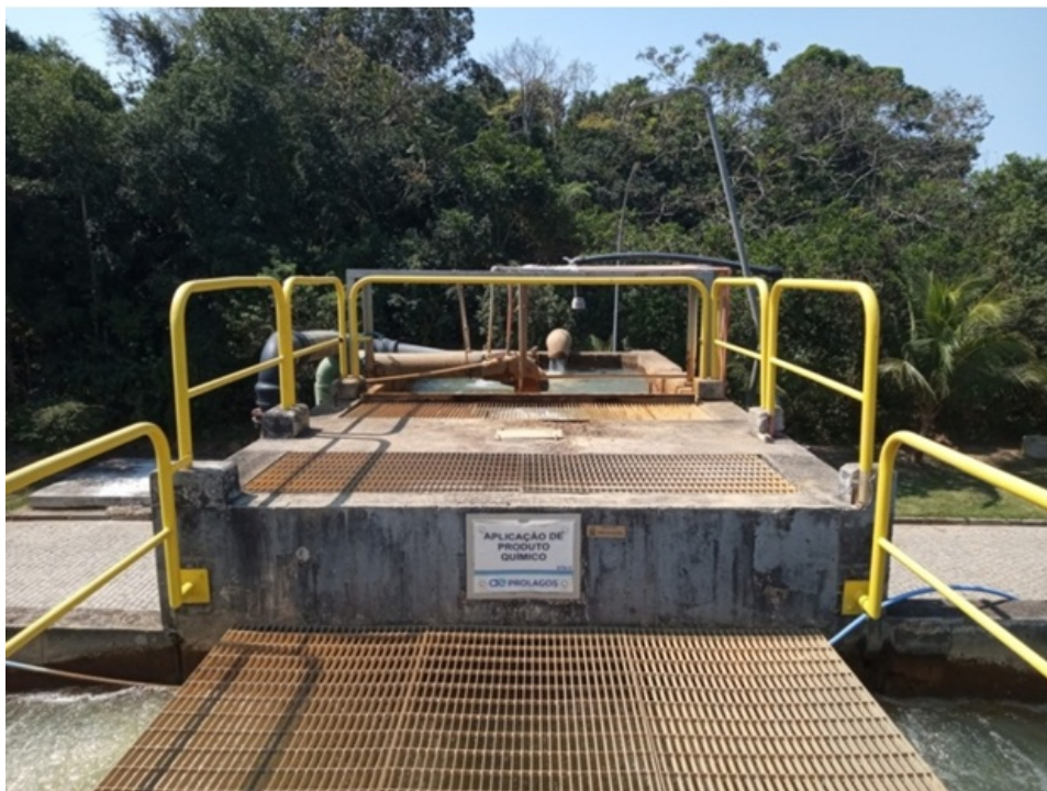
ETA –Aplicação de Produto Químico
