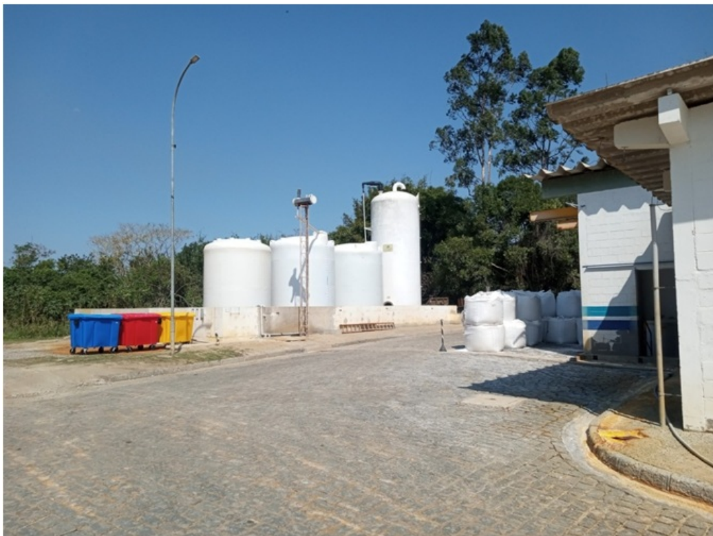
Estoque de Produtos químicos (hipoclorito de sódio)
