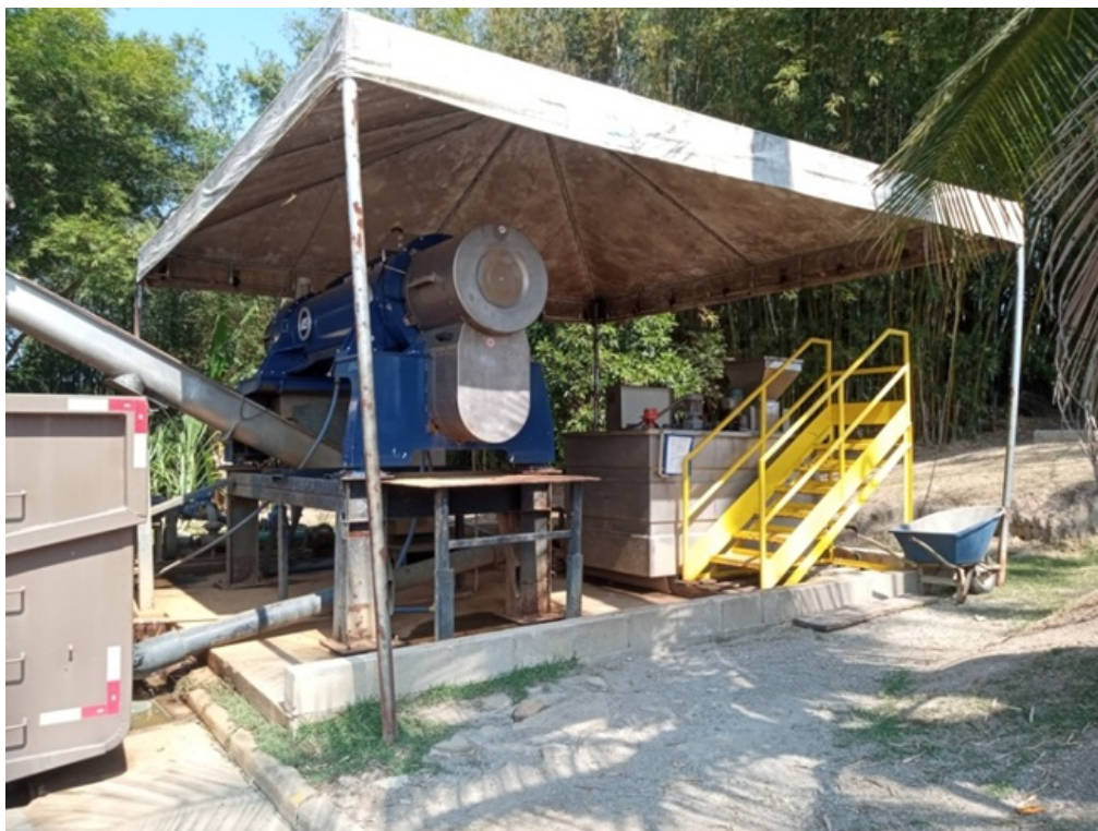
Esteira de transporte de lodo
