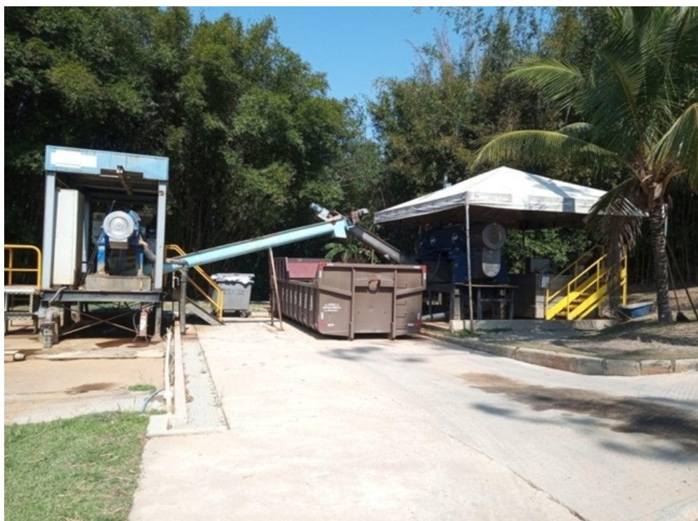
Esteira de transporte de lodo
