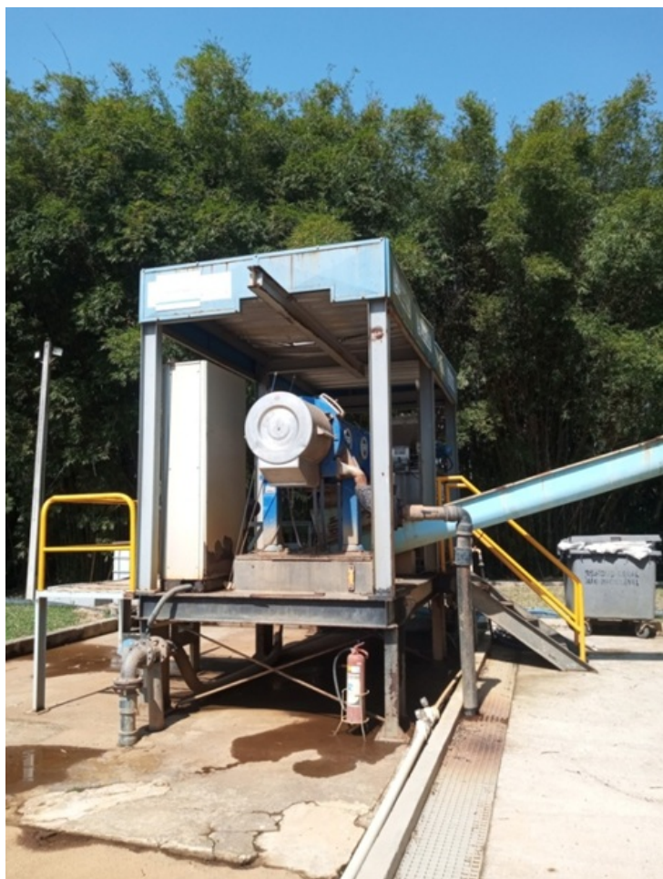
Esteira de transporte de lodo
