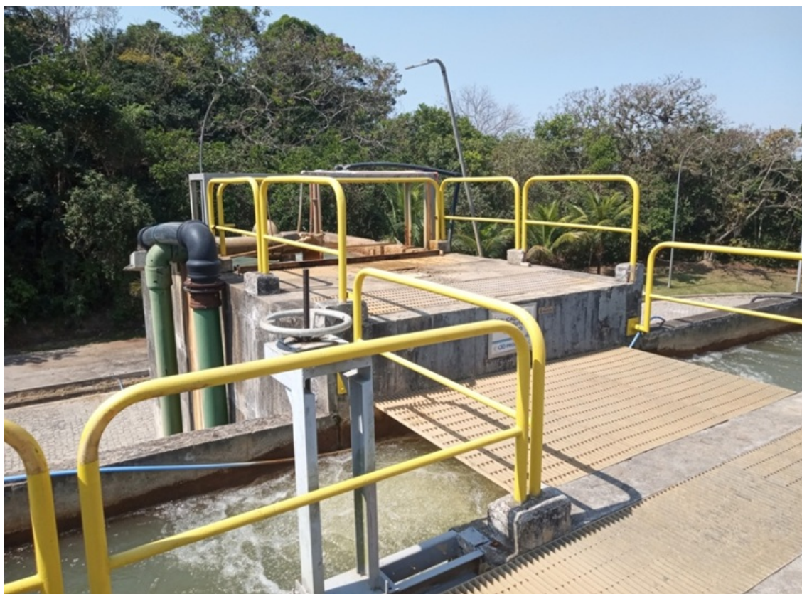
ETA – Aplicação de Produto Químico
