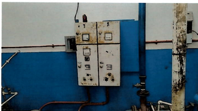
Foto 21: Quadro elétrico das motobombas antigo. Necessidade de substituição para garantir a segurança e eficiência do sistema.
