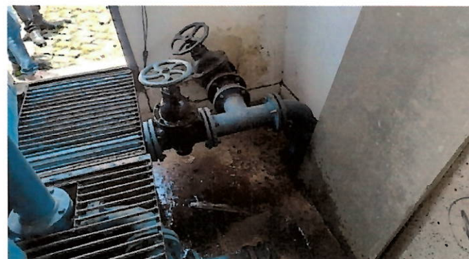
Foto 18: vazamento de água.
