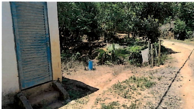
Foto 1: Captação – nota-se a ausência de cercamento adequado e placa de identificação.
