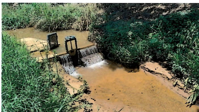
Foto 3: Captação – barragem do córrego.
