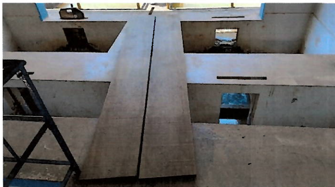
Foto 15: Acesso improvisado sobre os filtros.
