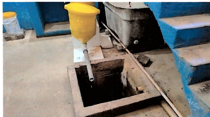
Foto 16: Sistema de cloração com hipoclorito de cálcio (área coberta).
