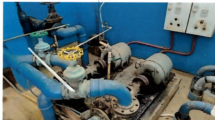
Foto 20: Conjuntos MB utilizados para retrolavagem dos filtros.
