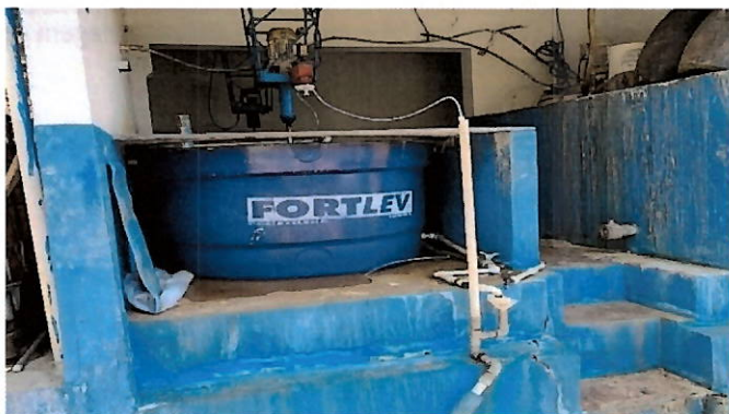
Foto 25: Sulfato de alumínio armazenado sem bacia de contenção.
