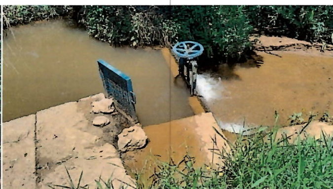
Foto 4: Captação – tomada de água para a ETA.
