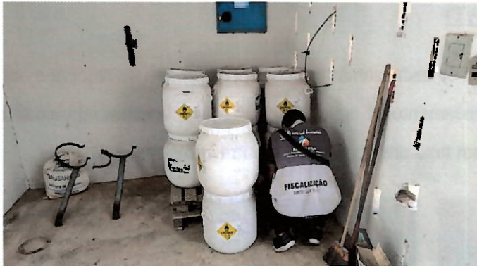
Foto 23: Tanques de armazenamento de produtos químicos sem bacia de contenção.
