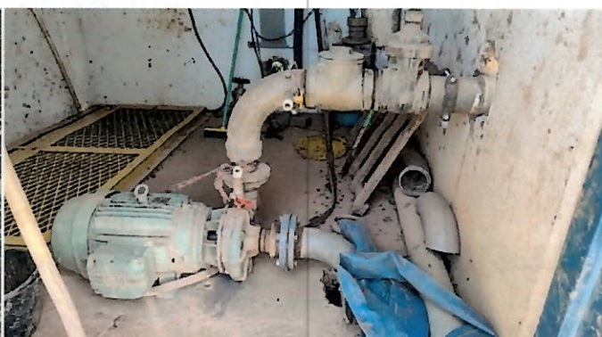
Foto 6: EEAB – conjunto motobomba de 20 cv.
