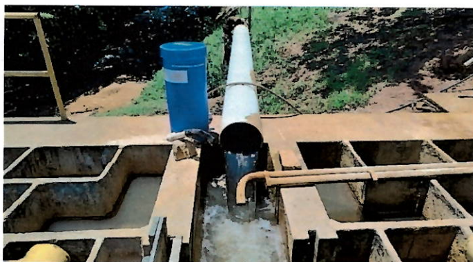
Foto 11: Entrada de água bruta. Nota-se a ausência de medidor de vazão.
