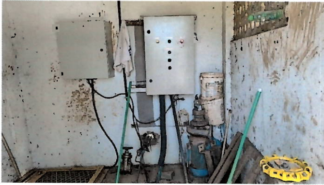
Foto 7: EEAB – quadro elétrico.
