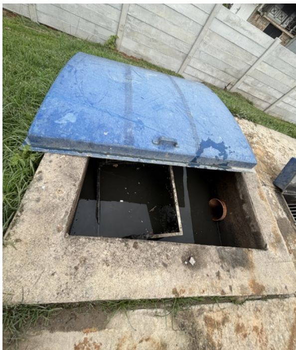
Foto 9 – Chegada do esgoto
