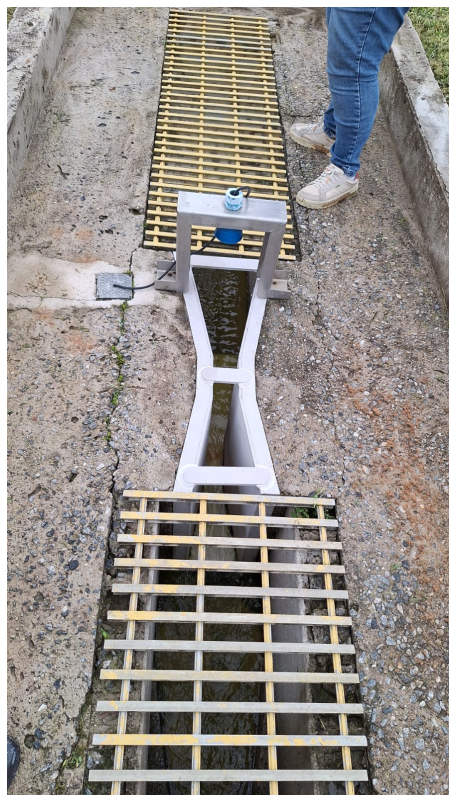
Foto 23 – Calha Parshall (com sensor de nível) na saída do efluente
