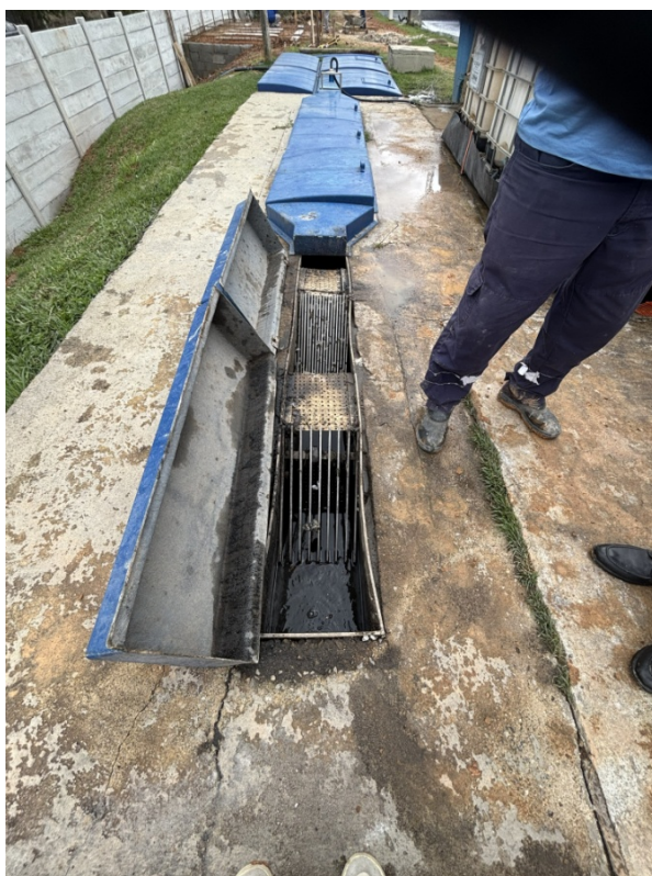
Foto 10 – Gradeamento grosso e fino
