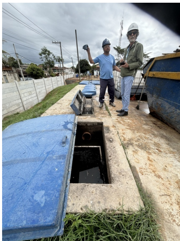
Foto 8 – Estruturas de tratamento preliminar (Chegada do esgoto, gradeamento, desarenador, medição e retenção de gordura)
