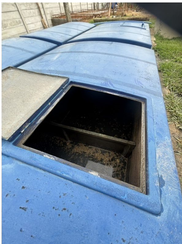
Foto 14 – Caixa de retenção de gorduras
