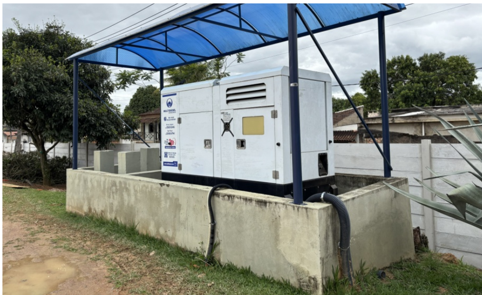
Foto 15 – Gerador de energia disponível
