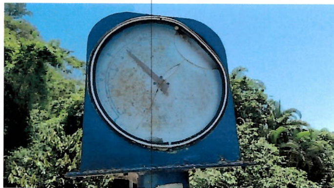
Foto 9: medidor de vazão em funcionamento.
