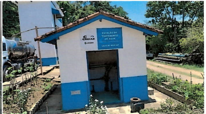
Foto 6: Placa de identificação da ETA.
