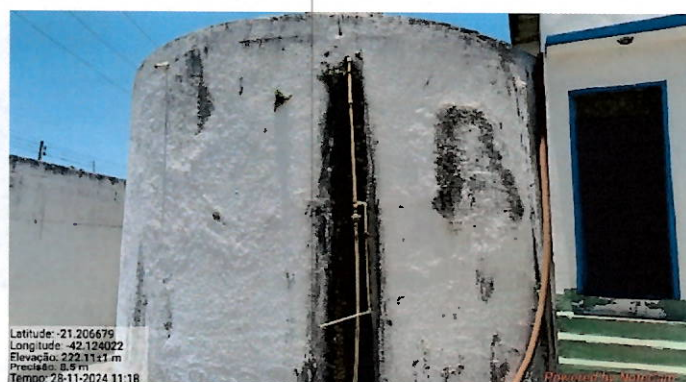
Foto 24: Reservatório com infiltrações na estrutura.
