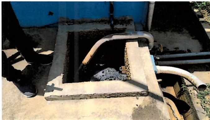
Foto 14: Ausência de tampa estaque sobre o tanque de contato.
