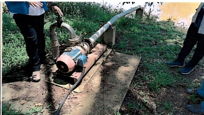
Foto 2: Captação – bomba de 15 cv utilizada quando o nível do rio está baixo.
