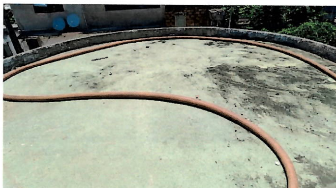
Foto 25: Ausência de guarda-corpo na parte superior.
