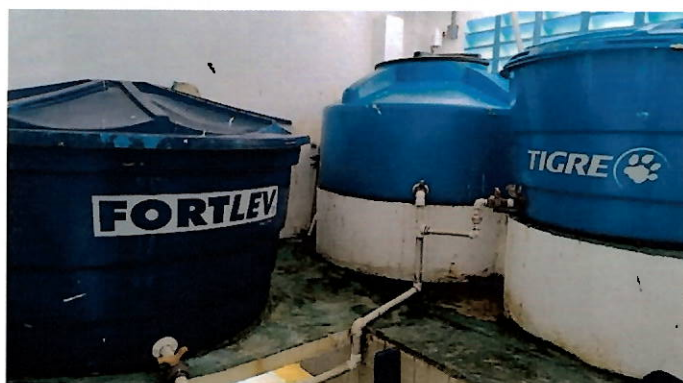
Foto 19: Tanques de sulfato de alumínio sem bacia de contenção.
