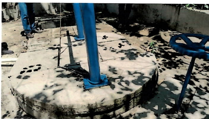
Foto 3: Captação – poço utilizado quando o nível do rio aumenta.
