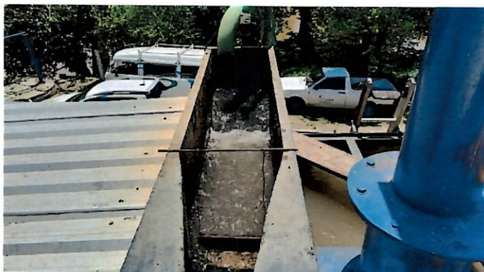
Foto 8: Entrada de água bruta.
