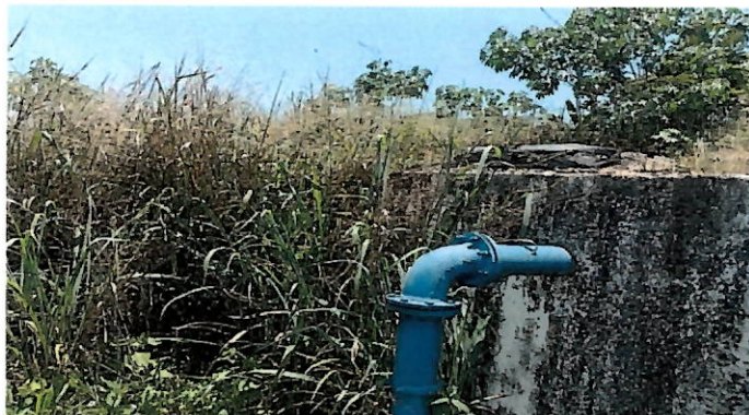
Foto 28: necessidade de limpeza do terreno (remoção de vegetação).
