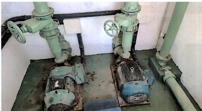
Foto 15: Conjuntos MB utilizados para abastecimento.
