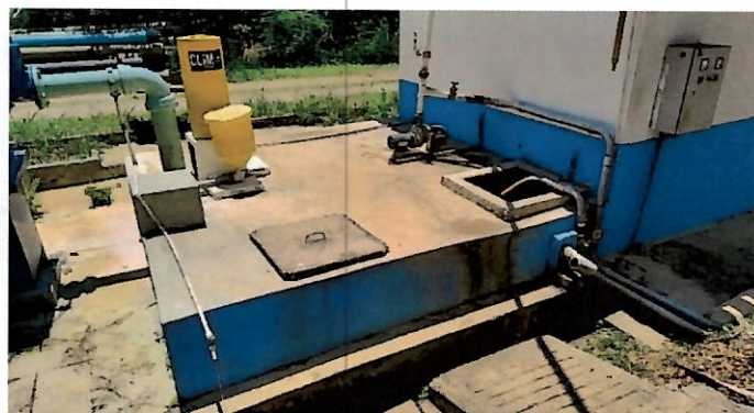
Foto 13: Sistema de cloração com hipoclorito de cálcio sobre tanque de contato.
