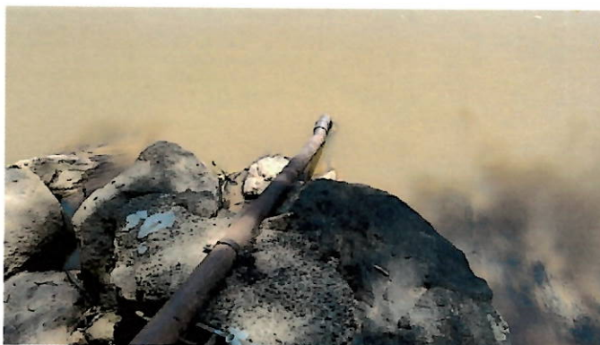
Foto 1: Captação no Rio Muriaé.
