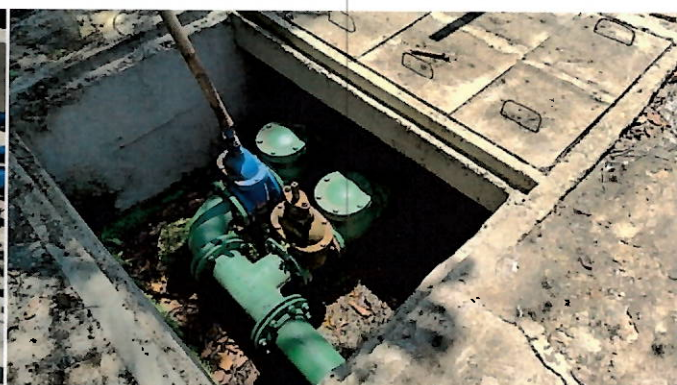
Foto 4: Captação – sistema do poço com bomba submersível de 15 cv.
