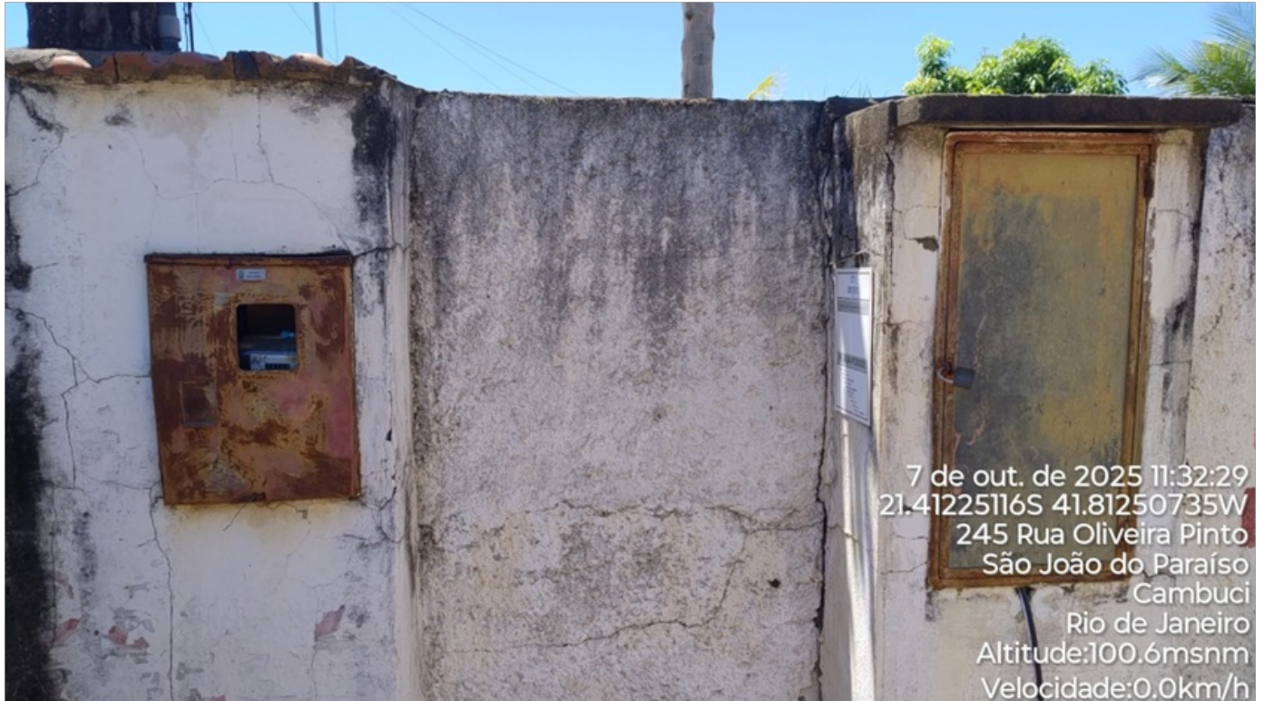
Foto 02: Placa de identificação interna do bem reversível, medidor de energia elétrica e painel de comando do PCO.
