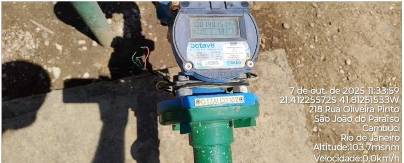
Foto 04: Hidrômetro do PCO.
