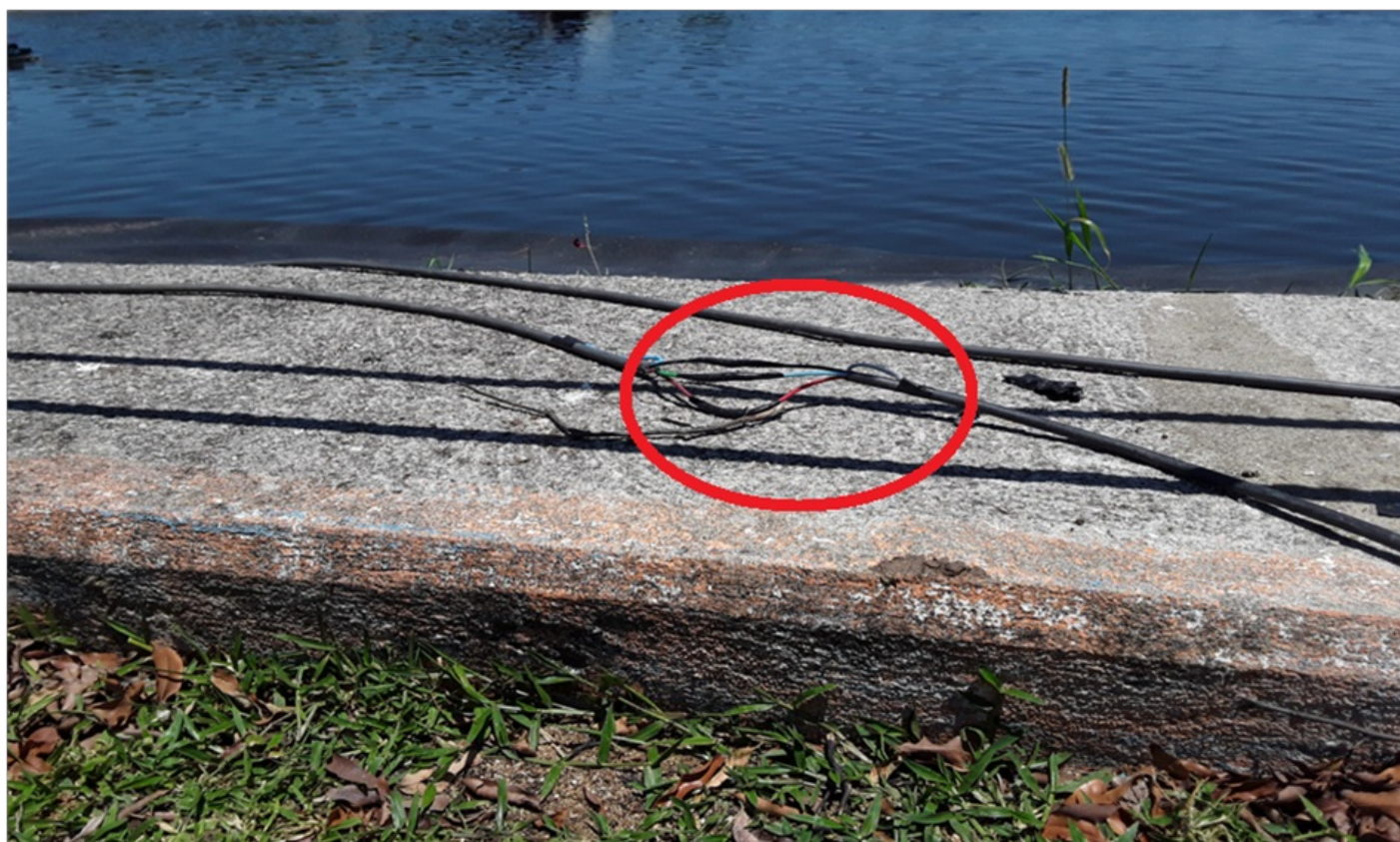
Foto 10 - Instalações elétricas em desconformidade com a NR 10
