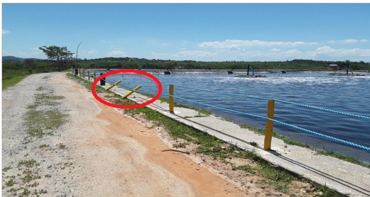
Foto 8 - Cerca de proteção quebrada
