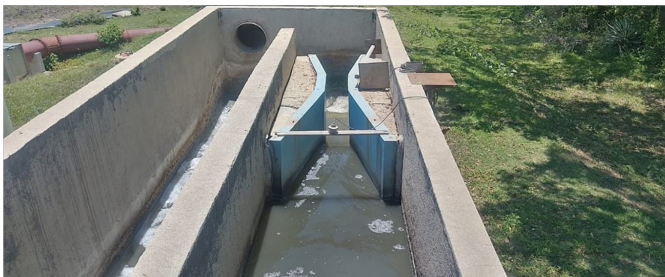
Foto 4 – Medidor de vazão tipo calha Parshall
