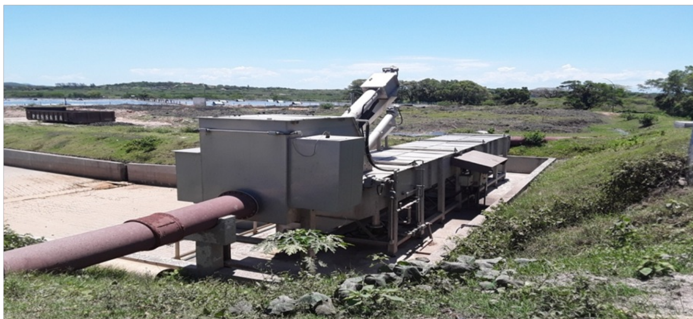
Foto 6 - Tratamento preliminar ( fora de carga ): sistema compacto mecanizado com limpeza mecanizada
