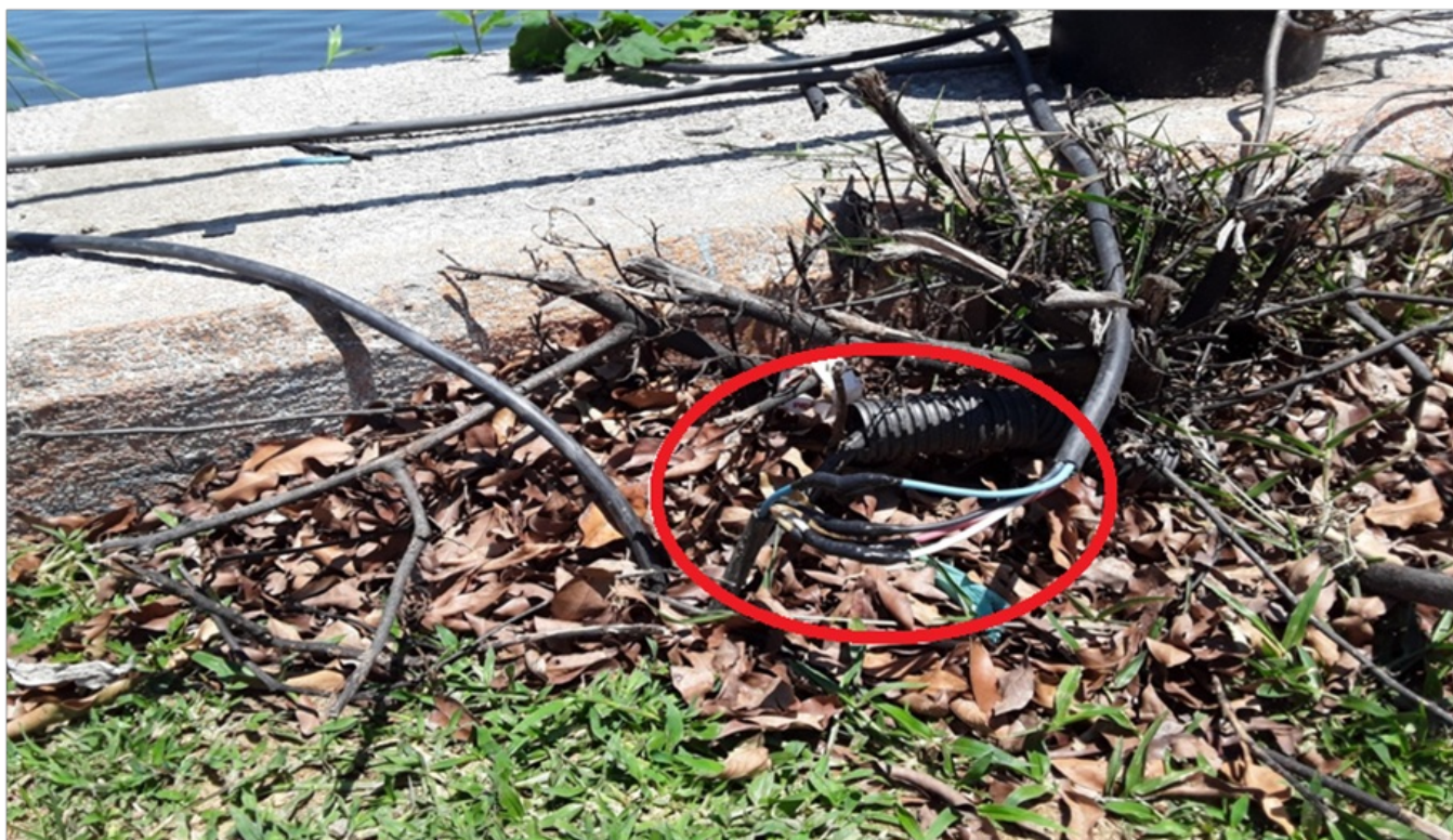
Foto 9 - Instalações elétricas em desconformidade com a NR 10 / NBR 5410
