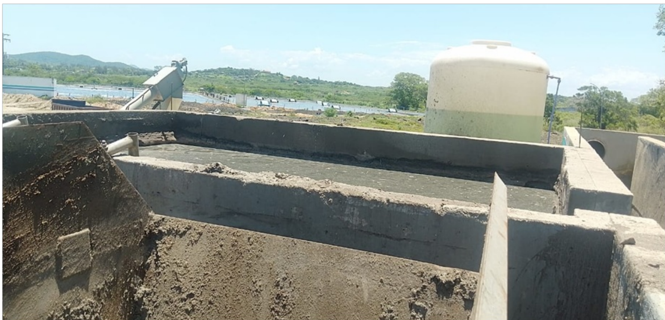
Foto 5 - Tanque de recebimento dos caminhões limpa fossa
