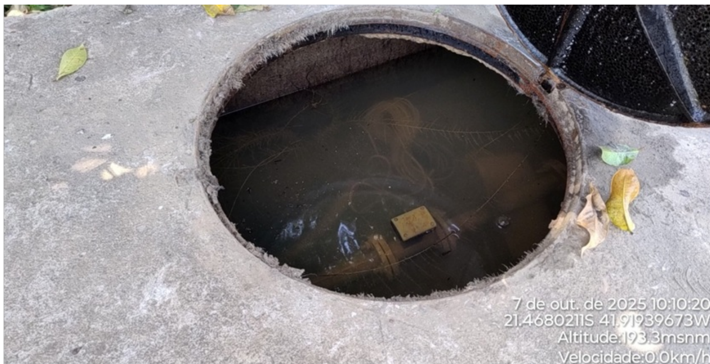
Foto 08: Abrigo do macromedidor com um vazamento na tubulação.
