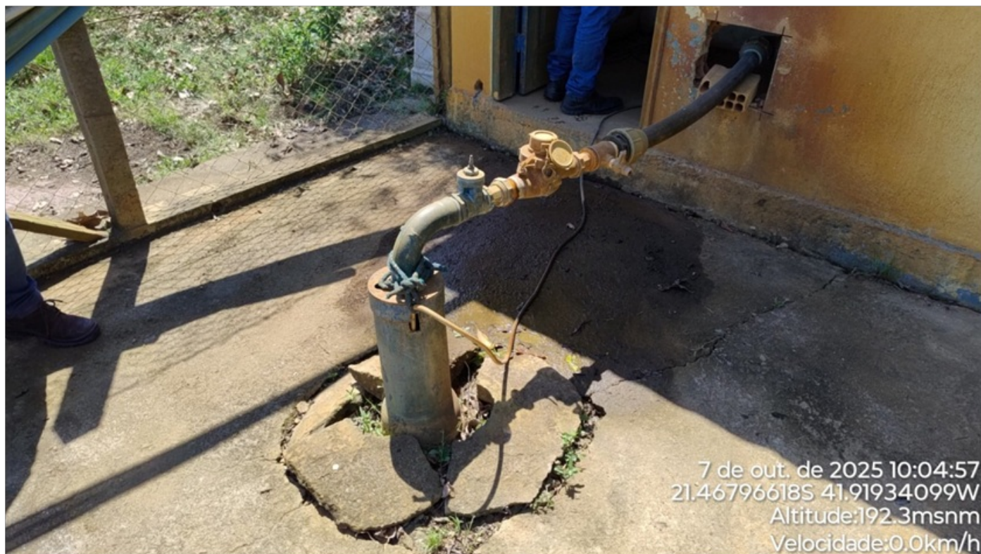
Foto 07: Barrilete do poço.
