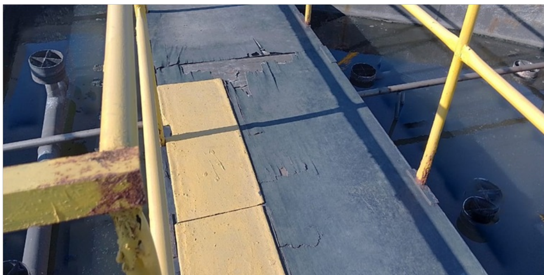
Foto 9 – Piso de passagem cedendo, alto risco de acidentes
