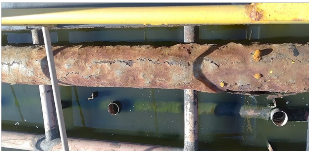
Foto 8 - Tubulação em estado de conservação inadequada
