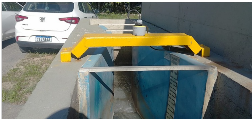
Foto 3 - Calha Parshall com medidor de vazão ultrassônico
