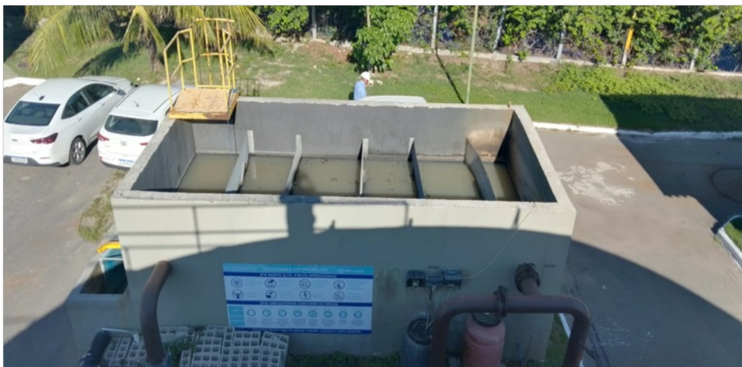
Foto 10 – Tanque de Contato
