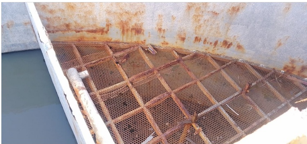
Foto 7 – Sinais de corrosão
