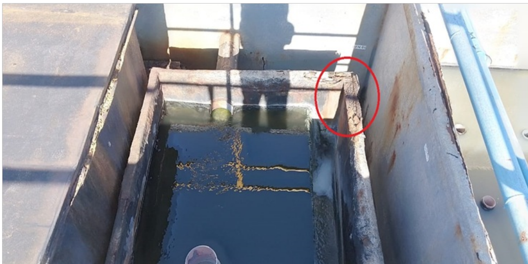
Foto 6 – Sinais de má conservação em algumas estruturas
